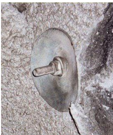
Figur28 Eksempel på B4 Deformasjon (Foto: A. Neby)
