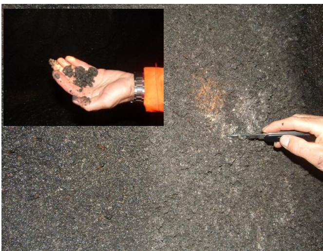
Figur19 Eksempel på S9 (nedbrytning). Tykk fuktig gipsutfelling på undersjøisk betong. Merk at fargen ligner på betong. Freifjordtunnelen. (Foto: P. Hagelia)
