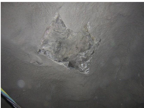
Figur14 Eksempel på S5 Avskalling (Foto: T. Humstad)
