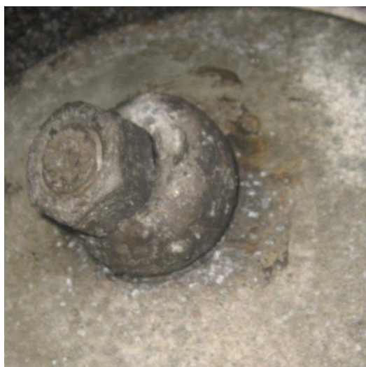
Figur20 Eksempel på B1, rustgrad A. (Godøytunnelen) (Foto: Region sør)
