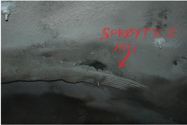
Figur 29 Eksempel på M1 Ikke utført bergsikring. (Foto: A. Neby)
