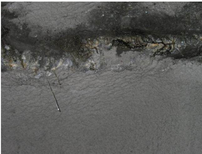
Figur10 Eksempel på S2. Riss med kalkutfelling. (Foto: P. Hagelia)
