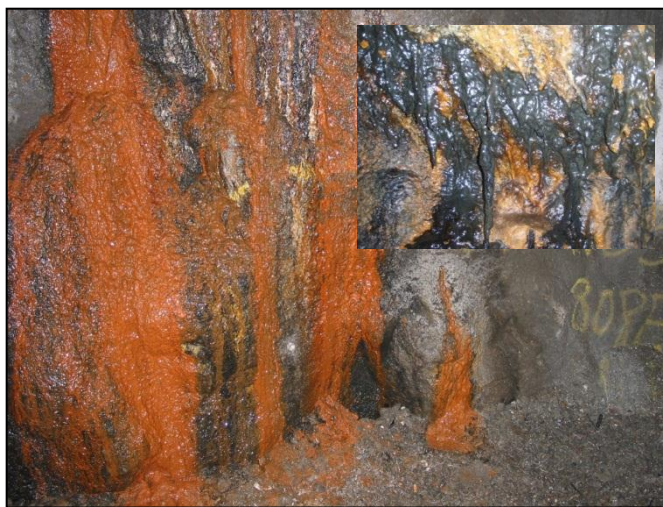
Figur18 Eksempel på S9 i undersjøisk tunnel. Innfelt foto viser sterk grad av utlutning i ytterste 3 - 4 cm betong, Oslofjordtunnelen (Foto: P. Hagelia)
