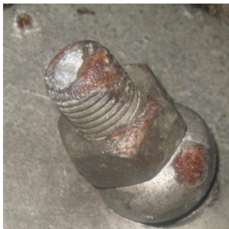
Figur 21 Eksempel på B1, rustgrad B (Foto: Region sør)
