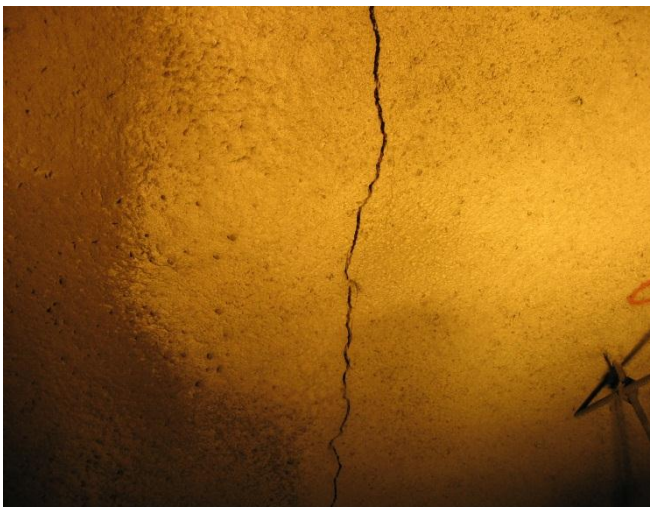
Figur11 Eksempel på S3 Sprekker. Baneheia (Foto: Region sør)
