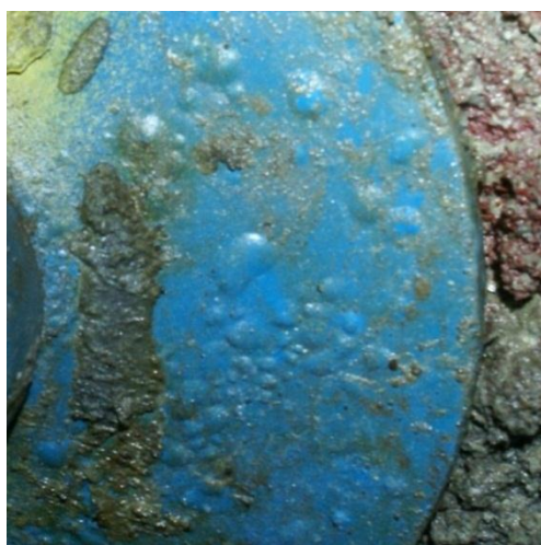
Figur 22 Eksempel på B1, rustgrad B (Foto: Region sør)
