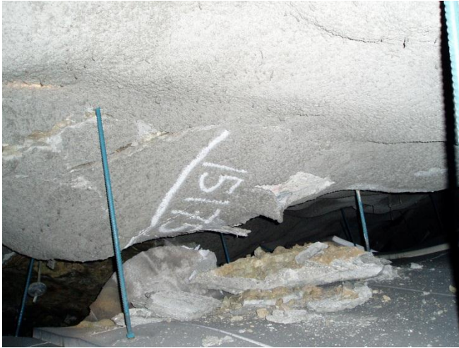
Figur9 Eksempel på S1. Nedfall av sprøytebetong. (Foto: E. Iversen)
