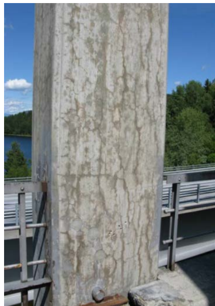
Figur 11 Nautesund bru. Opprissing pga alkalireaksjoner. Foto: Eva Rodum, Statens vegvesen
