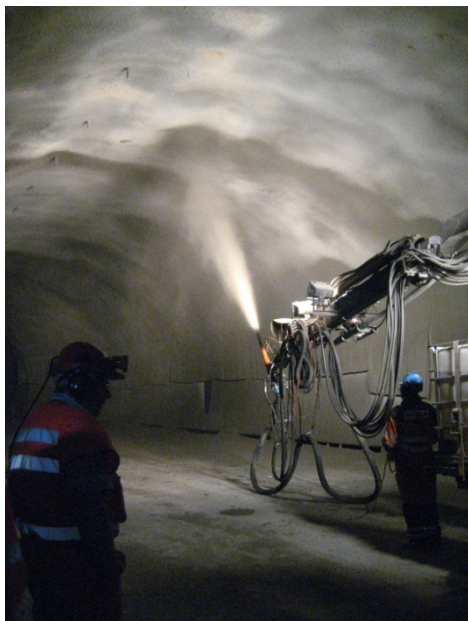
Figur 16 Påføring av sprøytebetong ved nybygging, her brannsikring av PE-skum i vann- og frostsikringshvelv
