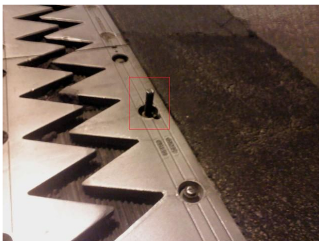
Figur 22 Oppstikkende bolt fra fuge. Foto: Nina Utne, Statens vegvesen.
