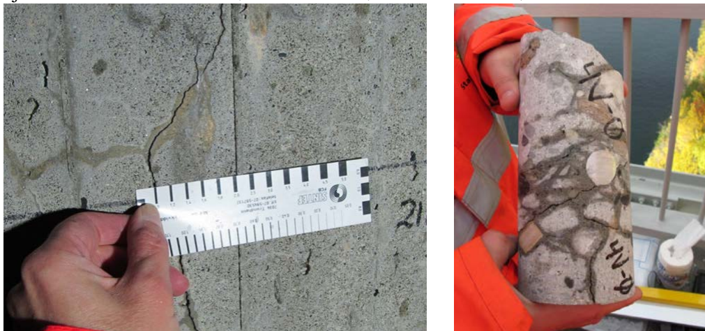
Figur 12 Feltundersøkelser Folda bru. Til venstre: Måling av rissvidder i felt. Til høyre: Utboret kjerne med kraftig intern opprissing. Foto: Eva Rodum, Statens vegvesen.
