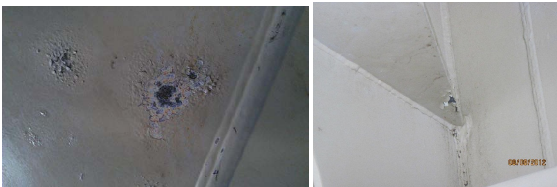
Figur 13: Nordhordlandsbrua, avflassing av maling og korrosjonsprodukter. Til venstre: sannsynligvis utvikling av rust fra pin-holes. Foto: Ketil Engen, Statens vegvesen.
