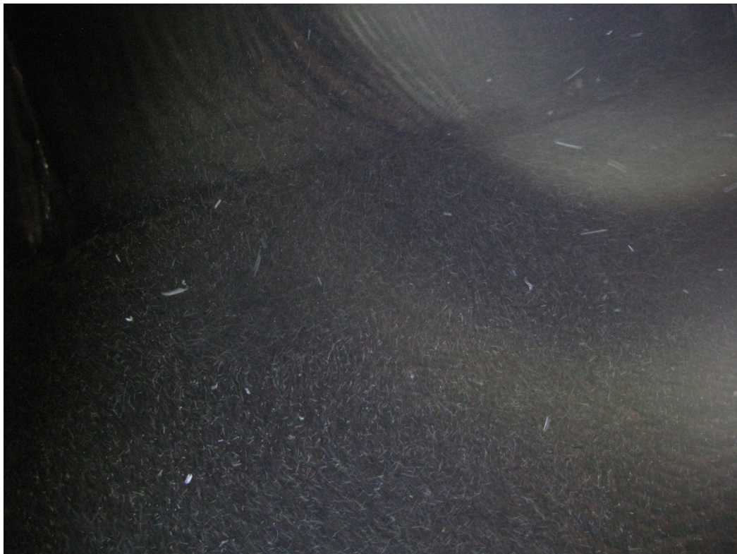
Figur 7: Under sprøyting av betong med brannsikringsfibre inneholder luften løse partikler som stammer fra pp-fibre. Partiklene er svært små og legger seg som et støvlag på tilgjengelige flater. Øverste bilde viser at partiklene er så små at de for øyet oppfattes som støv. Underste bilde viser at det er stor tetthet av fibre i luften (Foto: Odd Andre Rustad, Multiconsult, 2013)
