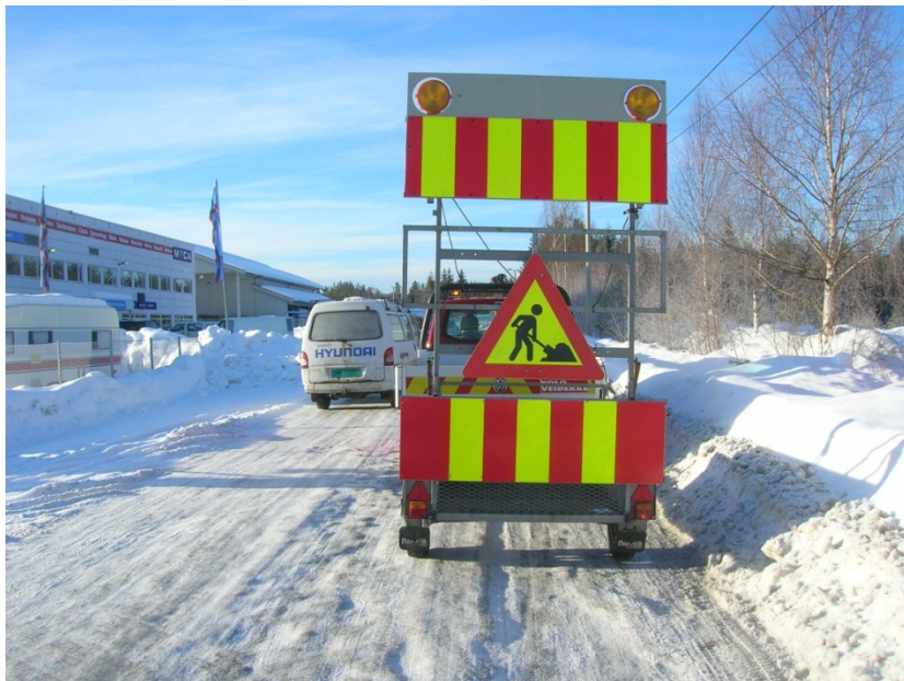
Figur 2-8 Arbeidsvarsling må gjennomføres etter retningslinjene
