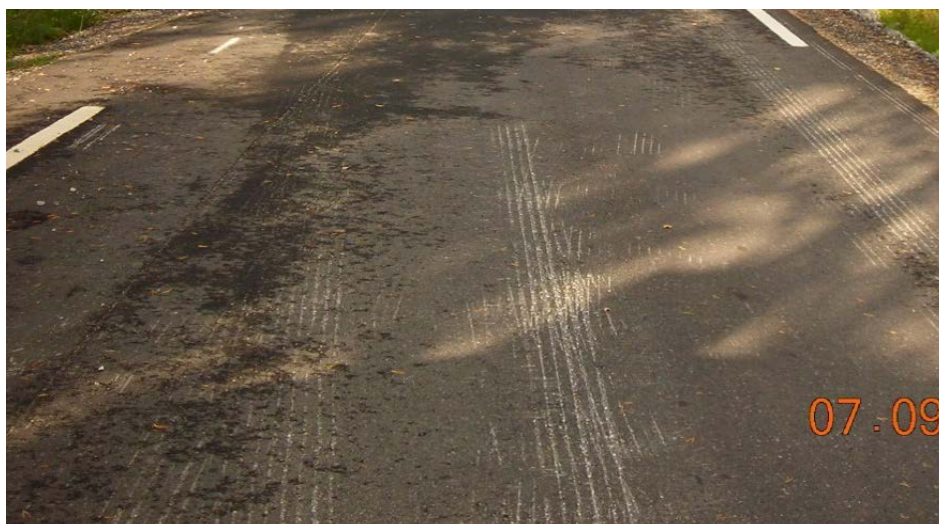
Figur 7-33 Skader på fast dekke etter bruk av System 2000
