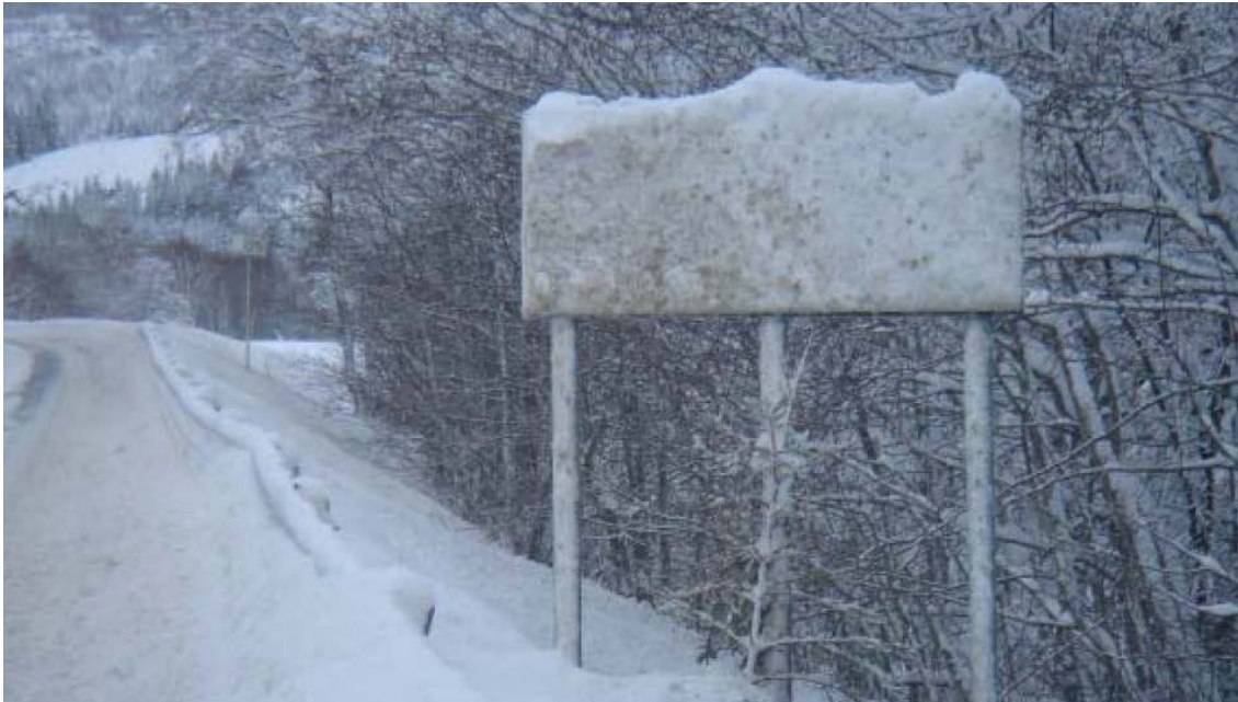
Figur 4-52 Nedsprutet trafikkskilt (kilde: SINTEF)
