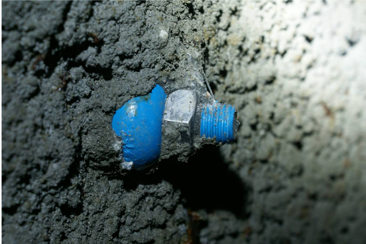
Figur 1.1-5 Ukorrodert bolt, men med noen vabler i den dobbelte korrosjonsbeskyttelsen. Synlige deler mekanisk rengjort for sprøytebetong.
