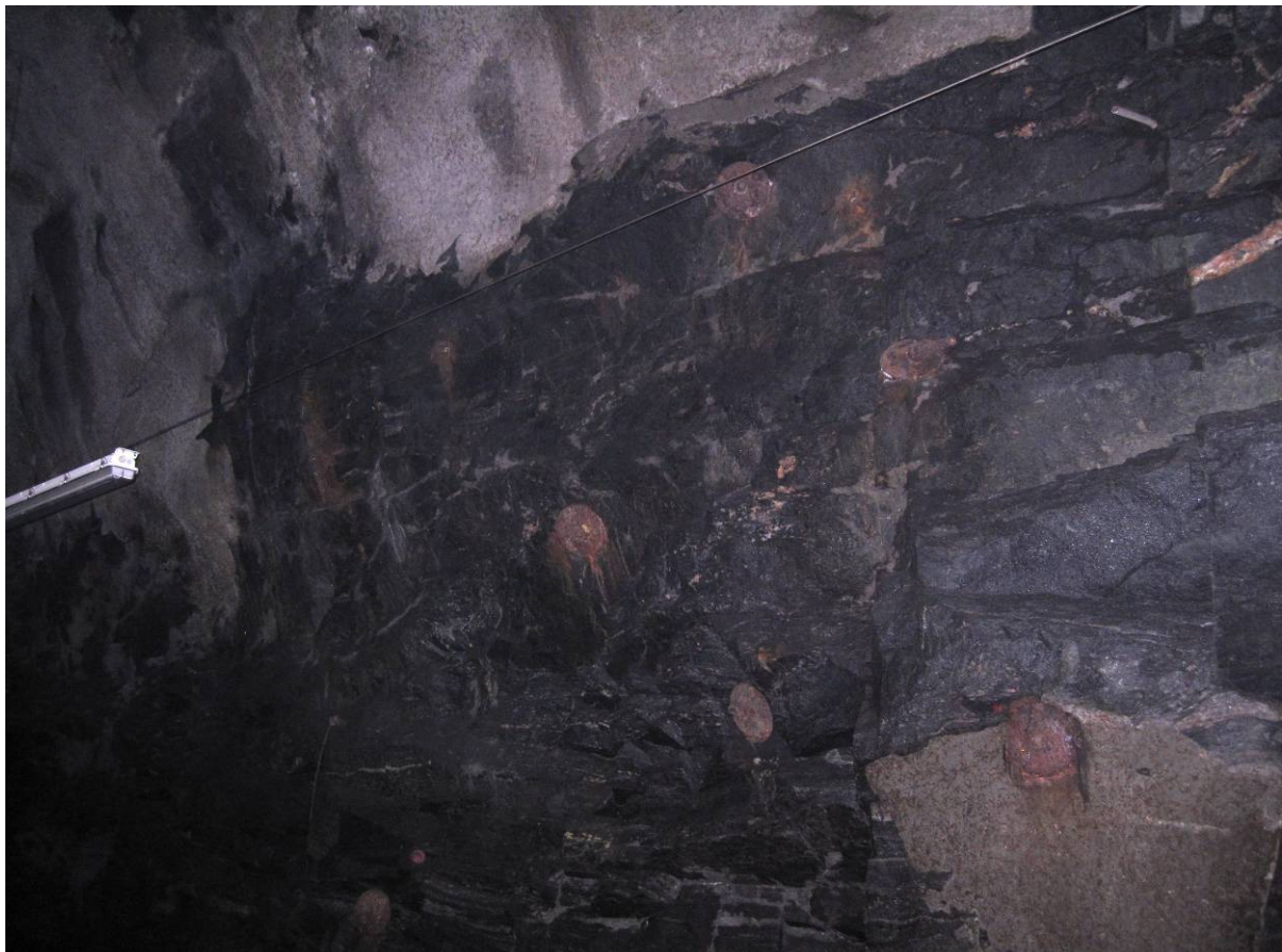
Figur 1.4-2 Sterkt korroderte bolter i høyre vegg. Rørbolter med skive og fullt innstøpte uten skive
