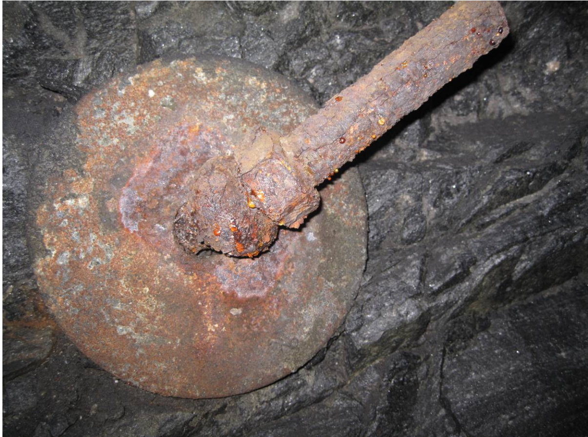
Figur 1.4-19 Bolt 5. Innerst i pumpestasjon – nærmest vannbasseng. Mindre korrosjon på skive enn på andre bolter i tunnelen. Vært vurdert (og rengjort) tidligere?
