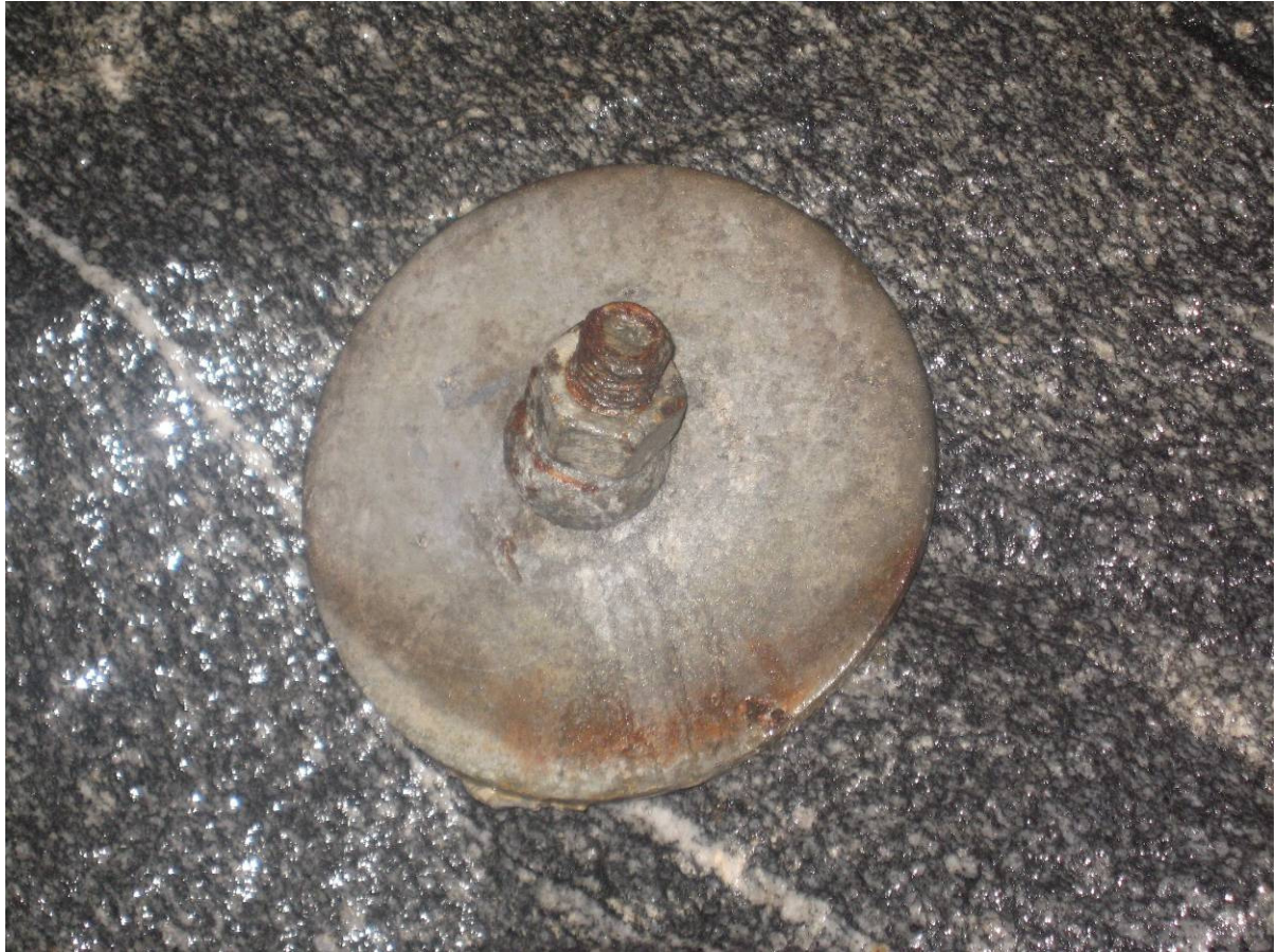
Figur 1.6-19 Korrosjon på bolteende og halvkule, og misfarging på bolteplate
