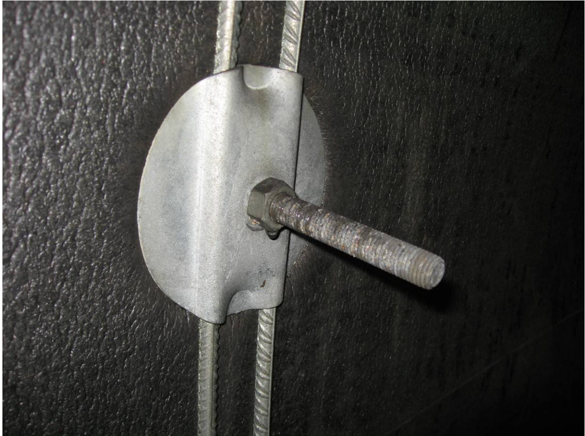
Figur 1.3-7 Lite korrosjon å se på festemateriell for vann og frostsikring, selv ved fukt og drypp på stålet.
