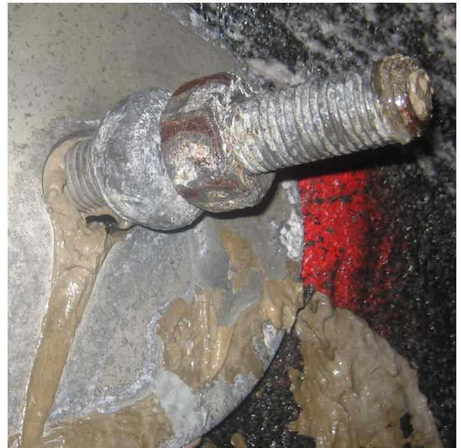
Figur 12 Korrosjon på bolteende rørbolt og på gripekanter til mutter (Godøytunnelen)
