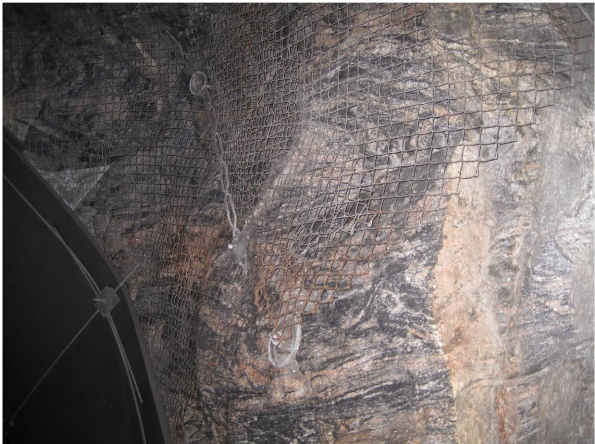
Figur 1.7-12 Korrodert flettverksnett nært inntil vannsikring
