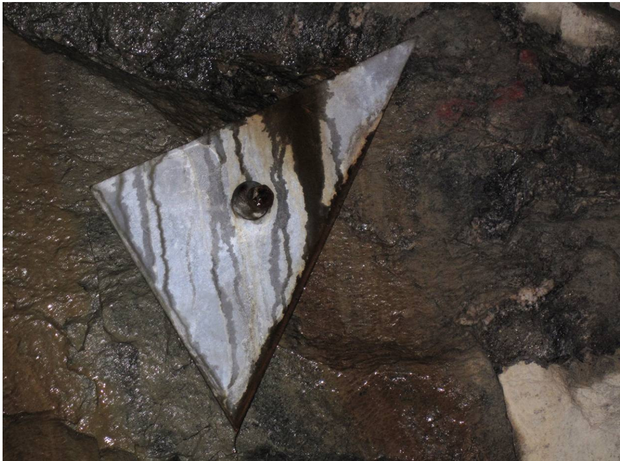
Figur 1.8-6 Eneste bolt med misfarging som skyldes overfladisk korrosjon. Vått, rennende vann fra sleppe
