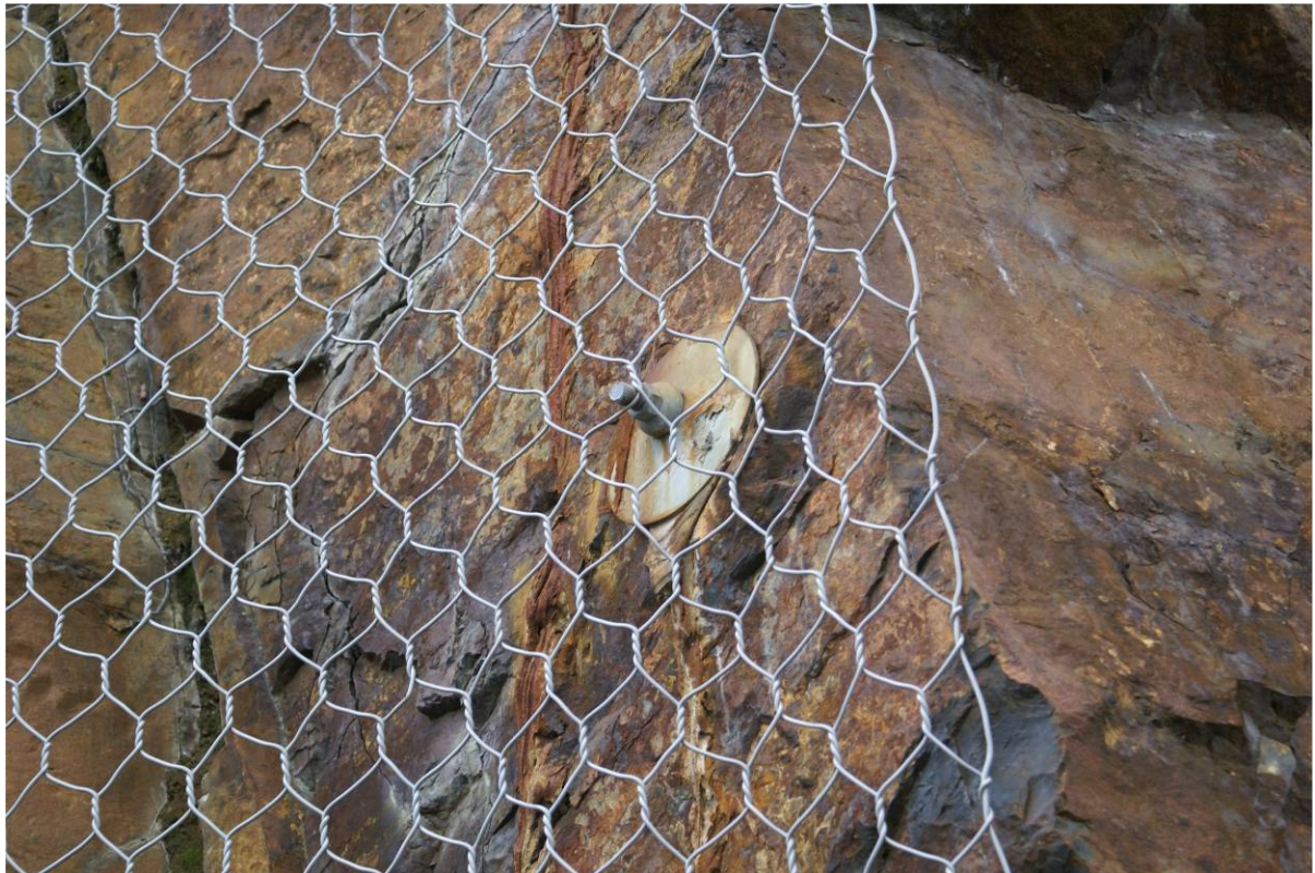
Figur 2.1-5 Berg med rustutfelling og korrodert/misfarget bolteskive
