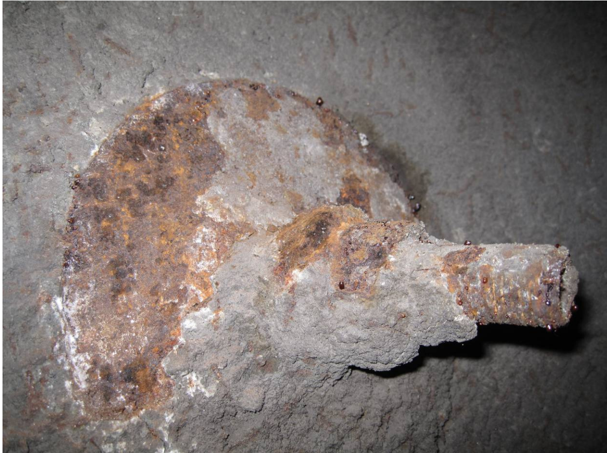
Figur 1.5-5 Bolt 2. Etter fjerning av sprøytebetong med geologhammer
