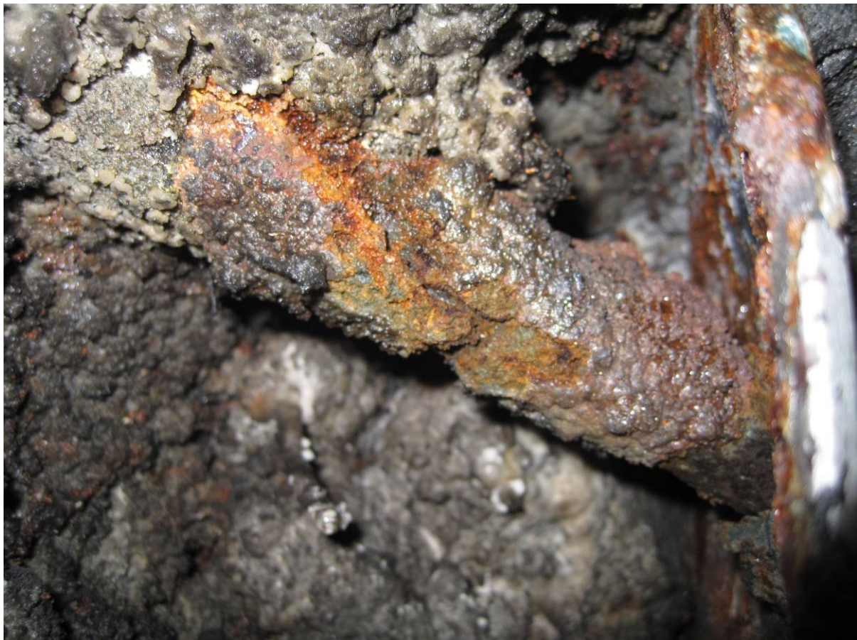
Figur 1.5-26 Bolt på innsiden av plate – kraftig angrepet av korrosjon
