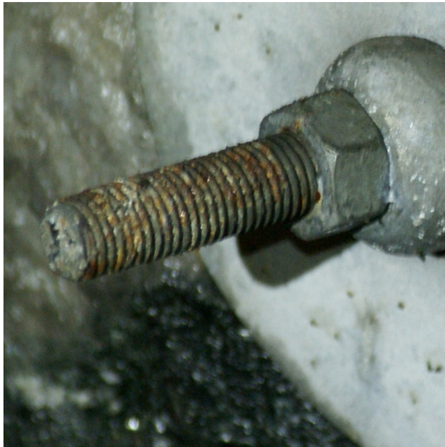
Figur 5 Korrosjon på gjenger. Dekker ikke hele bolteenden (Svartdalstunnelen)
