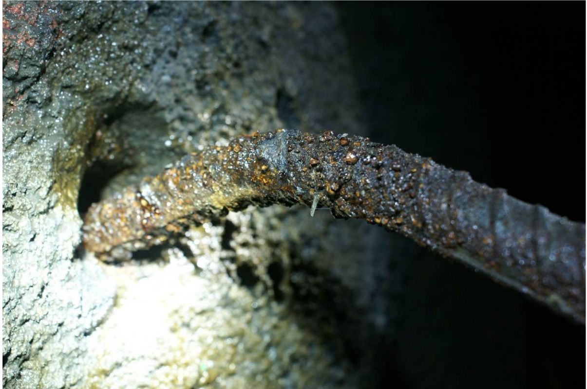
Figur 1.2-11 Korrodert kamstålbolt benyttet for oppheng, står ca. 1 m ut av boltehullet. Mange vanndråper på overflaten av stålet. Antatt ingen korrosjonsbeskyttelse på kamstålet.
