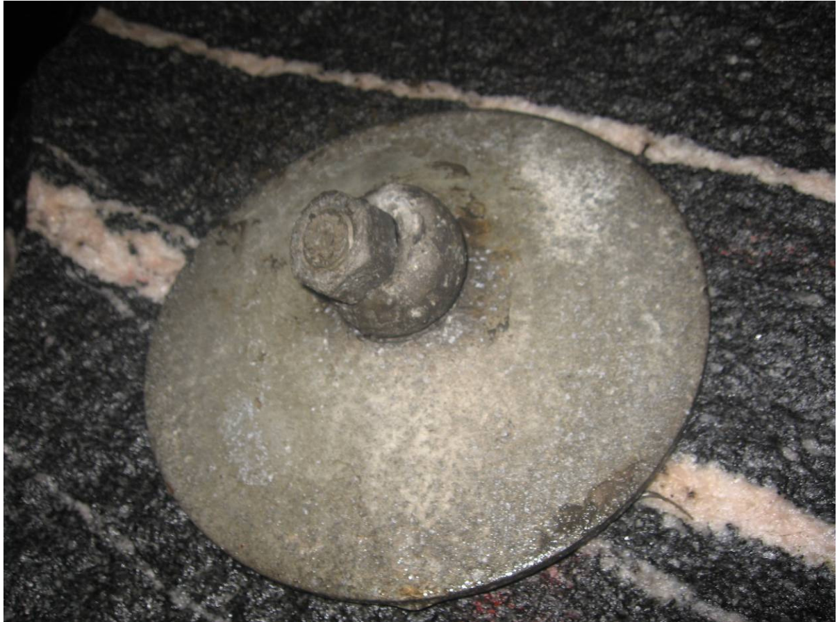
Figur 1.6-17 Antydning til misfaring på bolteplate
