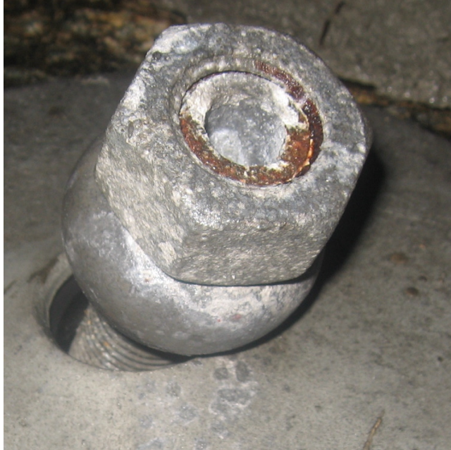
Figur 9 Korrosjon på bolteende rørbolt og innside av mutter (Godøytunnelen)
