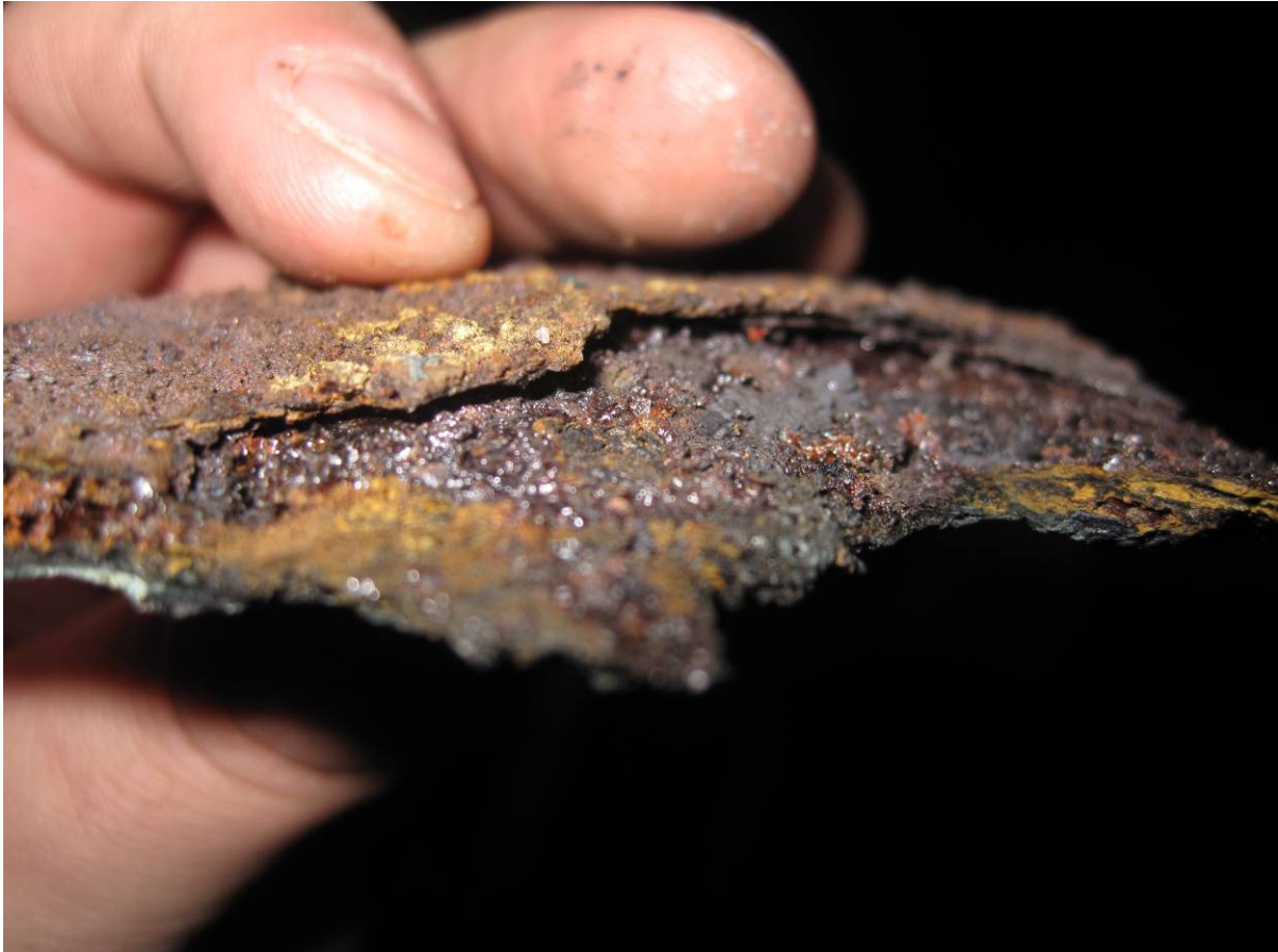
Figur 1.4-17 Avslått korrosjonslag, Bolt 4. Synlig hulrom og lagdeling.
