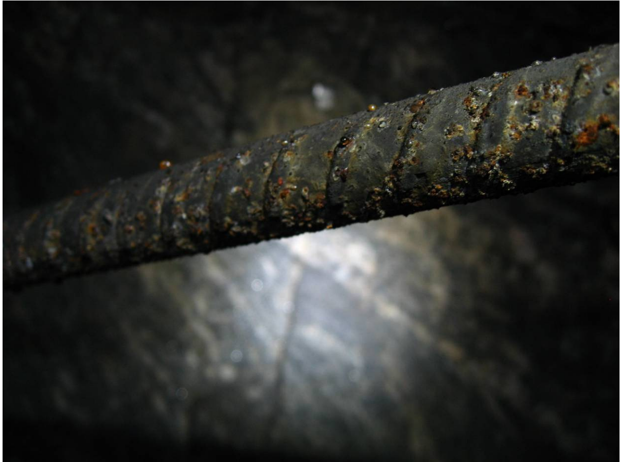
Figur 1.3-11 Punktkorrosjon på kamstål for feste av vann- og frostsikring
