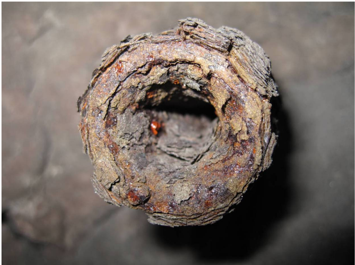
Figur 1.10-6 Swellexbolt 2. Radiell dannelse av rustflak både utenpå og inni bolten
