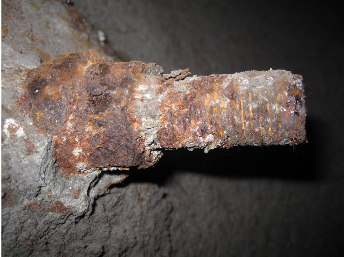
Figur 1.5-19 Bolt 9 Bolteende, kule og mutter etter fjerning av løs korrosjon med geologhammer
