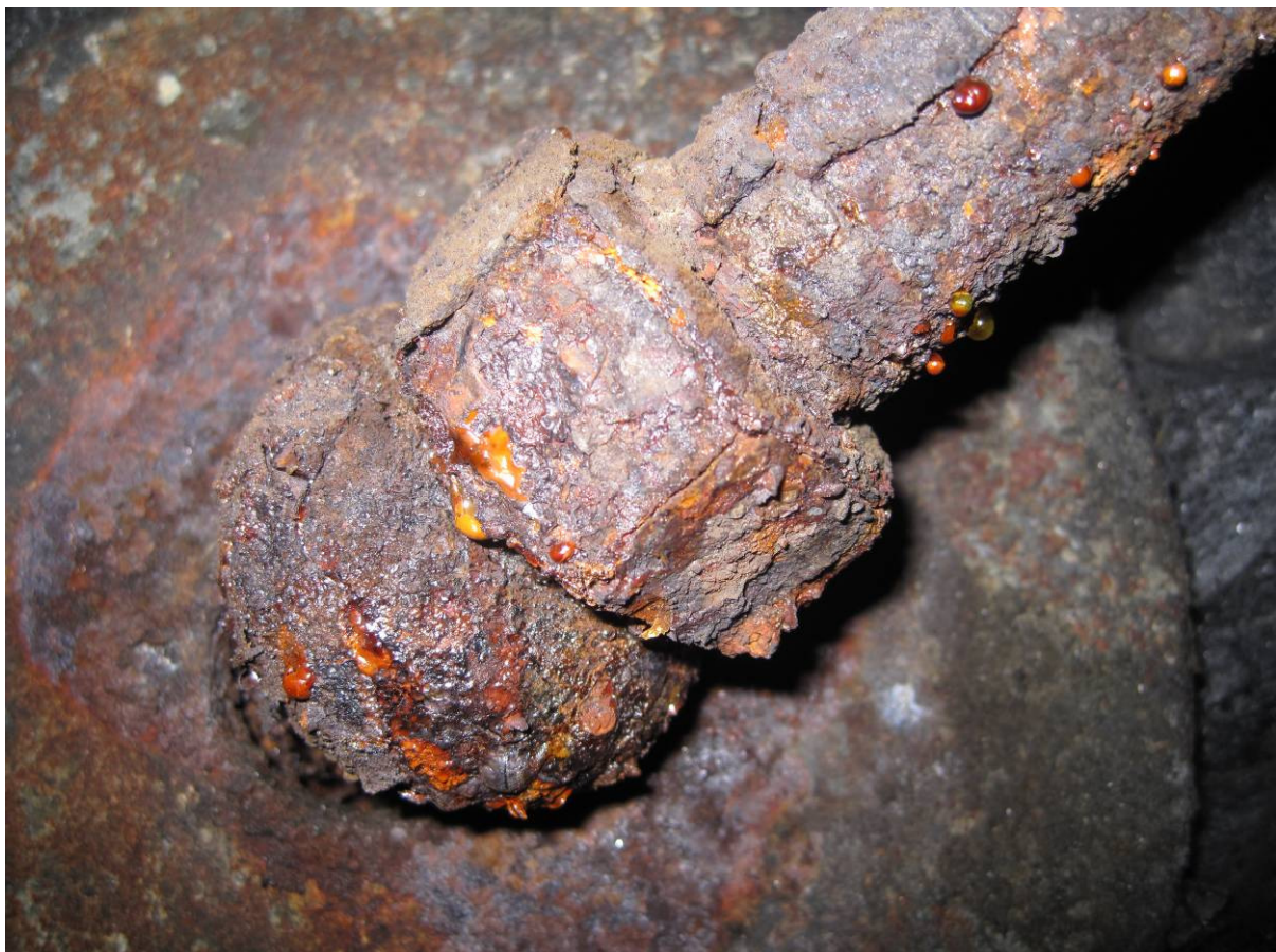
Figur 1.4-20 Bolt 5. Tydelig lagdeling med rust rundt bolt. Vanndråper
