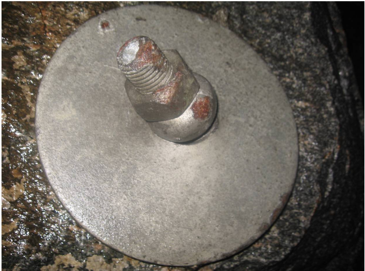
Figur 1.6-6 Lokal korrosjon på kule, mutter og bolteende
