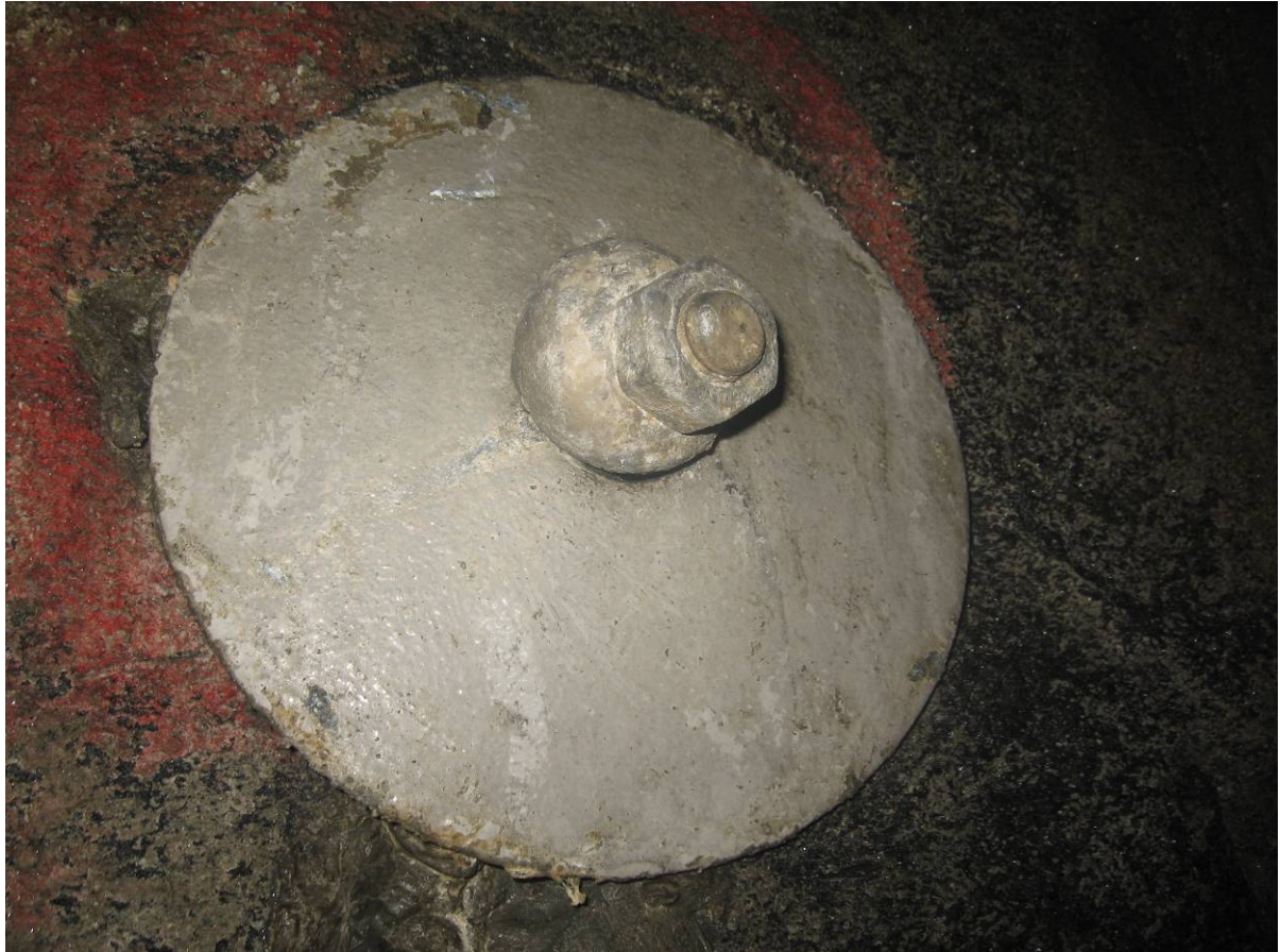
Figur 1.6-29 Bolt med dobbel korrosjonsbeskyttelse. Pulverlakken er vablete og flasser av på bolteskive og halvkule
