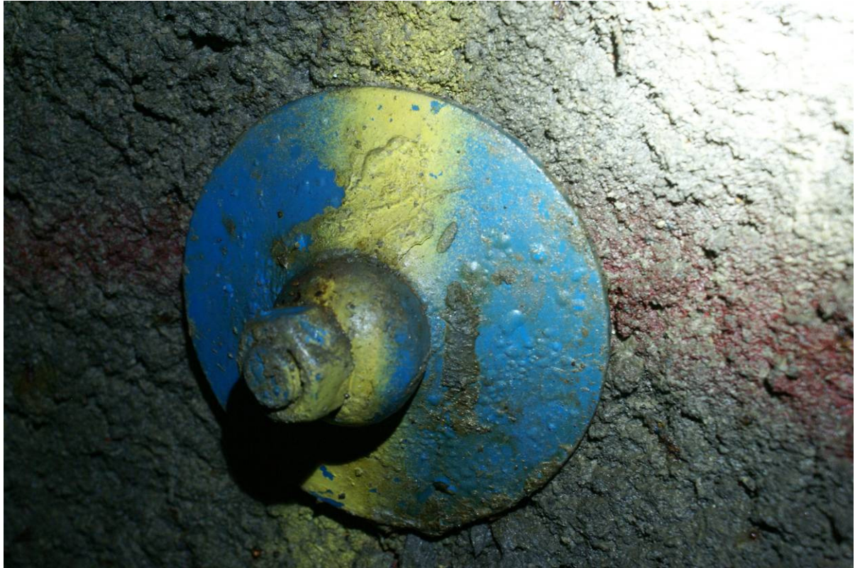
Figur 1.1-1 Antatt endeforankret bolt med dobbel korrosjonsbeskyttelse. Pulverlakkbelegget er vablete og lar seg på disse steder lett skrape av.
