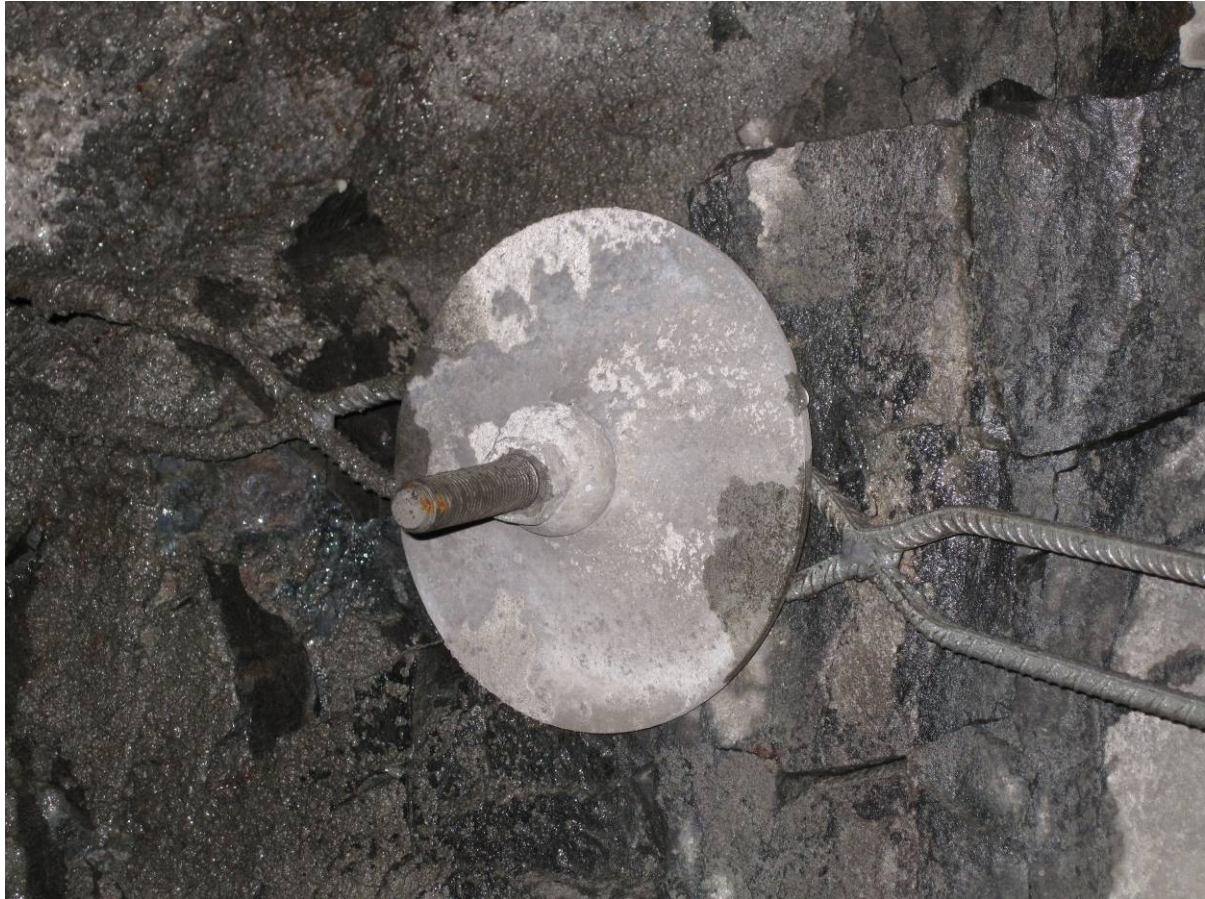
Figur 1.11-5 Misfarging på boltetupp. Fuktig berg
