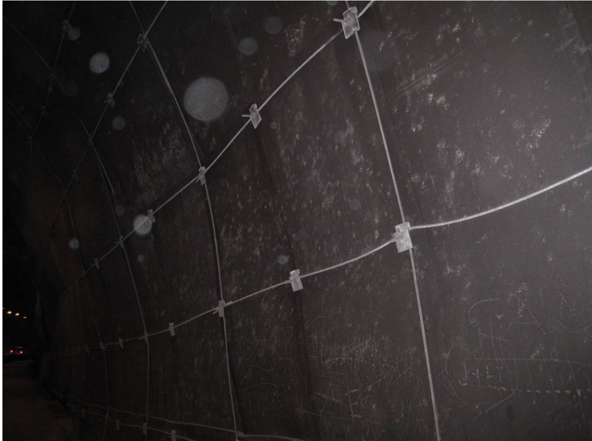
Figur 1.7-5 Vannsikring i portal mot Ålesund. Ingen korrosjon å se på festebolter eller kamstål
