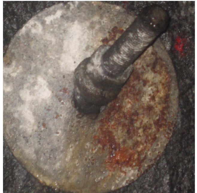
Figur 6 Korrosjon på deler av bolteplate. Antydning til små korroderte groper i stålet. Ingen korrosjon på bolt/mutter/halvkule (Godøytunnelen)
