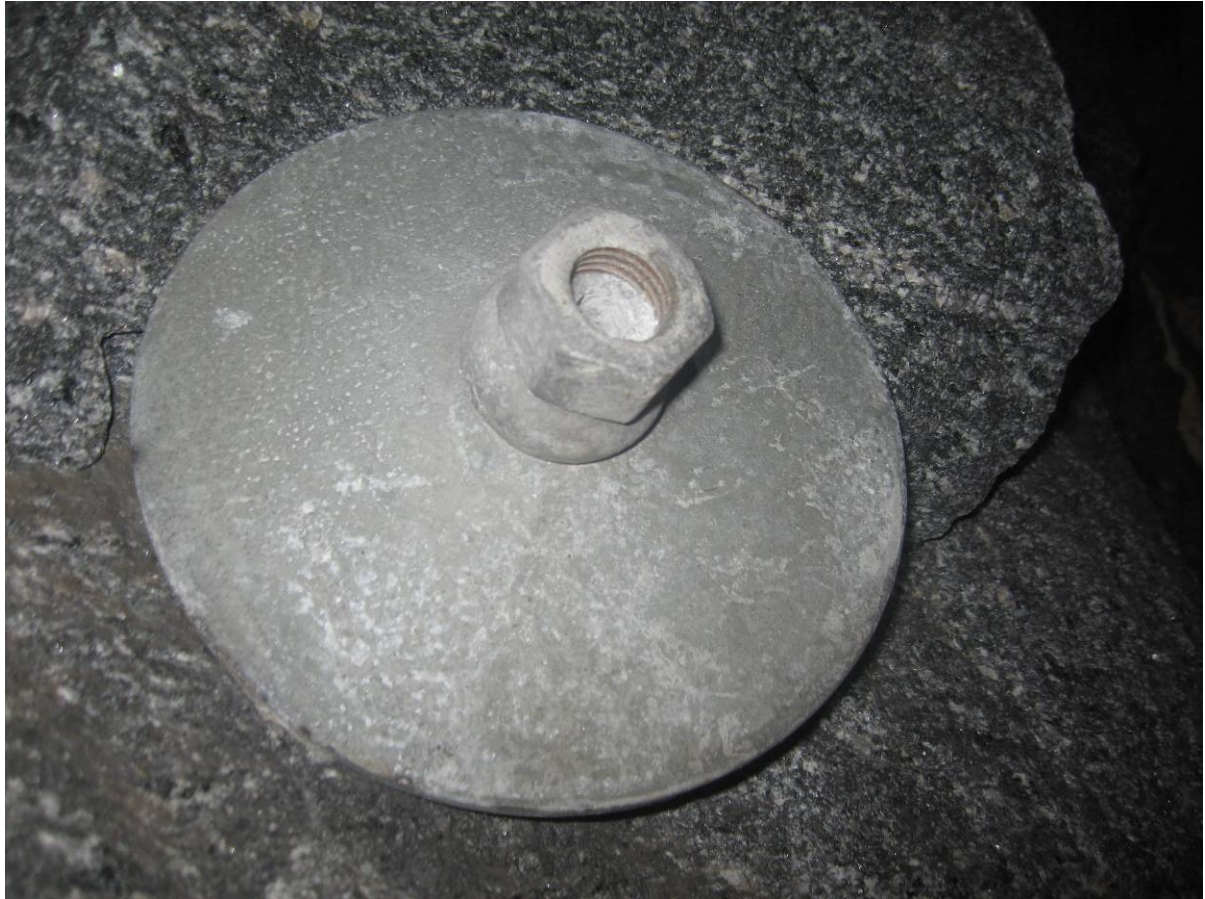
Figur 1.6-7 Bolt fri for korrosjon med unntak av gjenger på innside av mutter
