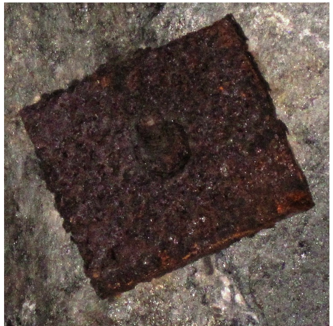
Figur 14 Heltdekkende korrosjon på svartstålbolt. Større korn av rust er synlig på platen som er jevnt korrodert (Hamregjøltunnelen)
