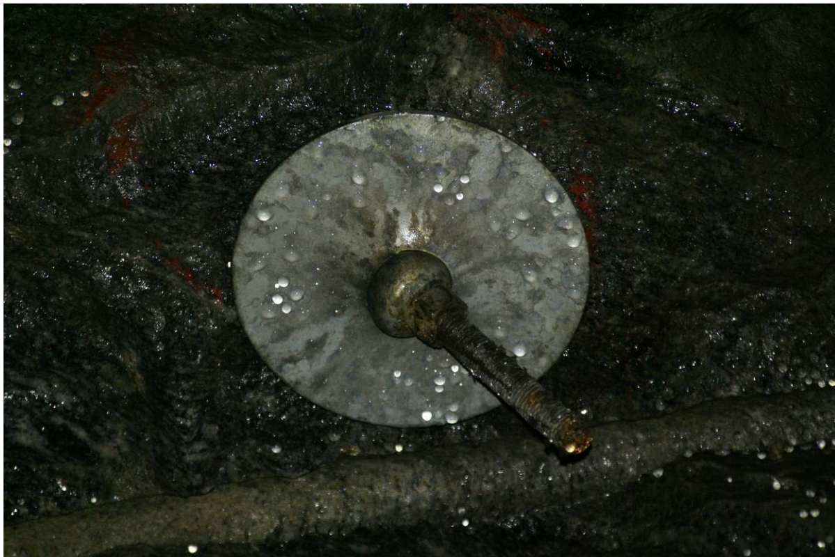
Figur 1.2-2 Bolt i fuktig parti. Synlig vann og kondens på bolt. Korrosjon på bolteende og enkelte gjenger. Misfarging på halvkule.
