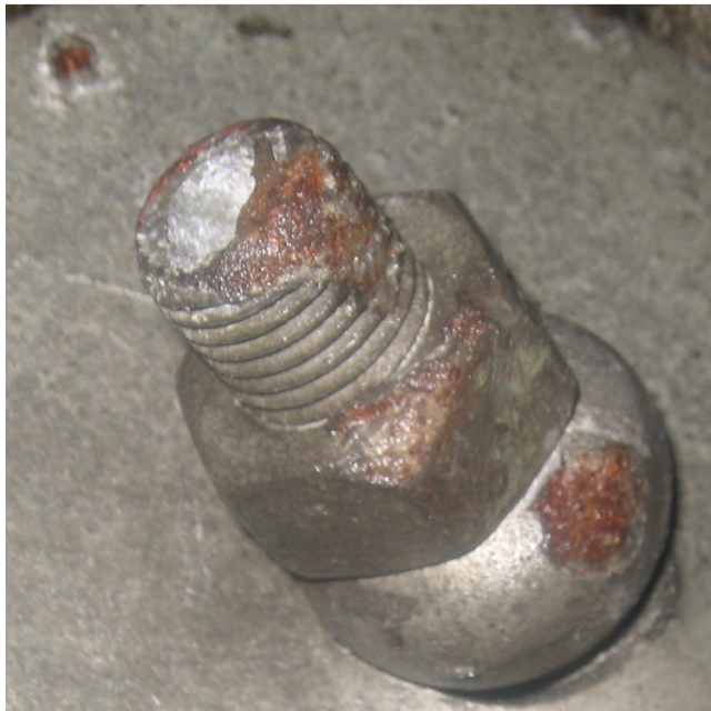
Figur 11 Korrosjon på bolteende rørbolt, mutter og halvkule (Godøytunnelen)
