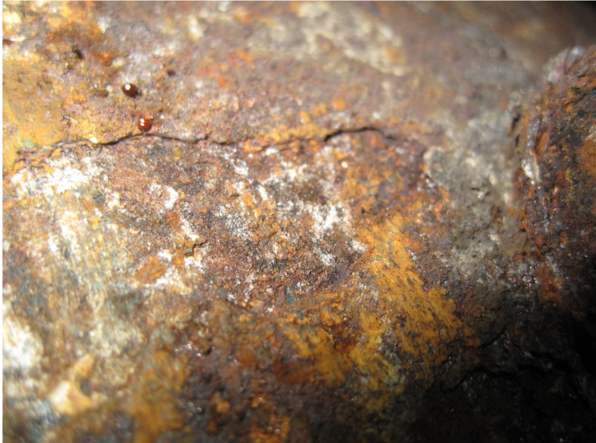
Figur 1.4-9 Bolt 1. Flak med rust og synlig stål under
