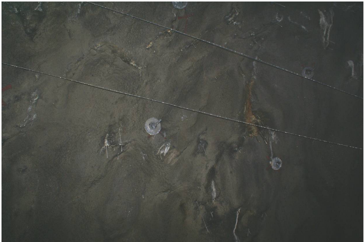
Figur 1.2-12 Tunnelvegger i verkstedhall. Lite korrosjon å se på bolter selv om det er fukt, rustutfelling og brunt slam/algevekst fra berget.
