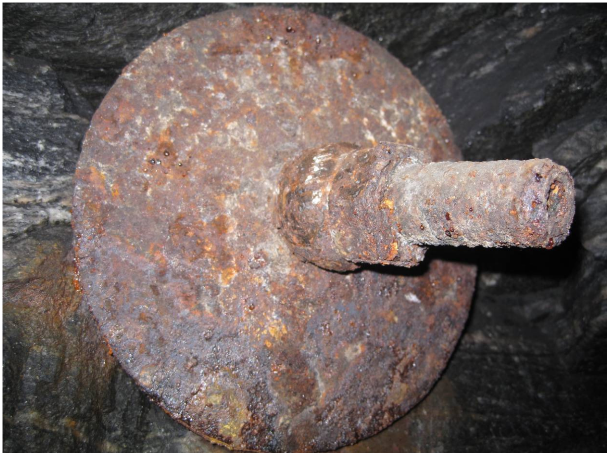
Figur 1.4-6 Bolt 1, før fjerning av korrosjon på skive
