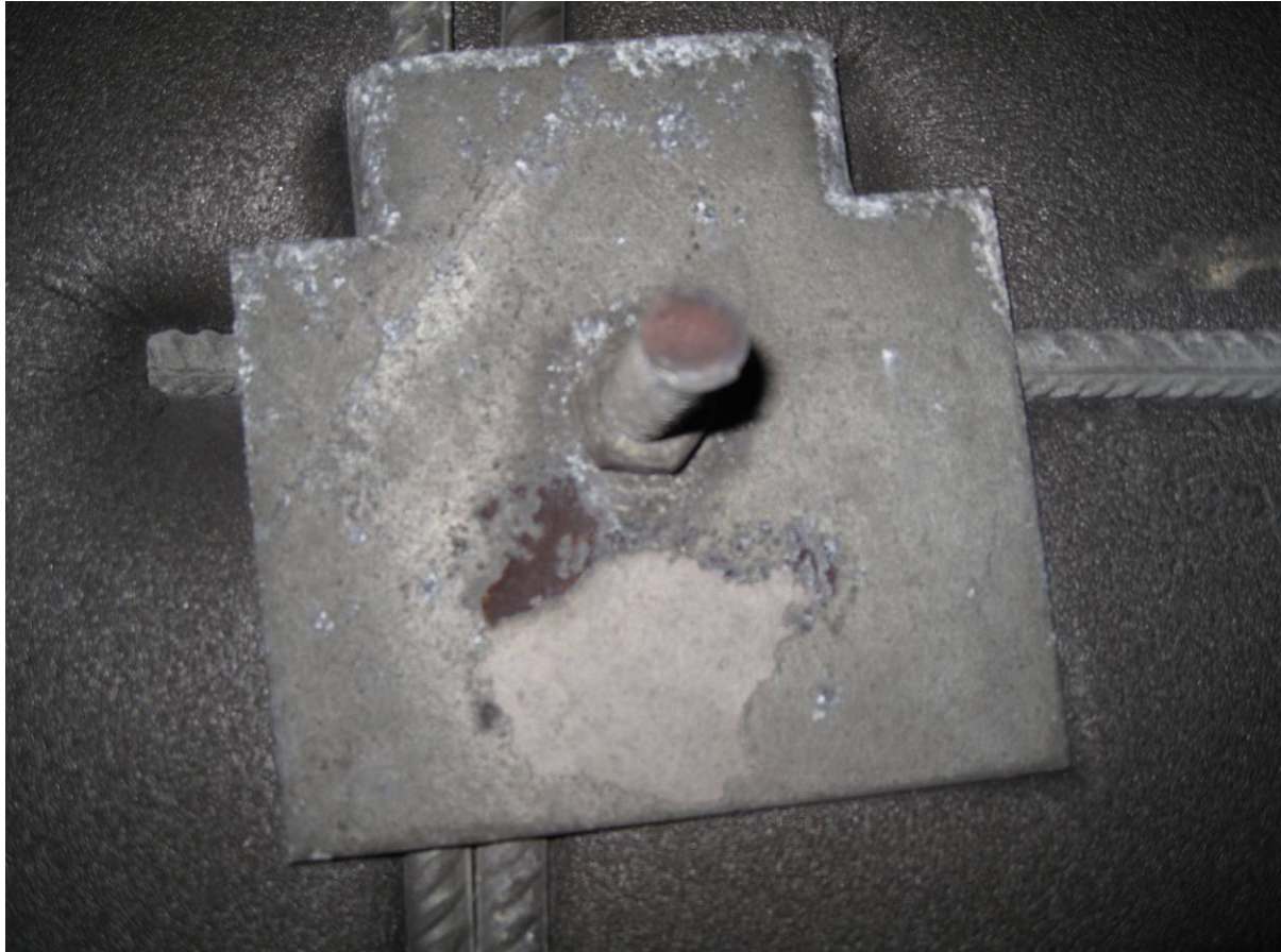
Figur 1.7-13 Korrosjon på tupp av festebolt og på bolteskive
