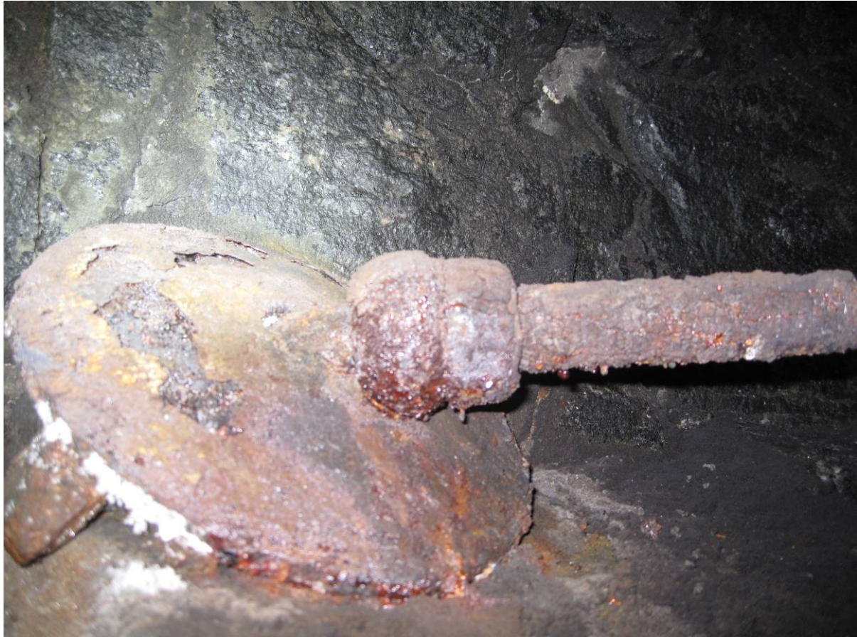
Figur 1.4-13 Bolt 4. Kraftig korrodert bolt. Store groper i skive og korrosjon i flere lag rundt kule, bolt og mutter. Synlig hulrom under korrosjonsoverflaten.
