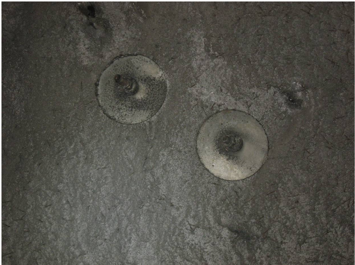
Figur 1.3-4 Bolter med misfarging og skittbelegg, men ikke synlig korroderte.
