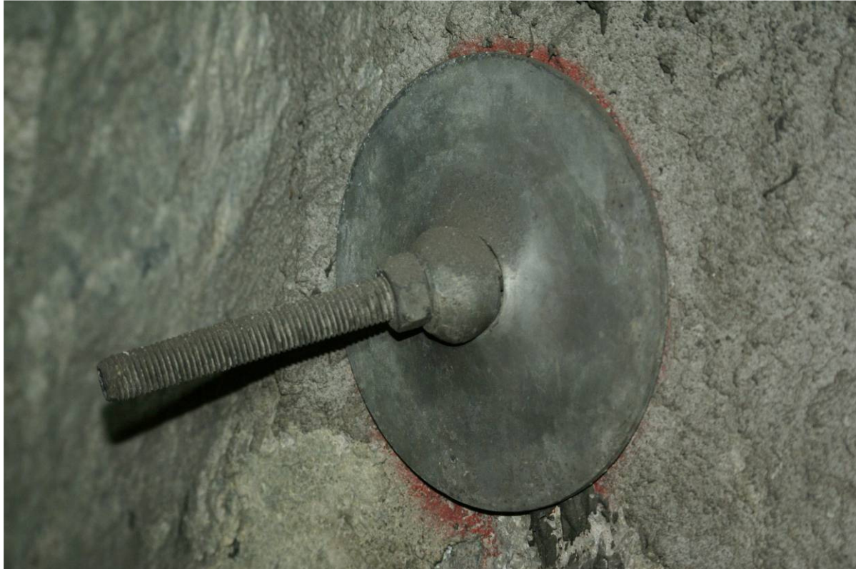
Figur 1.2-5 Bolt, forurenset med vegstøv.
