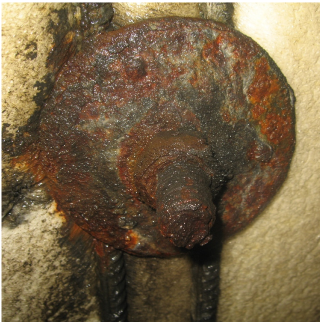
Figur 13 Nesten heltdekkende korrosjon på festebolt for vannsikring. Stålet er ikke synlig. Små synlige vabler i korrosjonsproduktet (Godøytunnelen)
