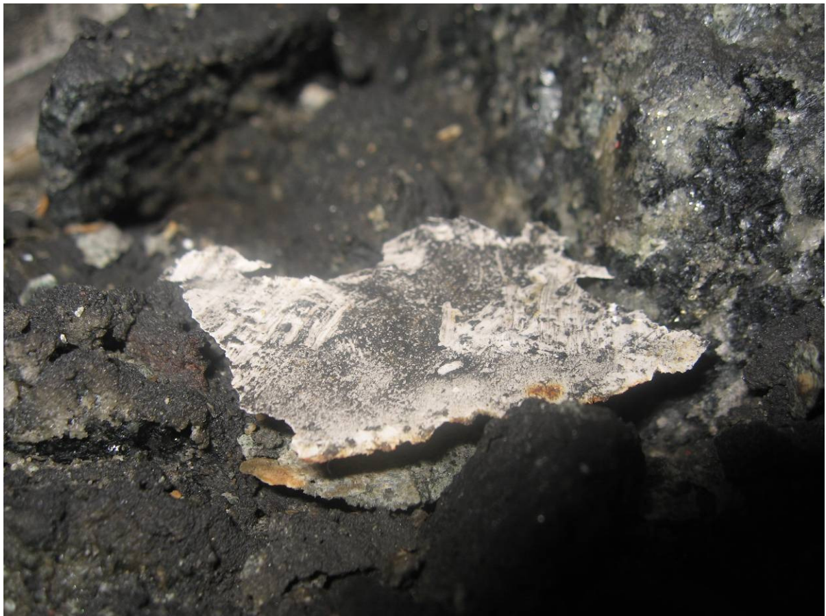
Figur 1.6-34 Bolt 1. Avskrapet pulverlakk. Tydeligvis mye luft under lakken siden den kan skrapes av i større flak
