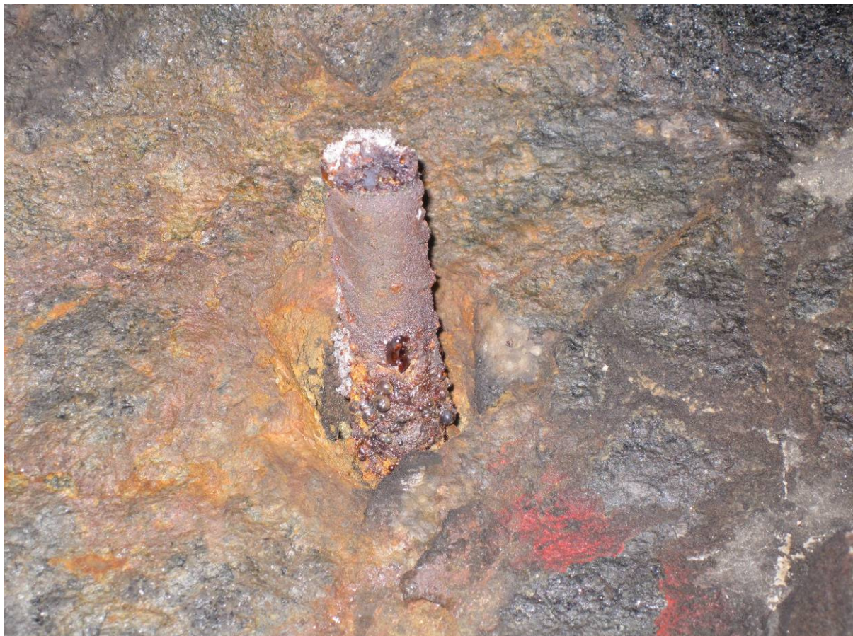
Figur 1.4-26 Bolt 8 Fullt innstøpt kamstålbolt, uten skive, halvkule og mutter. Korrosjonsprodukter fra bolten har satt seg i berget rundt.
