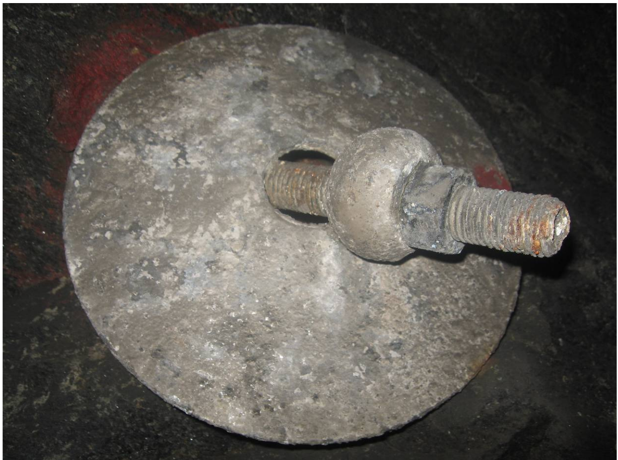
Figur 1.6-30 Noe korrosjon å se på bolten, vablete pulverlakk som skaller av
