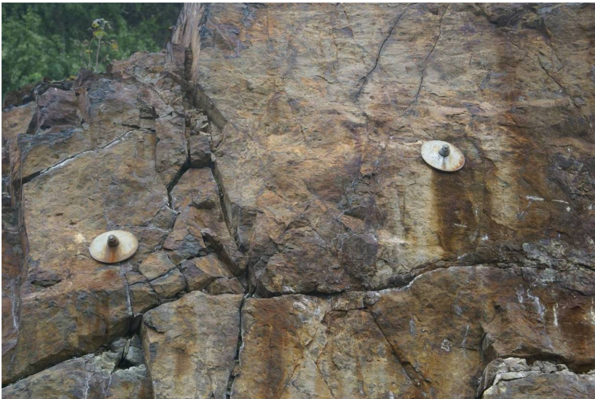
Figur 2.1-3 Korroderte bolteskiver, misfarging på bolt, halvkule og mutter
