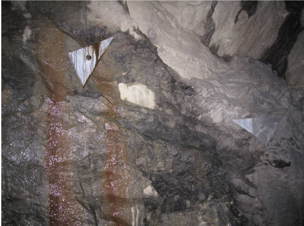
Figur 1.8-7 Korrosjon og rustutfelling der det er vann. Bolt ved siden av fuktig berg er tilsynelatende rustfri
