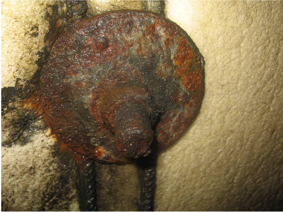
Figur 1.6-23 Korrosjon på festebolt for vannsikring. Alt er korrodert. Vabler på plate.
