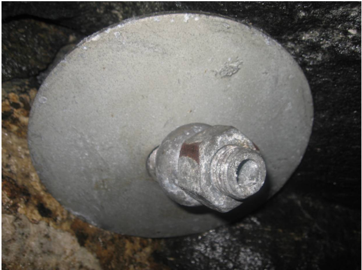
Figur 1.6-4 Korrosjon på mutter
