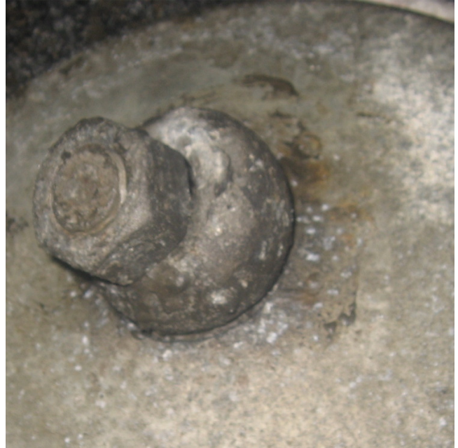
Figur 2 Misfarging av bolt. Misfargingen kan skyldes smuss og skitt fra byggefase og driftsfase (Godøytunnelen)
