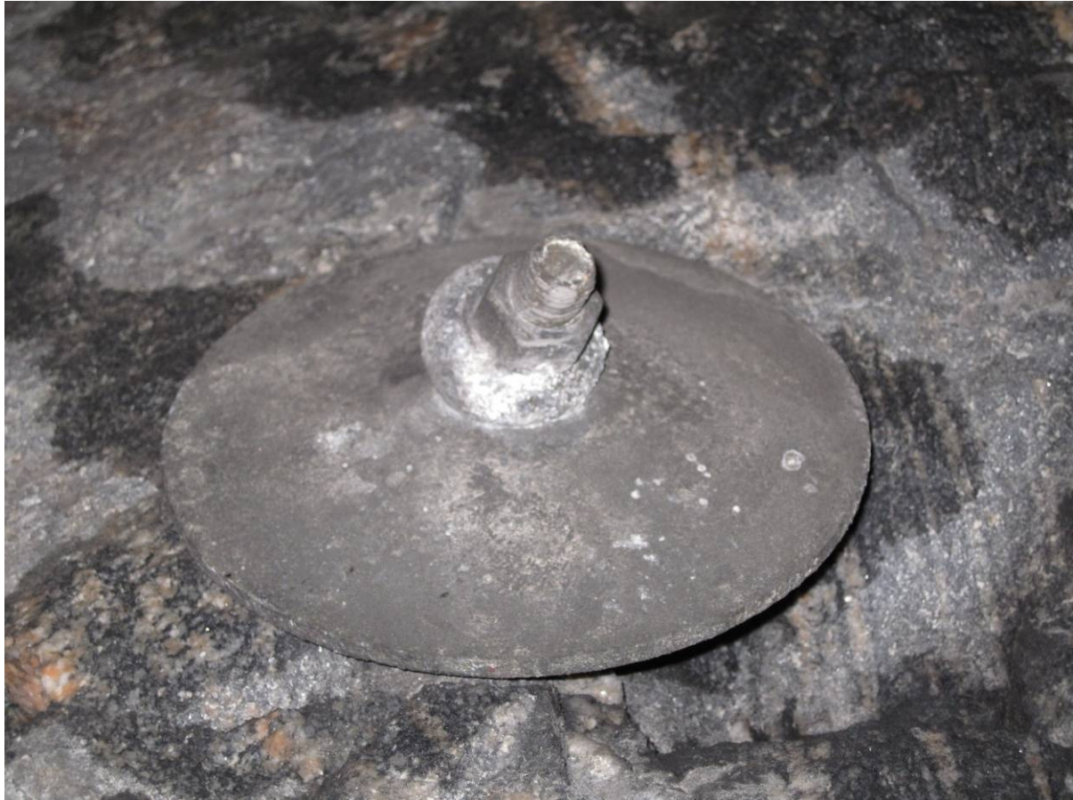
Figur 1.7-11 Ikke korrosjon selv der det er skader på boltmateriell (halvkule)
