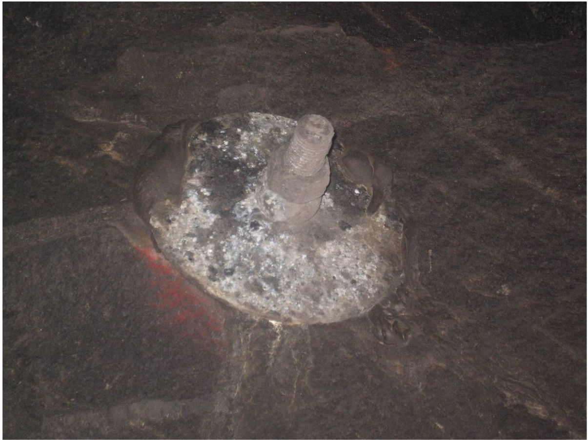
Figur 1.6-39 Bolt uten korrosjon, men tilgriset og med hvitspettet ståloverflate
