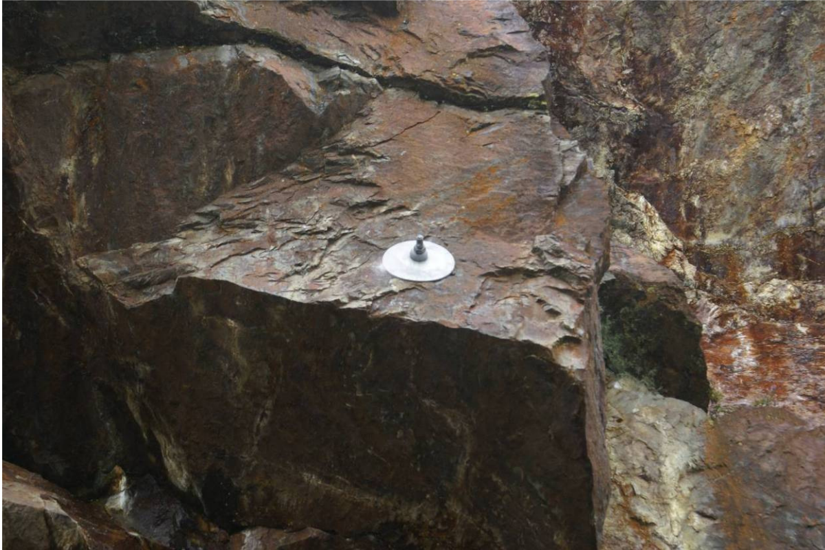
Figur 2.1-2 Bolt uten korrosjon, oksidert berg
