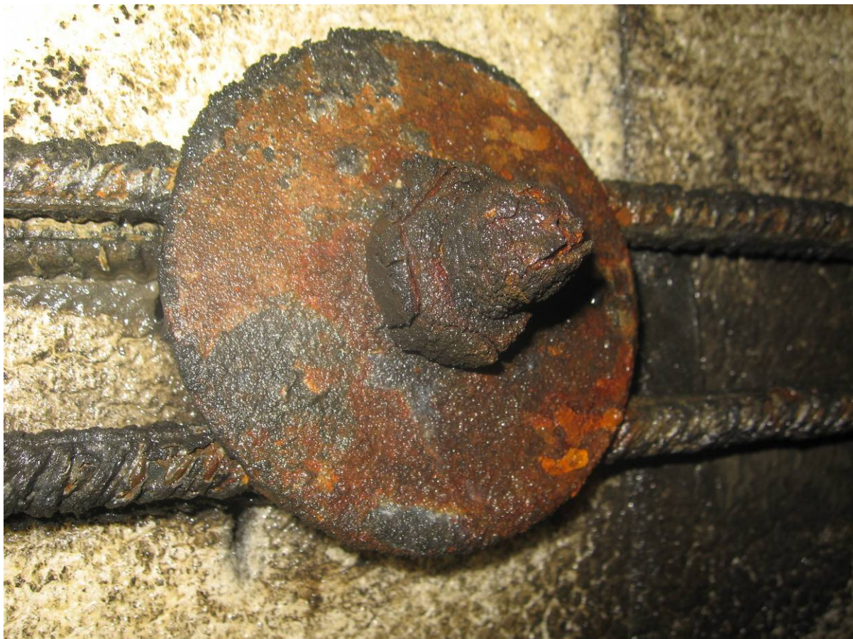
Figur 1.6-24 Korrodert festebolt og stigebånd. Korrosjonsmateriale på mutter sprekker opp radielt.
