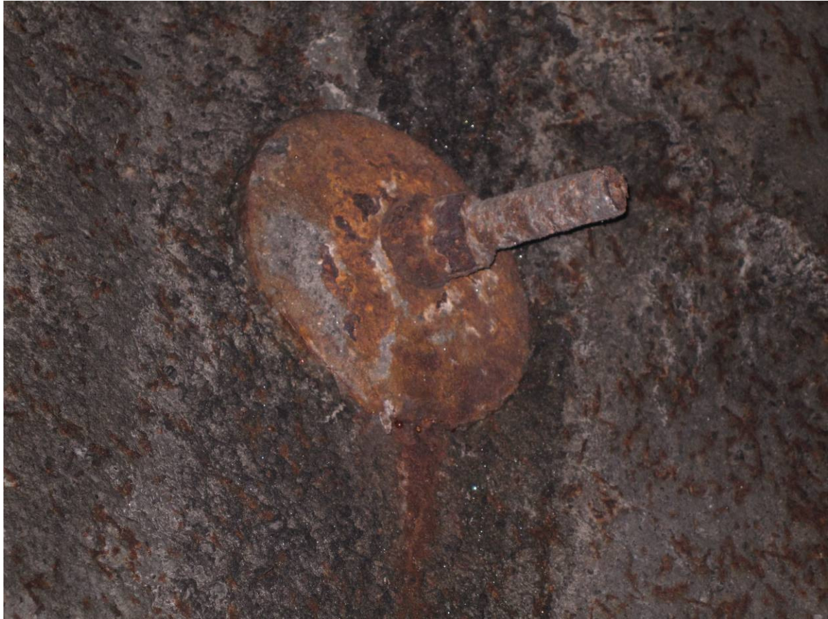
Figur 1.5-7 Bolt 4. Ikke sprøytet inn. Synlig rustutfelling fra nedre del av bolt eller boltehull.
