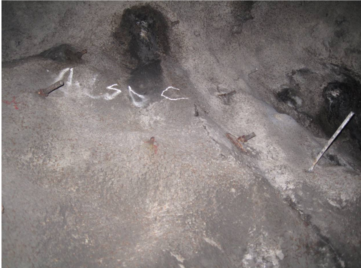
Figur 1.5-3 Korroderte, innsprøytede rørbolter og fullt innstøpte bolter
