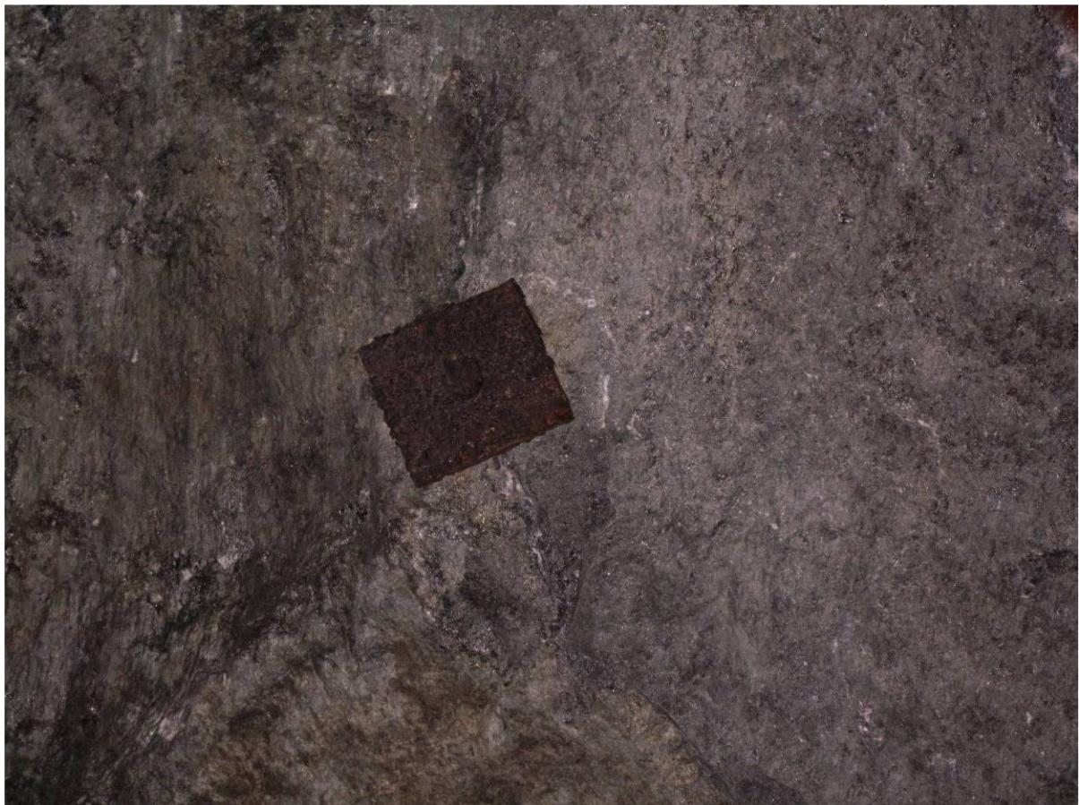
Figur 1.10-18 Gammel svartstålbolt, kraftig korrodert. Vanskelig å si omfanget. All sikring med svartstålbolter er gjort i heng
