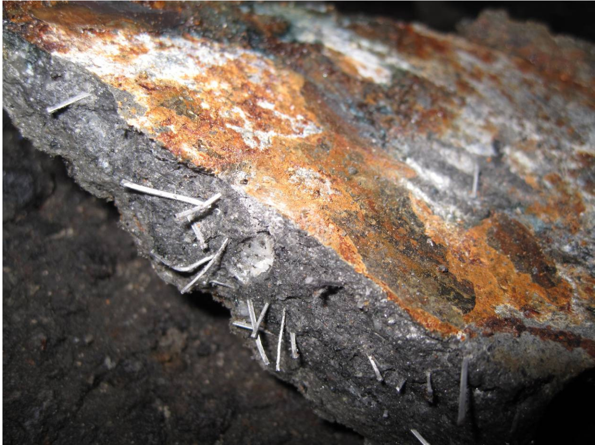
Figur 1.5-23 Sprøytebetongskalk slått av bolt 13. Stålfiber er helt "ferske" der de ligger inne i betongen, selv om utstikkende ende er helt oppspist. Korrosjonsmateriale fra overflate bolt
