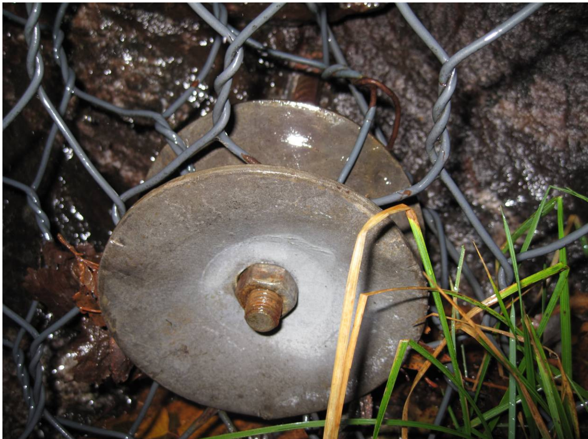
Figur 1.9-12 Korrosjon på bolt, mutter og wire enkelte steder, misfarging på bolteskive
