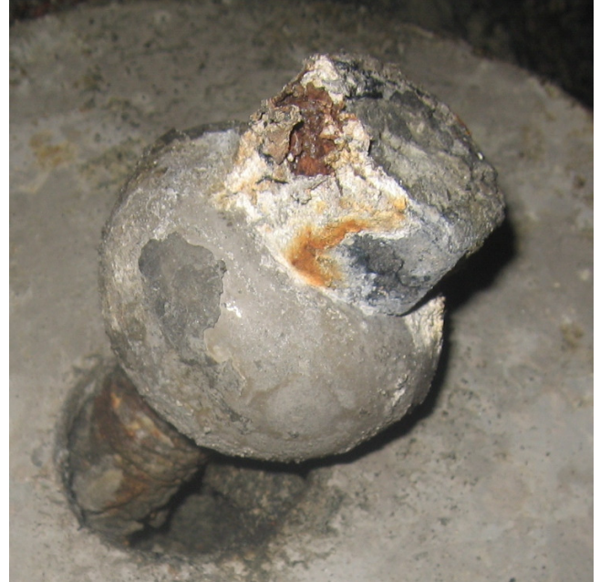
Figur 10 Dyp lokal korrosjon på mutter (Godøytunnelen)
