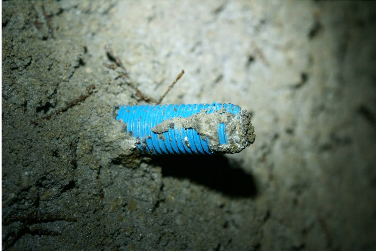
Figur 1.1-3 Ukorrodert bolteende. Mutter, plate og kule er innsprøytet, boltetupp mekanisk rengjort for sprøytebetong.
