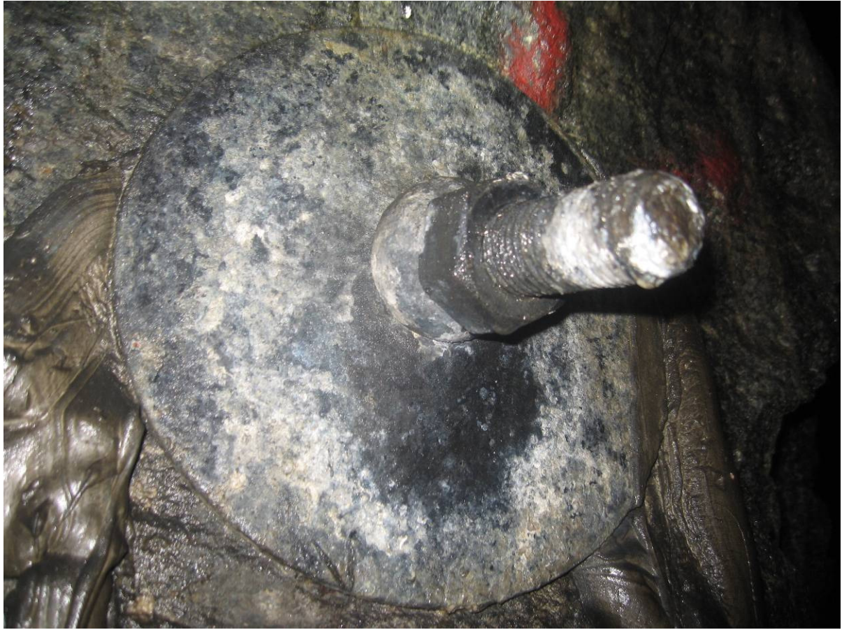
Figur 1.6-37 Bolteskive som det er vanskelig å si om har hatt pulverlakk eller ikke
