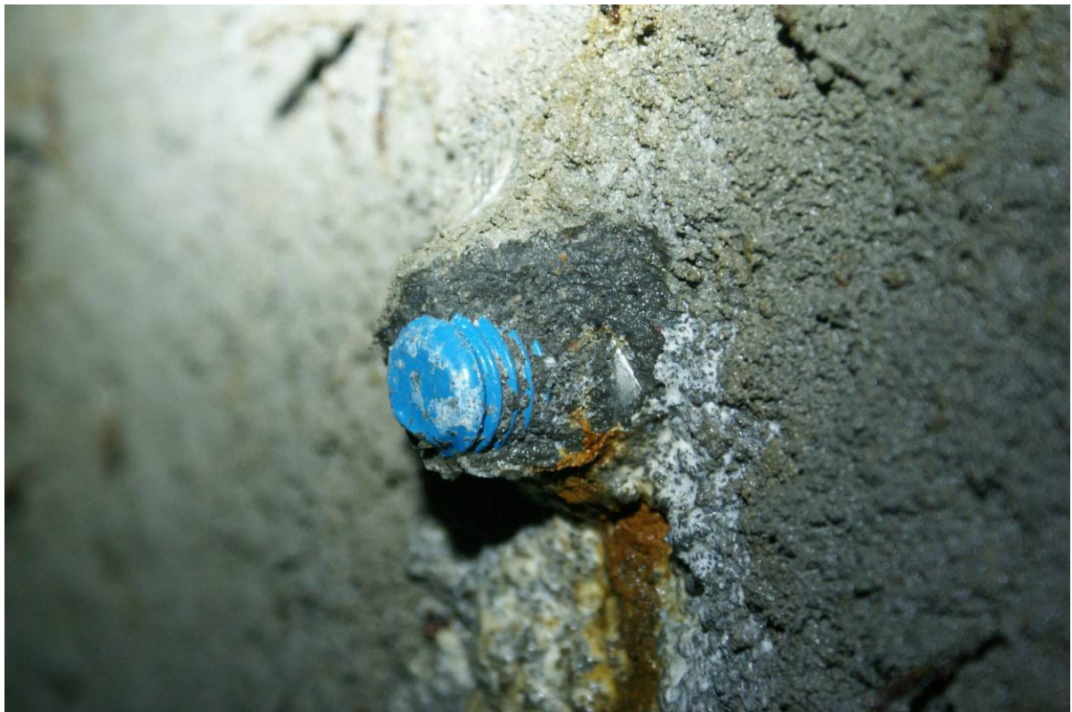
Figur 1.1-2 Ukorrodert bolteende og mutter (ikke dobbel korrosjonsbeskyttelse). Noe rustutfelling nedenfor boltehull.
