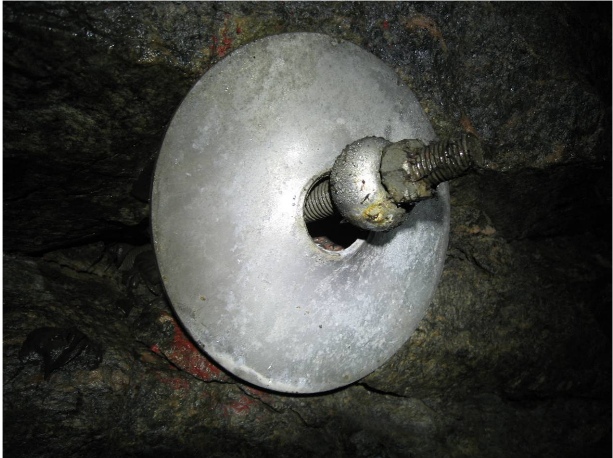
Figur 1.3-5 Bolt med noe misfarging på kule, mutter, og utstikkende bolteende, men ingen synlig korrosjon. Synlig fukt på bolt og berg.
