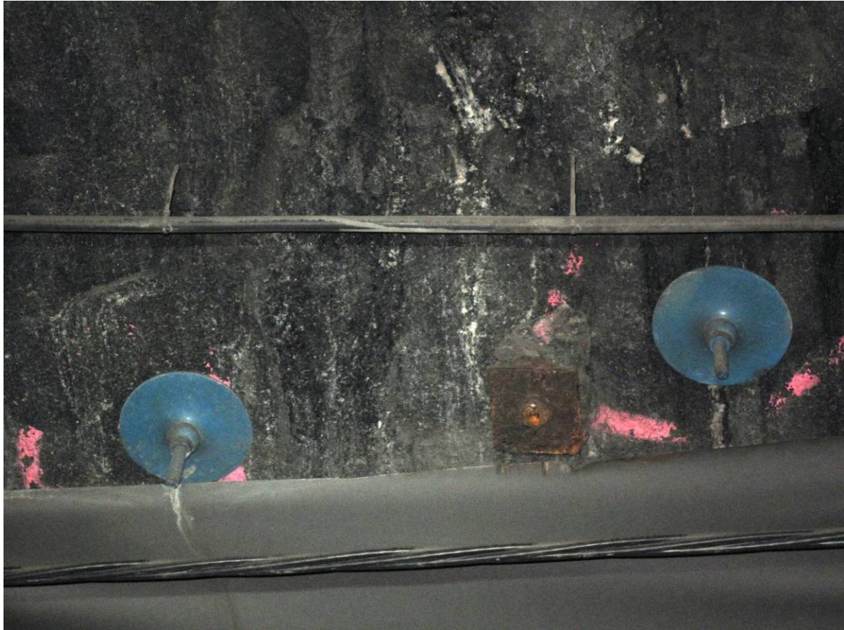
Figur 1.11-7 Bolter med dobbel korrosjonsbeskyttelse, og en gammel uten noen beskyttelse
