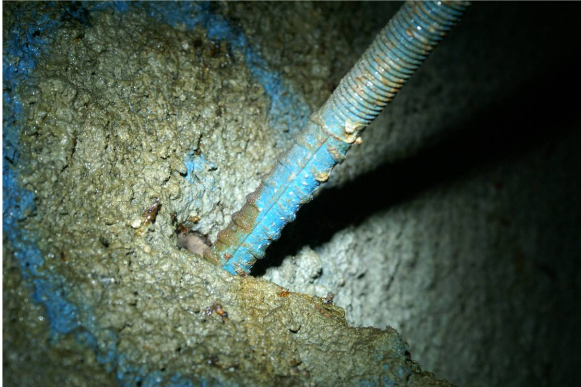
Figur 1.1-7 Korrodert festebolt. Lett overflatekorrosjon på gjenger
