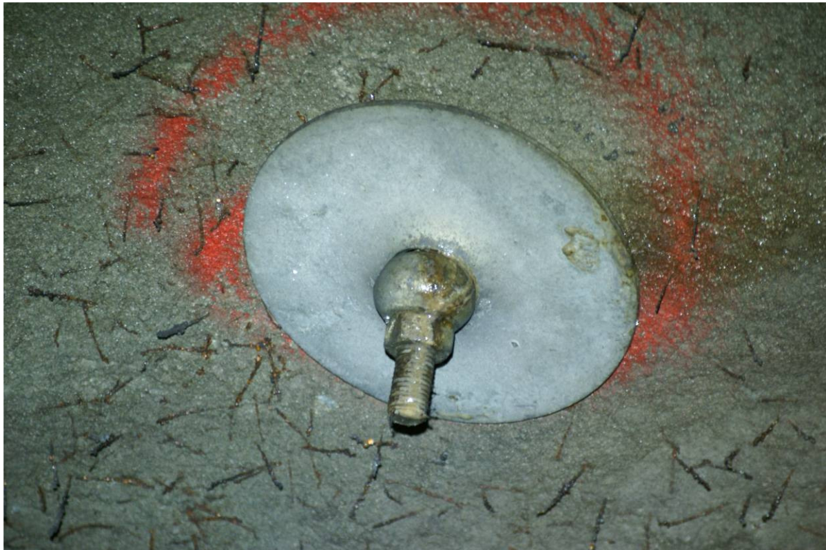
Figur 1.2-6 Utfelling fra boltehull og synlig lekkasje. Kalk fra innstøpningsmørtel? Noe misfarging på kule, mutter og bolteende.
