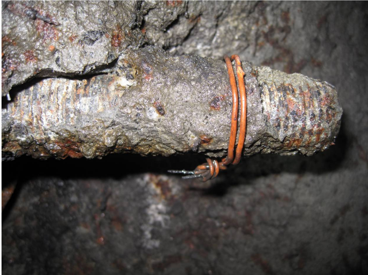
Figur 1.5-25 Bolt 13. Utstikkende bolteende, dekket av sprøytebetong og korrosjon
