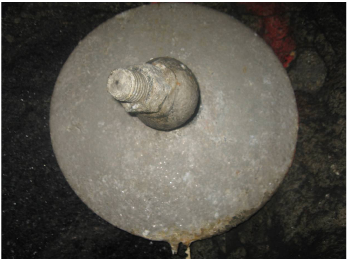
Figur 1.6-36 Bolt med dobbel korrosjonsbeskyttelse. Rustfarget pulverlakk med avskalling og veldig vablete overflate på skive
