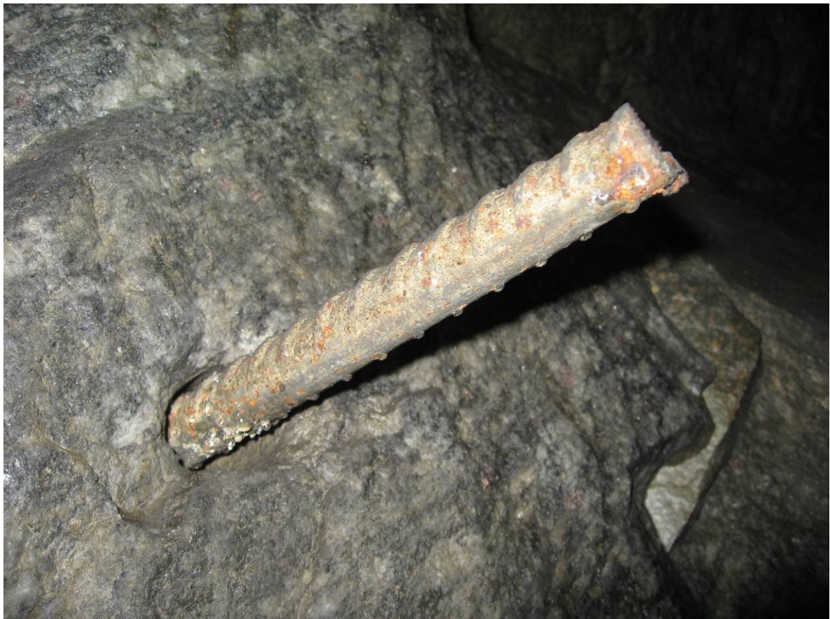
Figur 1.3-12 Punktkorrosjon på kamstålbolt for opphengingsformål under driveperioden. Antatt uten korrosjonsbeskyttelse
