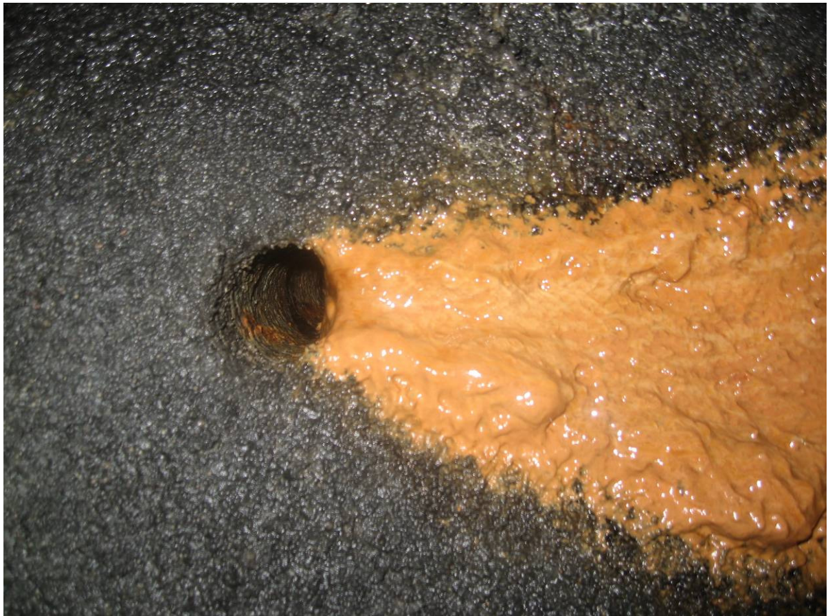
Figur 1.6-38 Utfelling fra borehull. Denne type utfelling, som antas å kunne skyldes alger, ble observert flere steder i tunnelen og i flere av de andre tunnelene.
