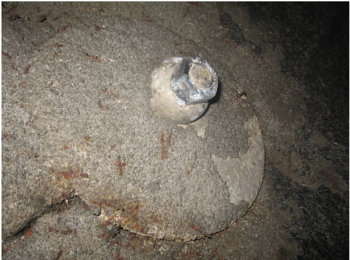
Figur 1.6-28 Innsprøytet bolteskive. Synlig del av skive med pulverlakk er vablete
