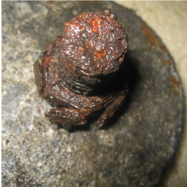
Figur 15 Kraftig korrosjon som har angrepet mutter og bolt, men i mindre grad bolteskiven (Godøytunnelen)
