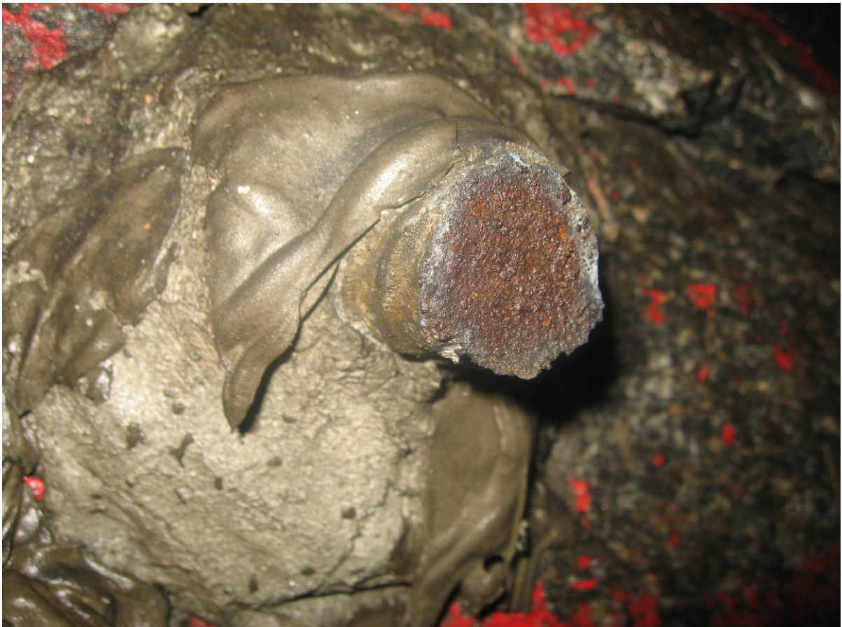
Figur 1.6-14 Fullt innstøpt bolt med korrodert bolteende
