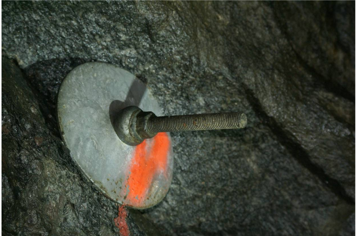
Figur 1.2-9 Ubetydelig overflatekorrosjon på gjenger
