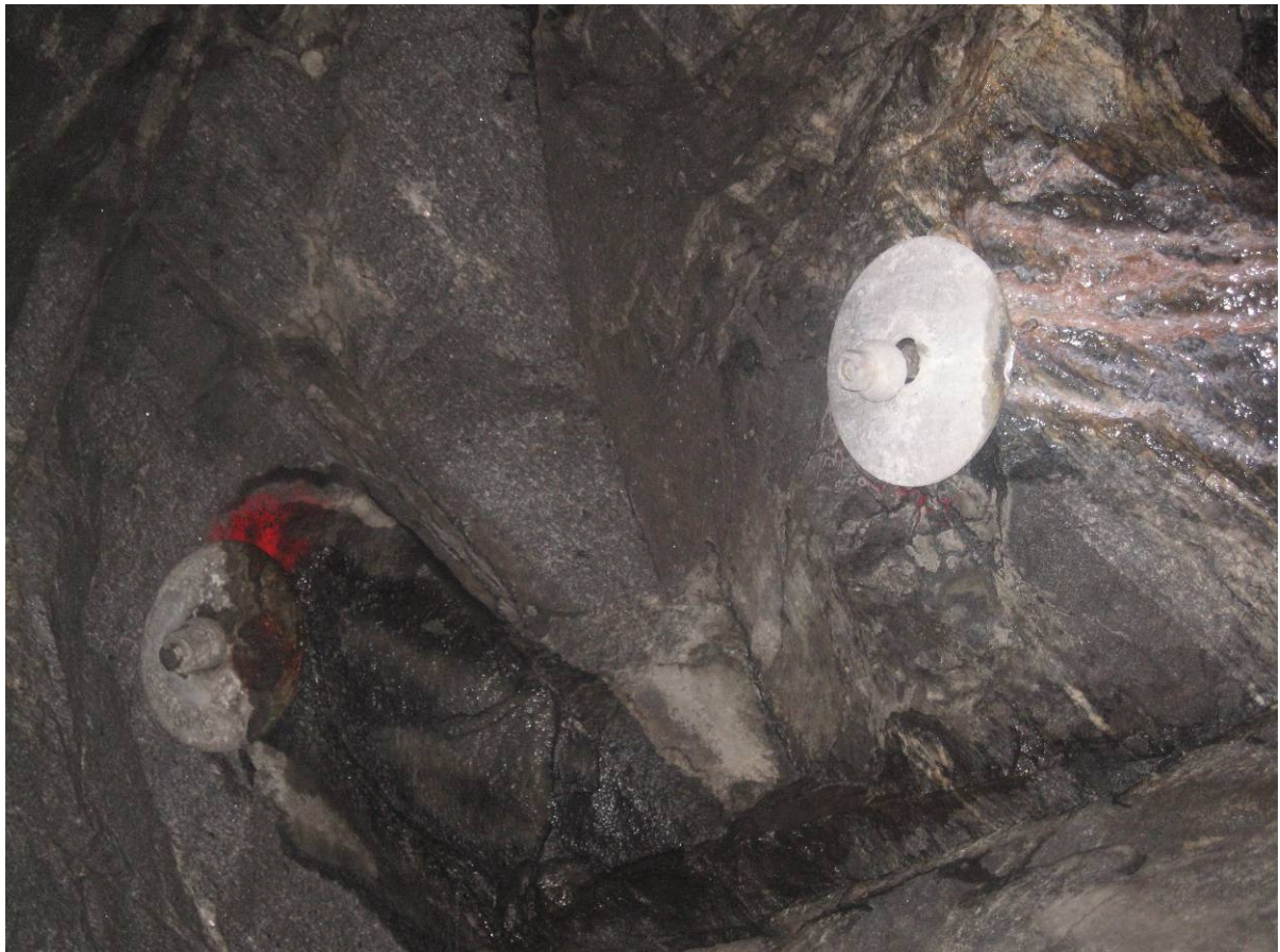
Figur 1.6-20 Vannlekkasjer og utfellinger. Noe korrosjon på øverste bolteplate
