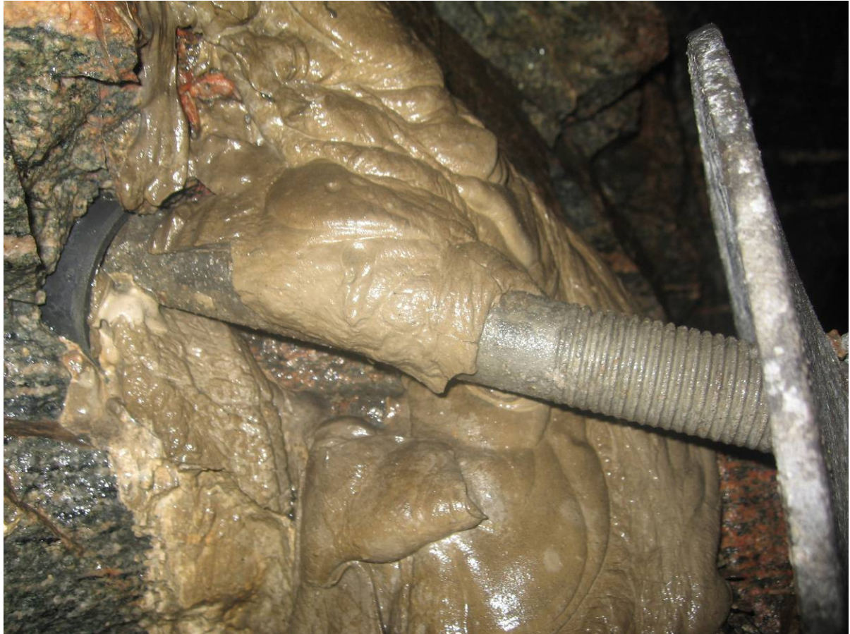
Figur 1.6-5 Mørtelsøl, men ikke synlig korrosjon på bolt
