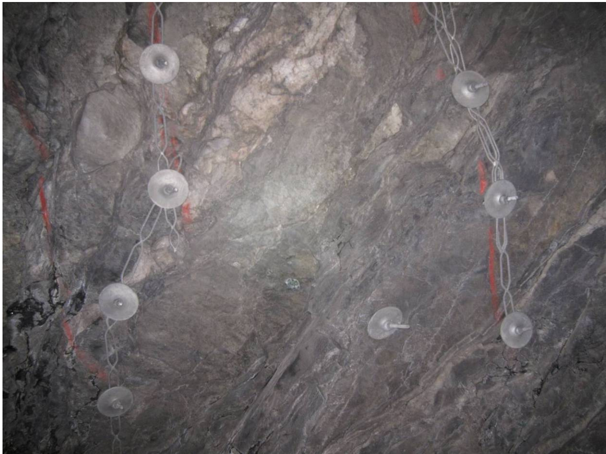
Figur 1.10-1 Mye ettersikring. Enkel korrosjonsbeskyttelse tydeligvis tilstrekkelig for denne type forhold
