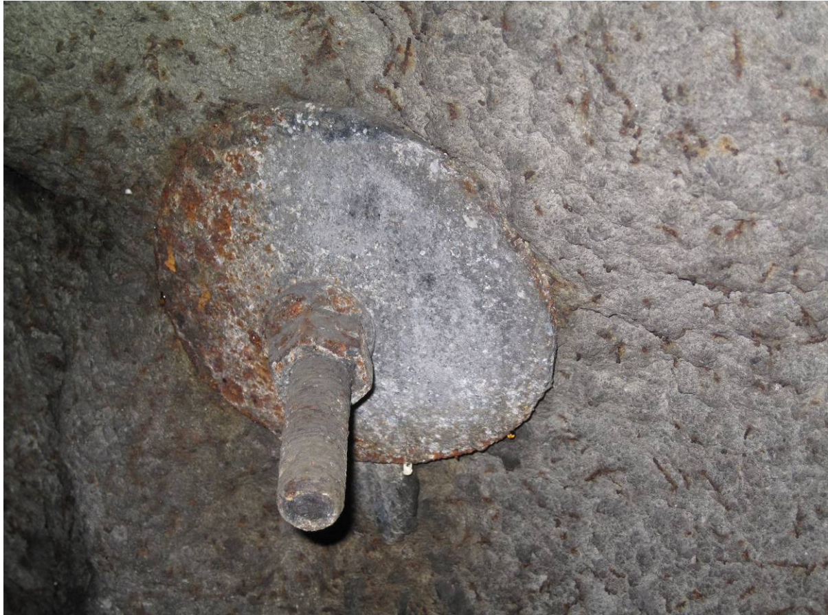
Figur 1.4-25 Bolt 7. Mindre angrepet bolt.
