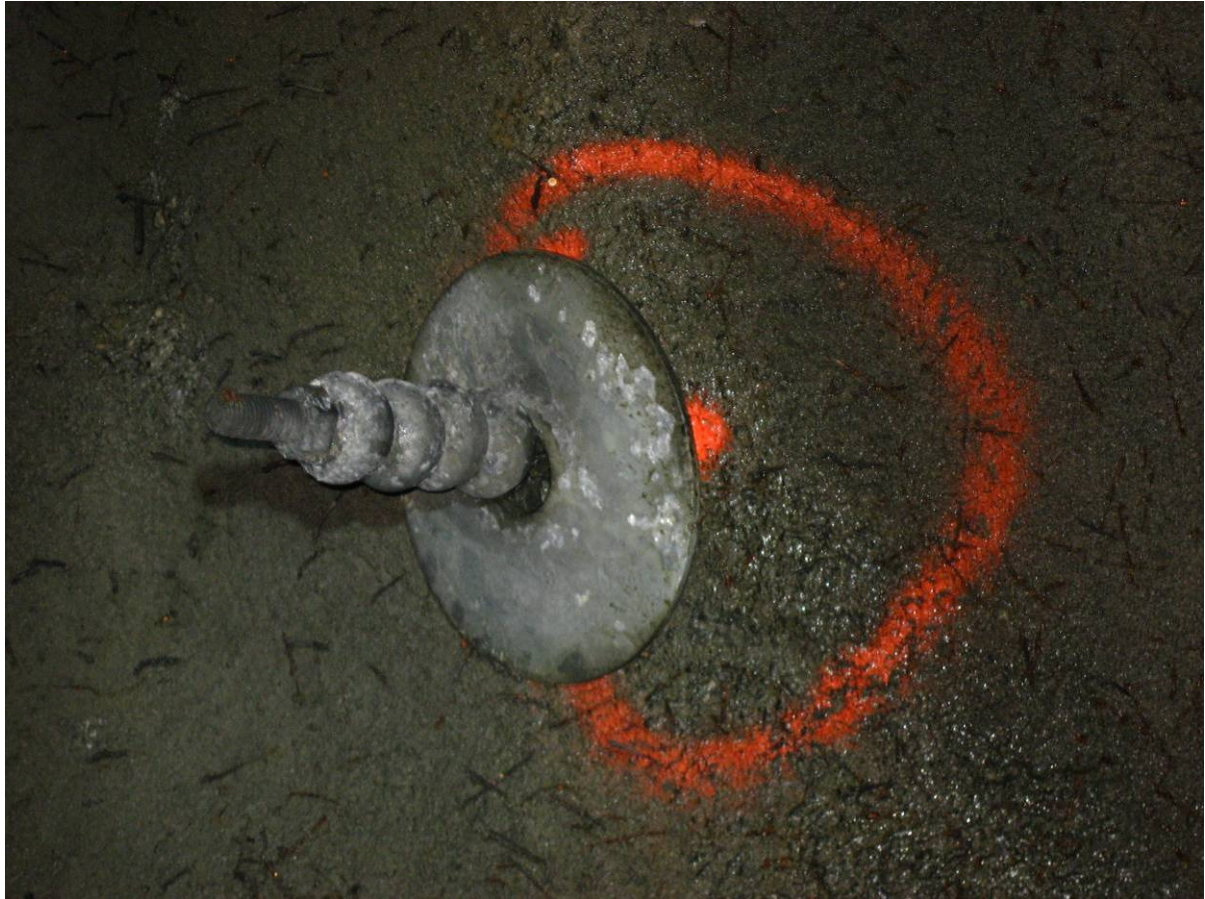
Figur 1.3-9 Vann fra boltehull, korroderte stålfibre i sprøytebetong, men kun beskjeden misfaring på bolteskive.
