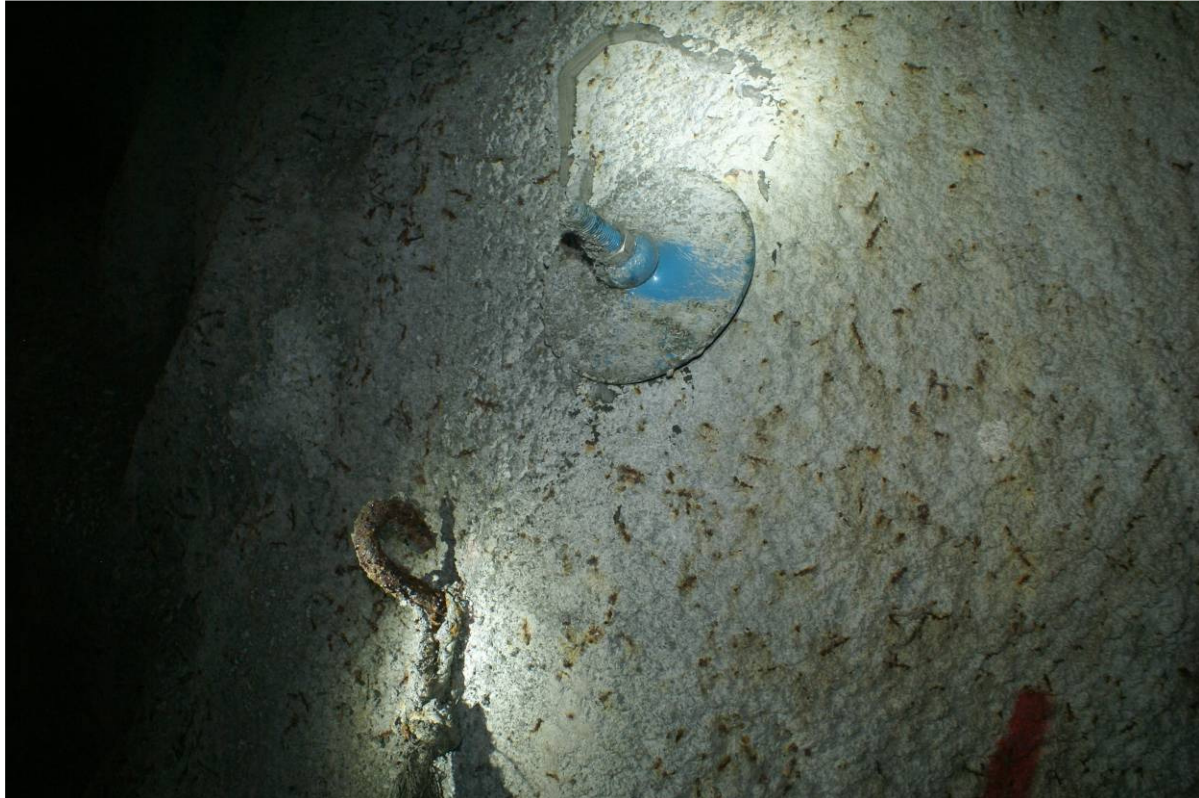
Figur 1.1-9 Endeforankret bolt med dobbel korrosjonsbeskyttelse ikke angrepet av rust. Festekrok i svartstål fra drivefasen helt dekket av korrosjon.
