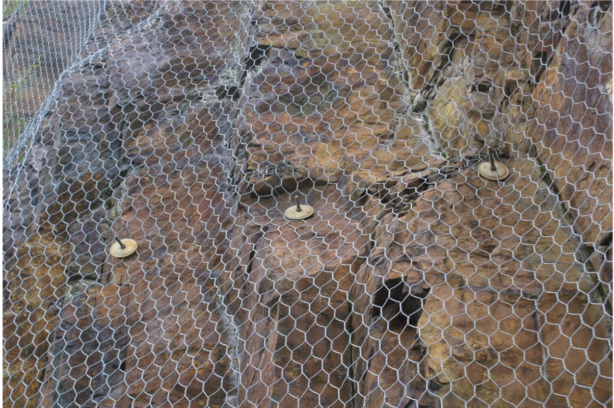
Figur 2.1-4 Bolteskiver med korrosjon/misfarging
