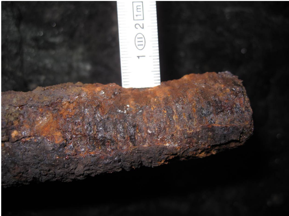
Figur 1.4-23 Bolt 5. Korrosjon på bolteende, mål av korrosjonstap etter rust er sltt vekk med geologhammer
