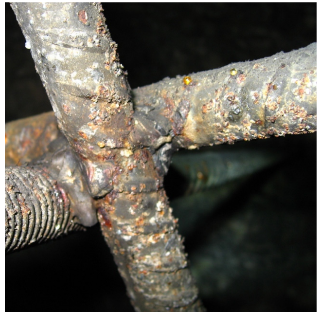
Figur 8 Punktvis korrosjon på bolt grunnet vannråper på stålet. Synlige rustkorn. Lite korrosjon å se mellom vannråpene (Nordbyttunnelen)
