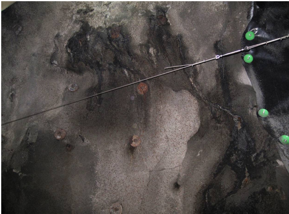
Figur 1.5-2 Korroderte rørbolter og fiberbetong. Nye festebolter fra 2009 for montering av vannsikring.
