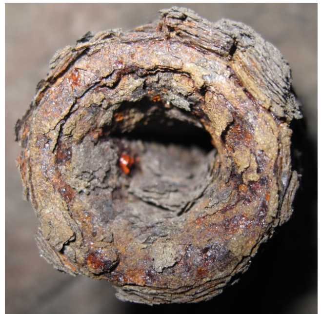
Figur 18 Radiell dyptgående korrosjon på innside og utside av bolteende på Swellexbolt (Hamregjøltunnelen)
