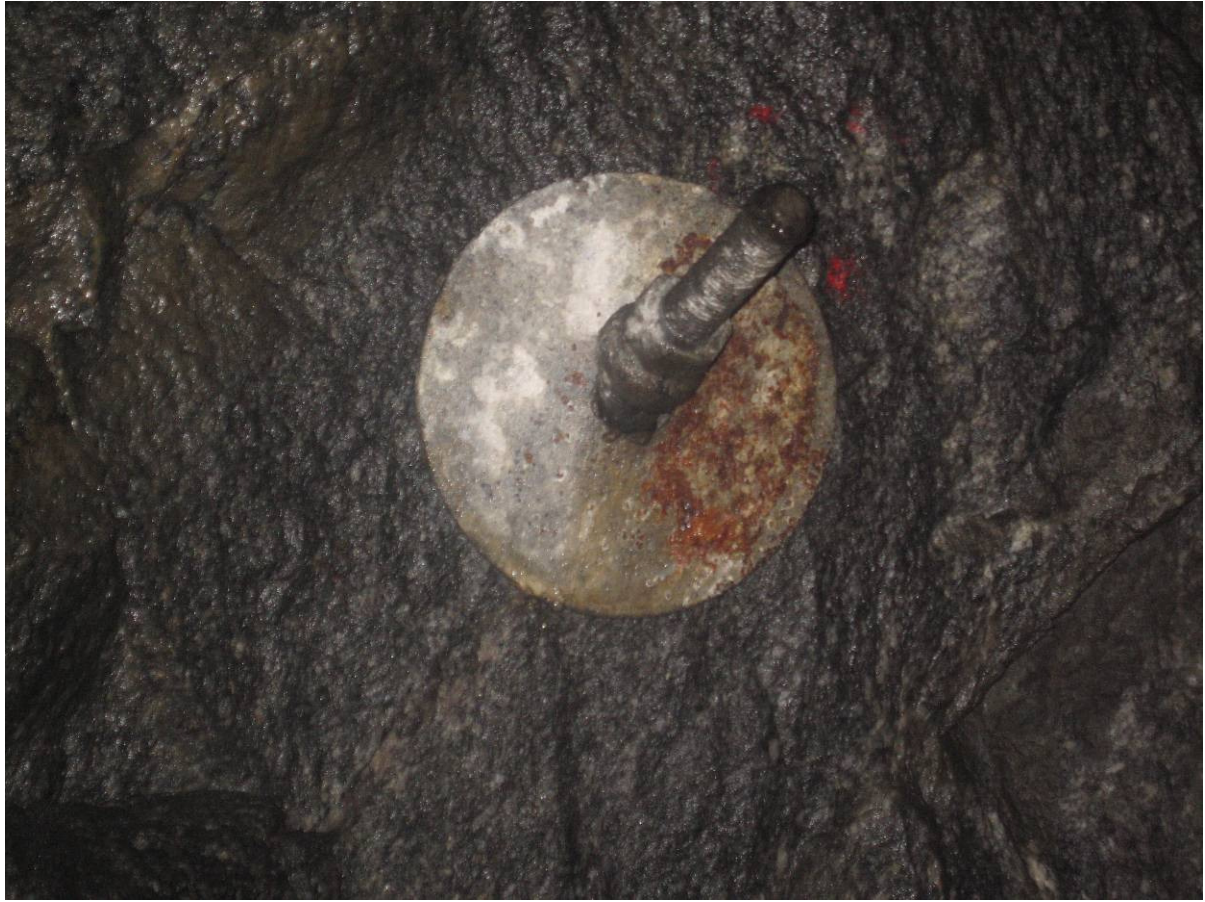
Figur 1.6-27 Korrodert bolteskive, ingen misfarging på halvkule, mutter, bolt
