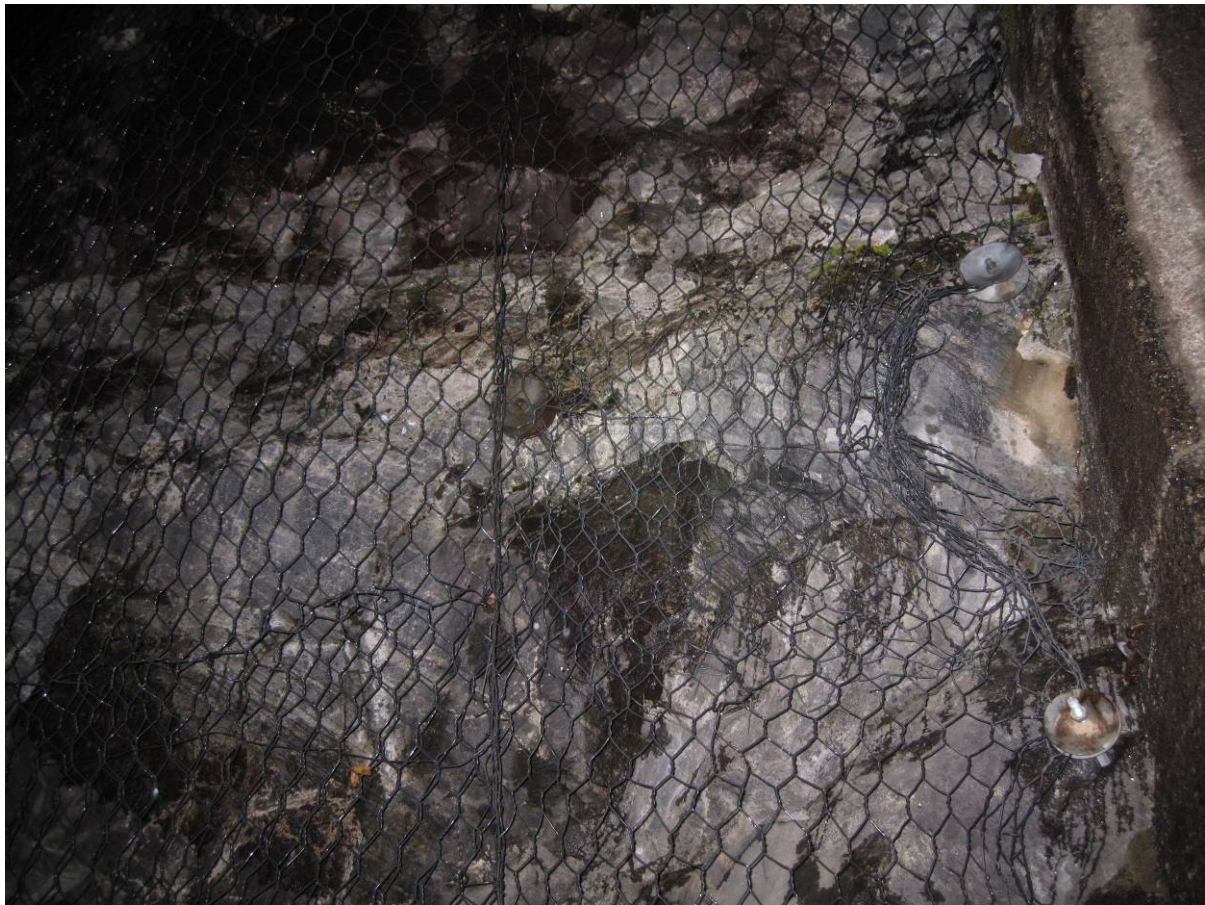
Figur 1.9-1 Isnett ved portal sør. Overflatekorrosjon å se på enkelte festebolter og deler av nett.
