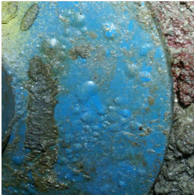
Figur 3 Vabler i pulverlakk (Oslofjordtunnelen)
