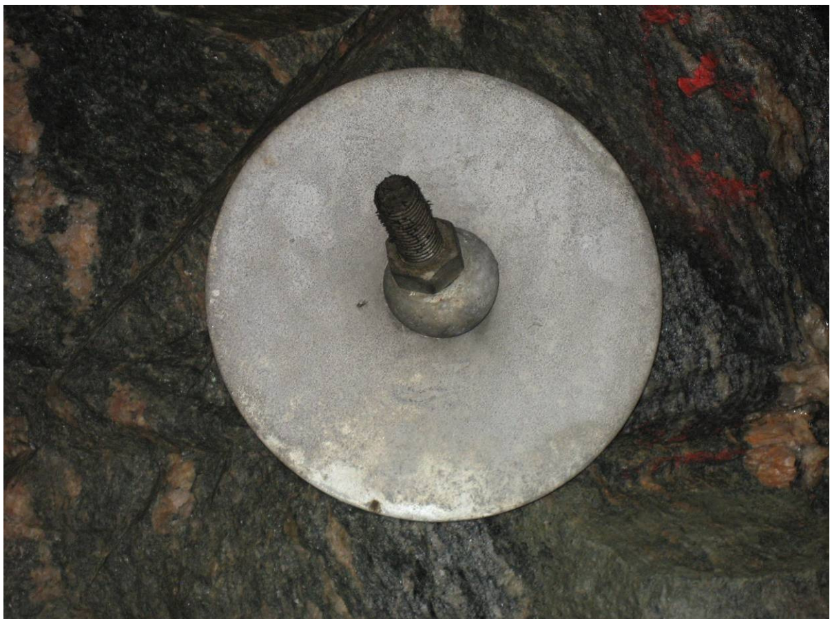
Figur 1.3-6 Skitt og misfarging på bolteende. Ikke synlig korrosjon.
