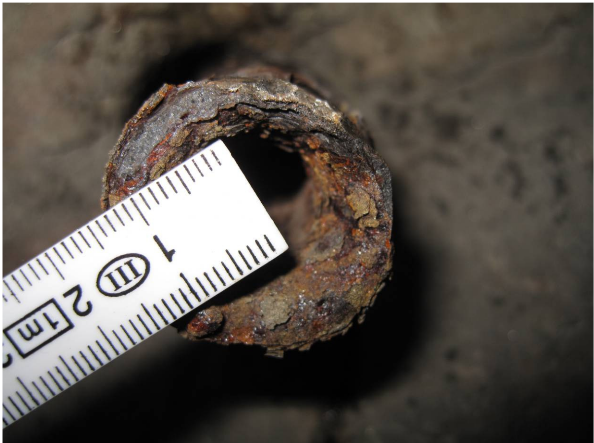
Figur 1.10-8 Swellexbolt 2. Bolteende etter fjerning av rust med geologhammer
