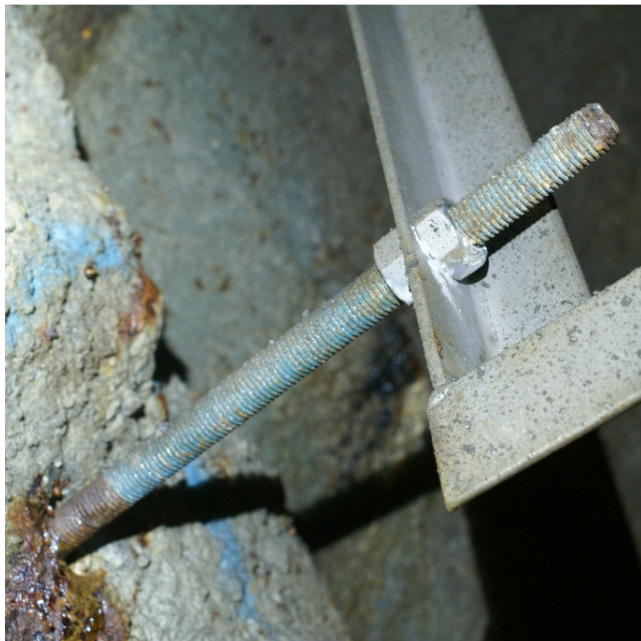
Figur 7 Korrosjon på gjenger, festebolt med dobbel korrosjonsbeskyttelse. Bolteende og delen nærmest berget er mer korrodert enn resten av bolten (Oslofjordtunnelen)
