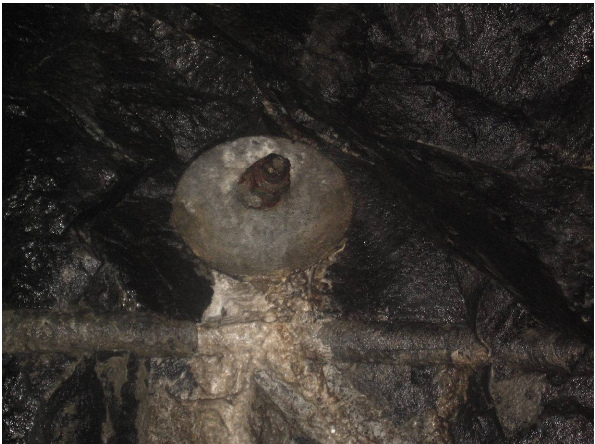
Figur 1.6-26 Kalkutfelling fra boltehull. Korrodert halvkule og mutter
