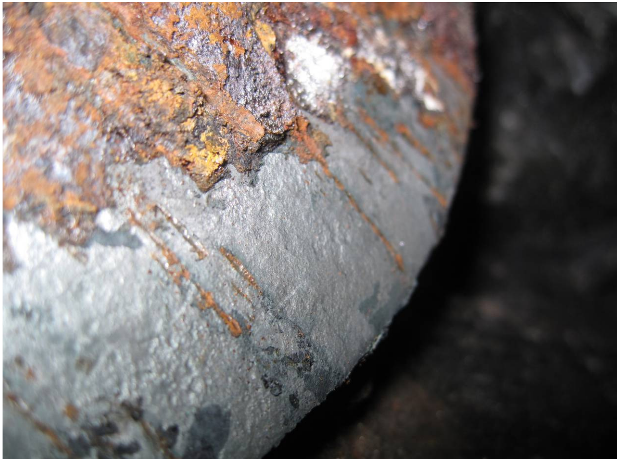
Figur 1.4-10 Bolt 1. Synlig tykkelse på korrosjonen 0,5 – 1,5 mm. Stålet under har fått en ruglete overflate pga. ujevn korrosjon.
