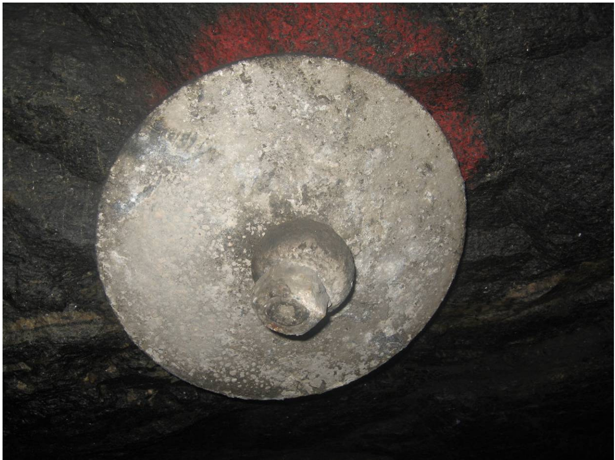
Figur 1.6-32 Lite korrosjon å se på boltedeler, men vablete pulverlakk som skaller av
