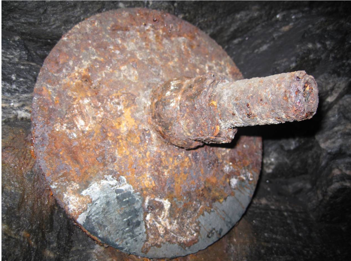
Figur 1.4-7 Bolt 1, etter fjerning av korrosjon på skive med geologhammer
