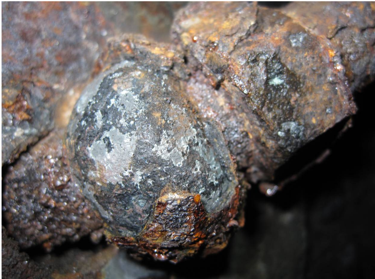
Figur 1.4-22 Bolt 5. Korrosjon på halvkule. Reststål synlig etter at korrosjonslaget er slått vekk med geologhammer
