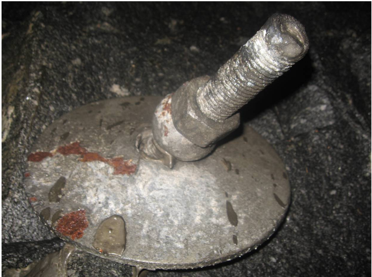
Figur 1.6-18 Korrosjon på enkelte punkter på skive og halvkule
