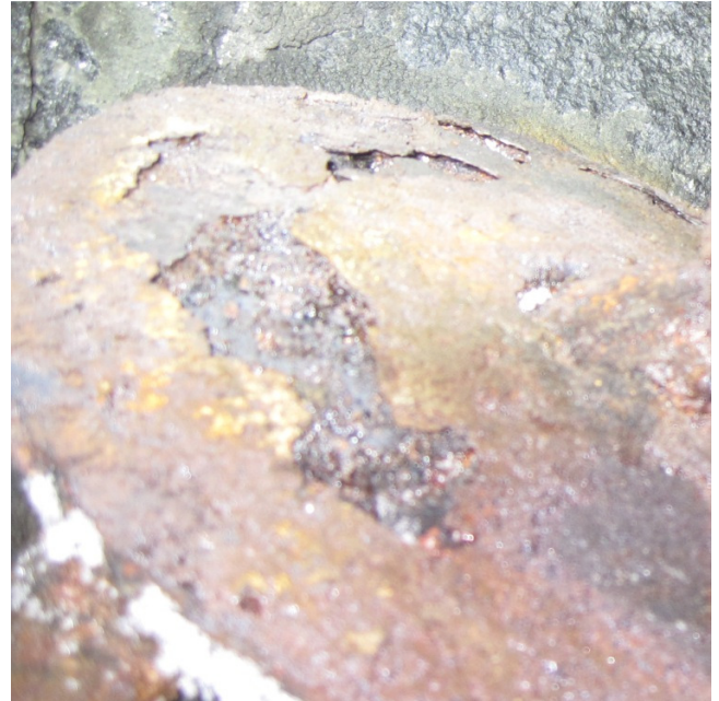
Figur 16 Dyptgående korrosjon på bolteskive. Korrosjonslaget er lagdelt, og med mye luft mellom lagene. Deler av rustlagene har skallet av (Ellingsøytunnelen)
