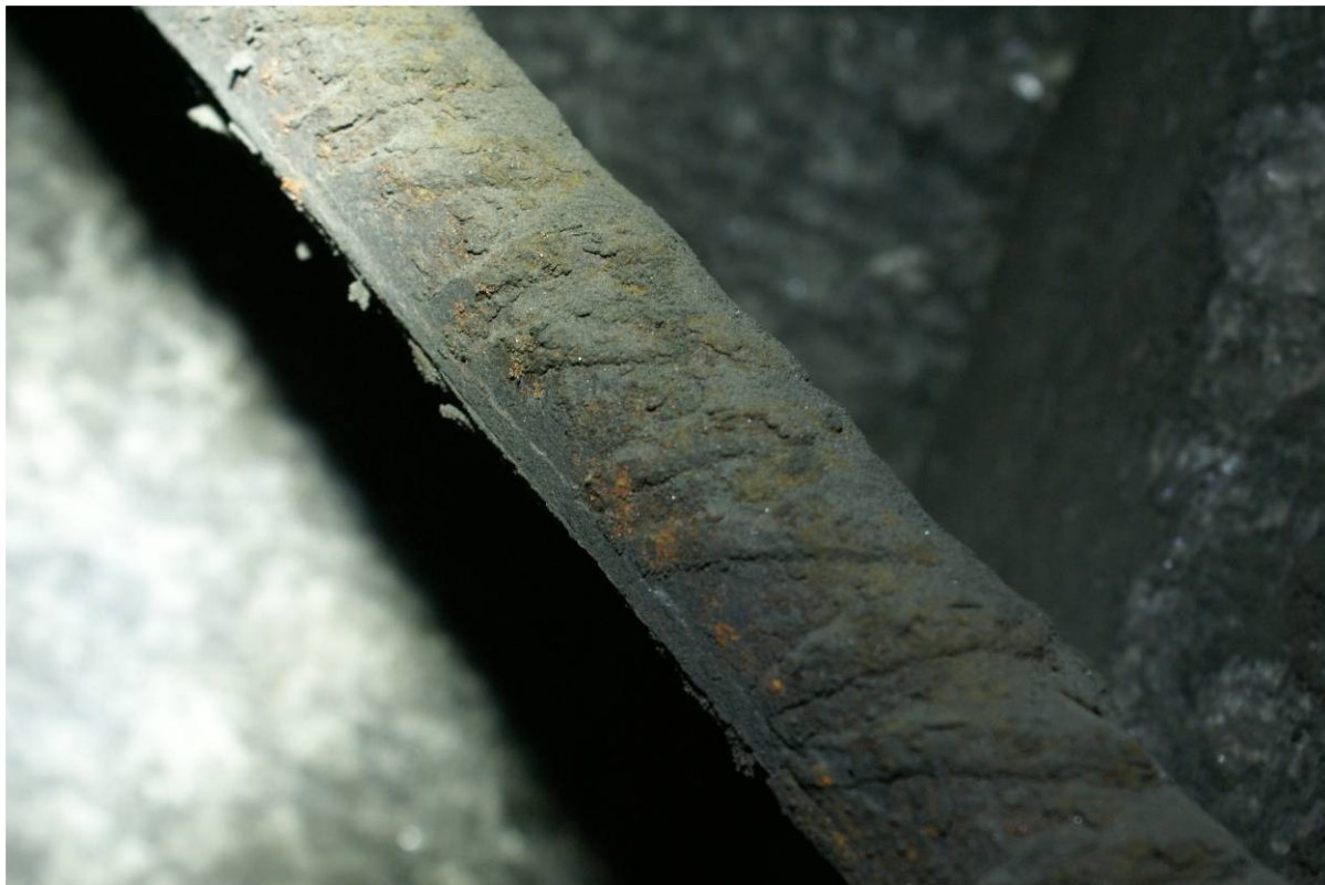
Figur 1.1-10 Kamstålbolt for oppheng i drivefasen, korrodert og dekket med vegstøv. Korrosjonsprodukter ligger som løse, tynne radielle flak rundt bolten som smuldrer opp.
