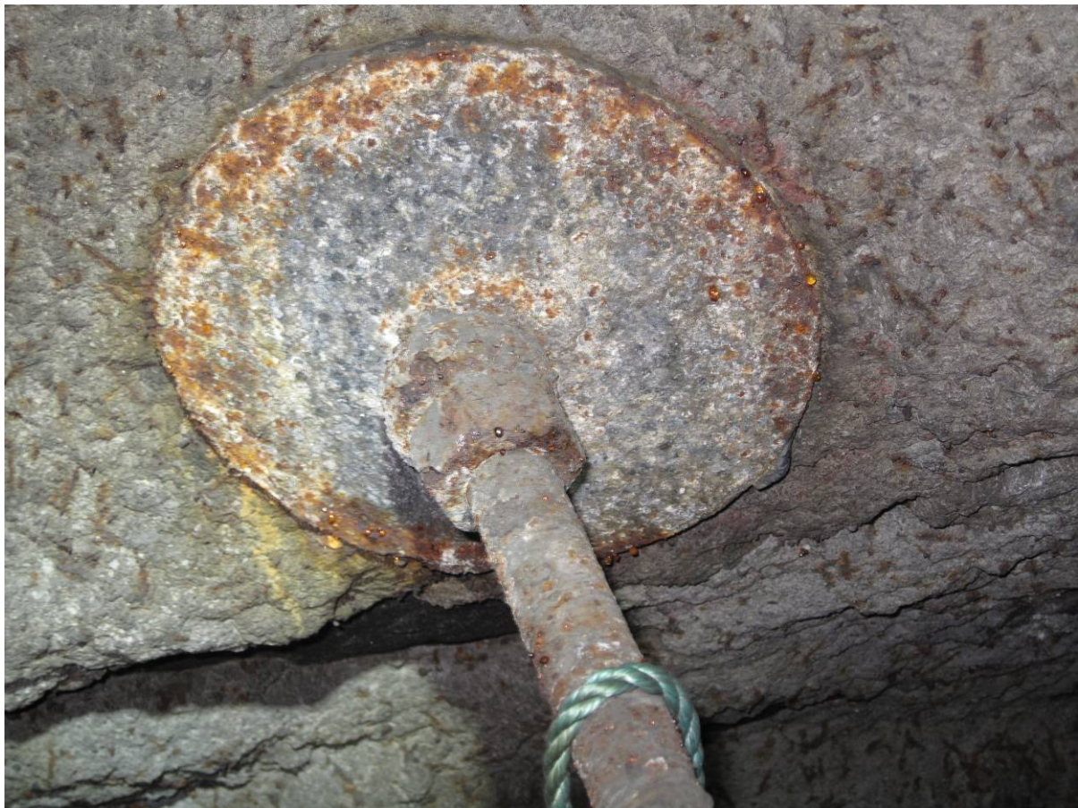
Figur 1.4-28 Bolt 11, en av de med minst korrosjon i pumpestasjonen.
