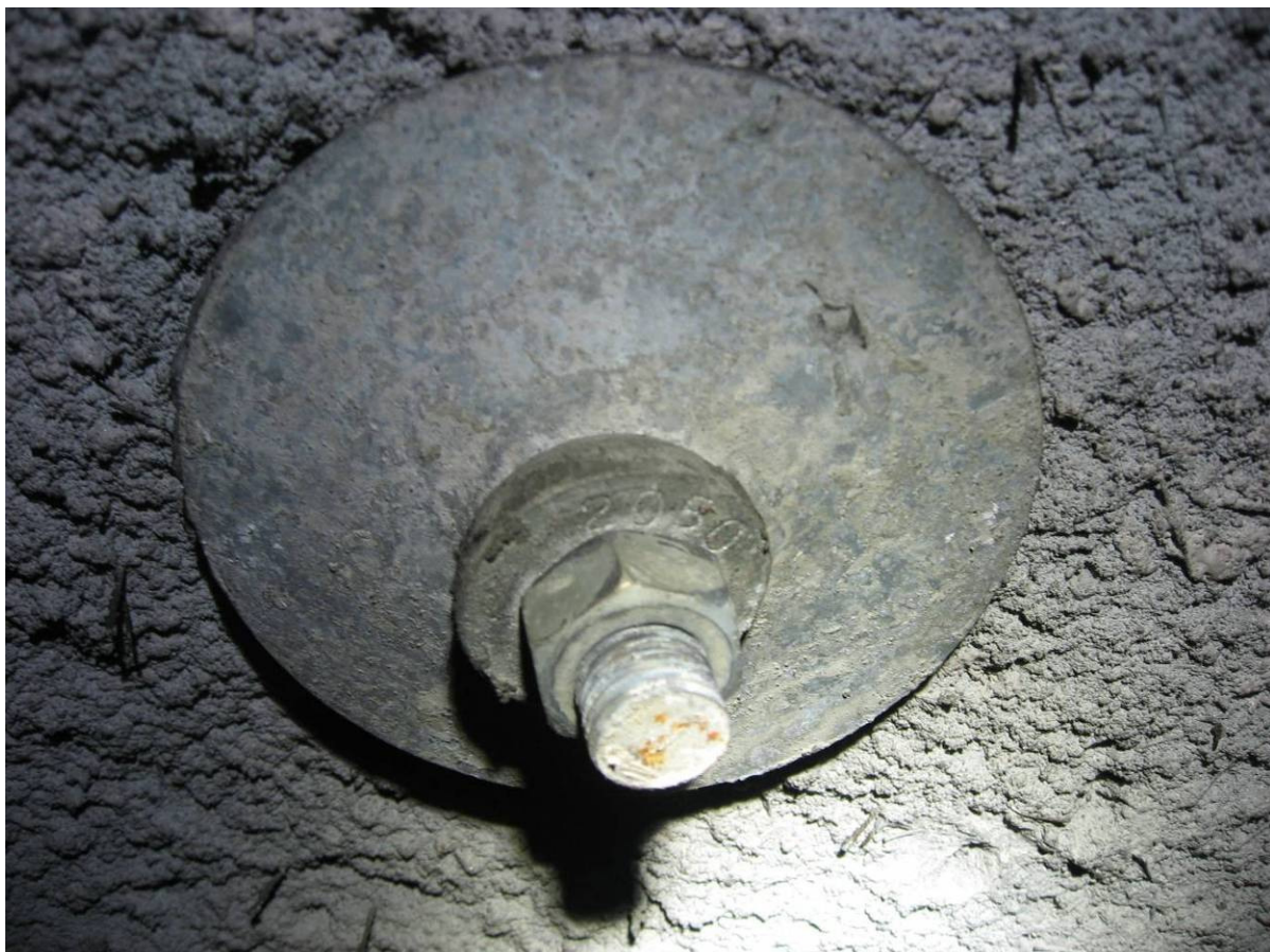
Figur 1.12-2 Beskjeden misarging av bolteende. Ellers ikke noe å se
