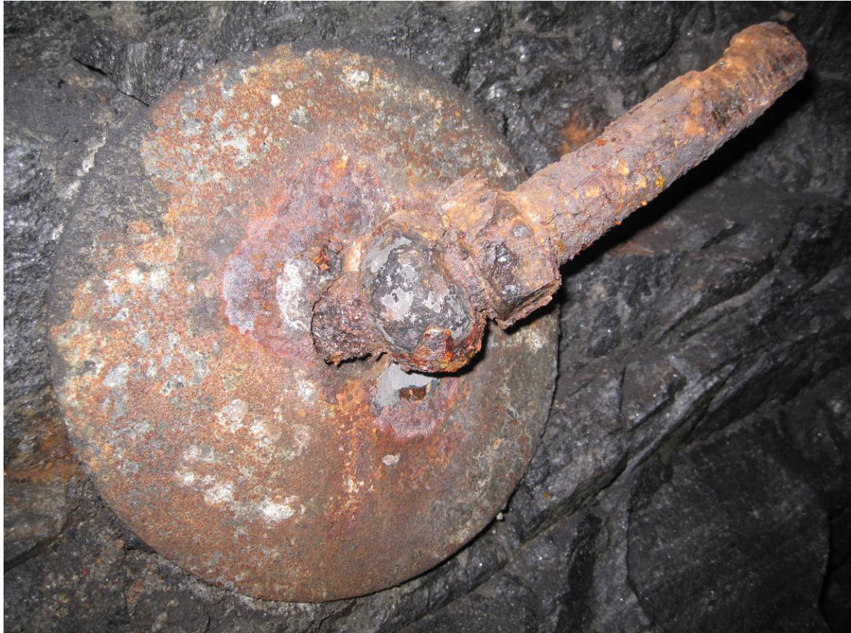
Figur 1.4-21 Bolt 5. Etter korrosjon på halvkule og på bolteende er slått vekk med geologhammer
