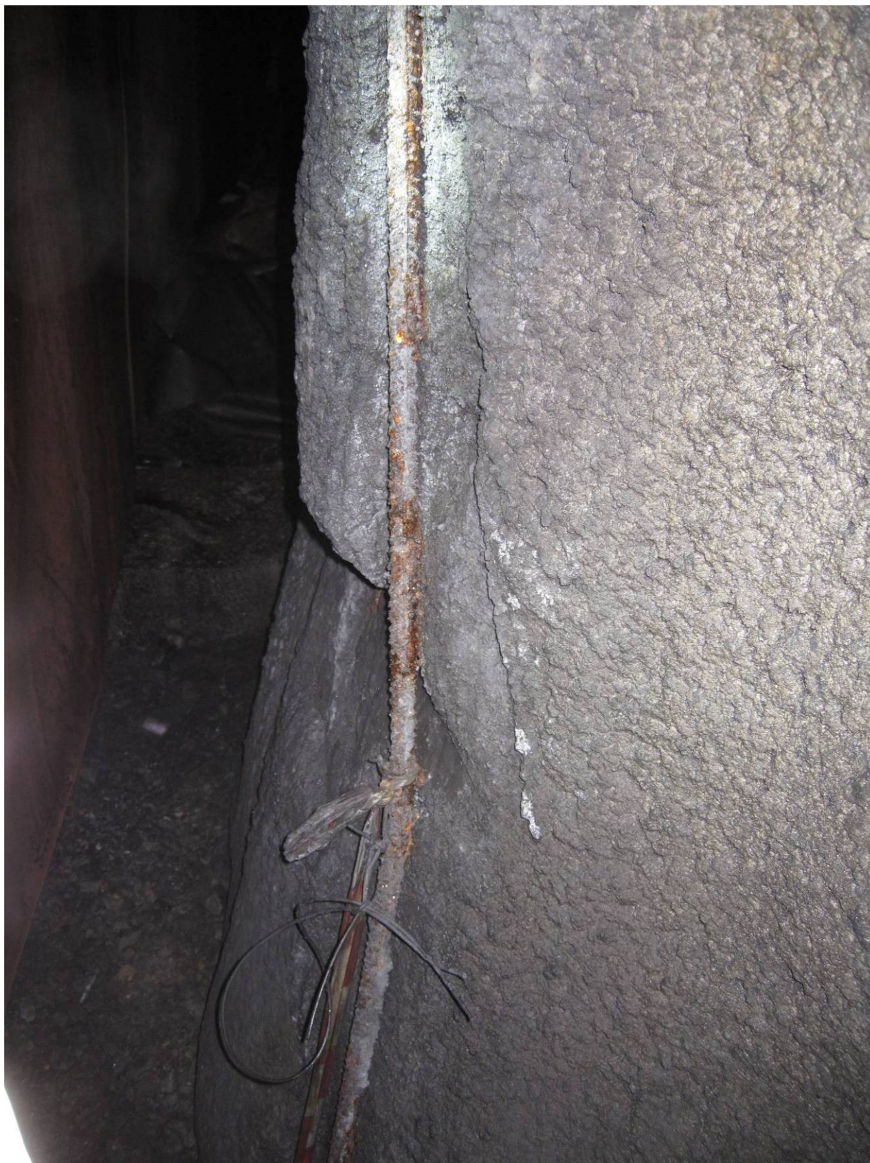
Figur 1.2-13 Eksponert kamstål i sprøytebetongbue
