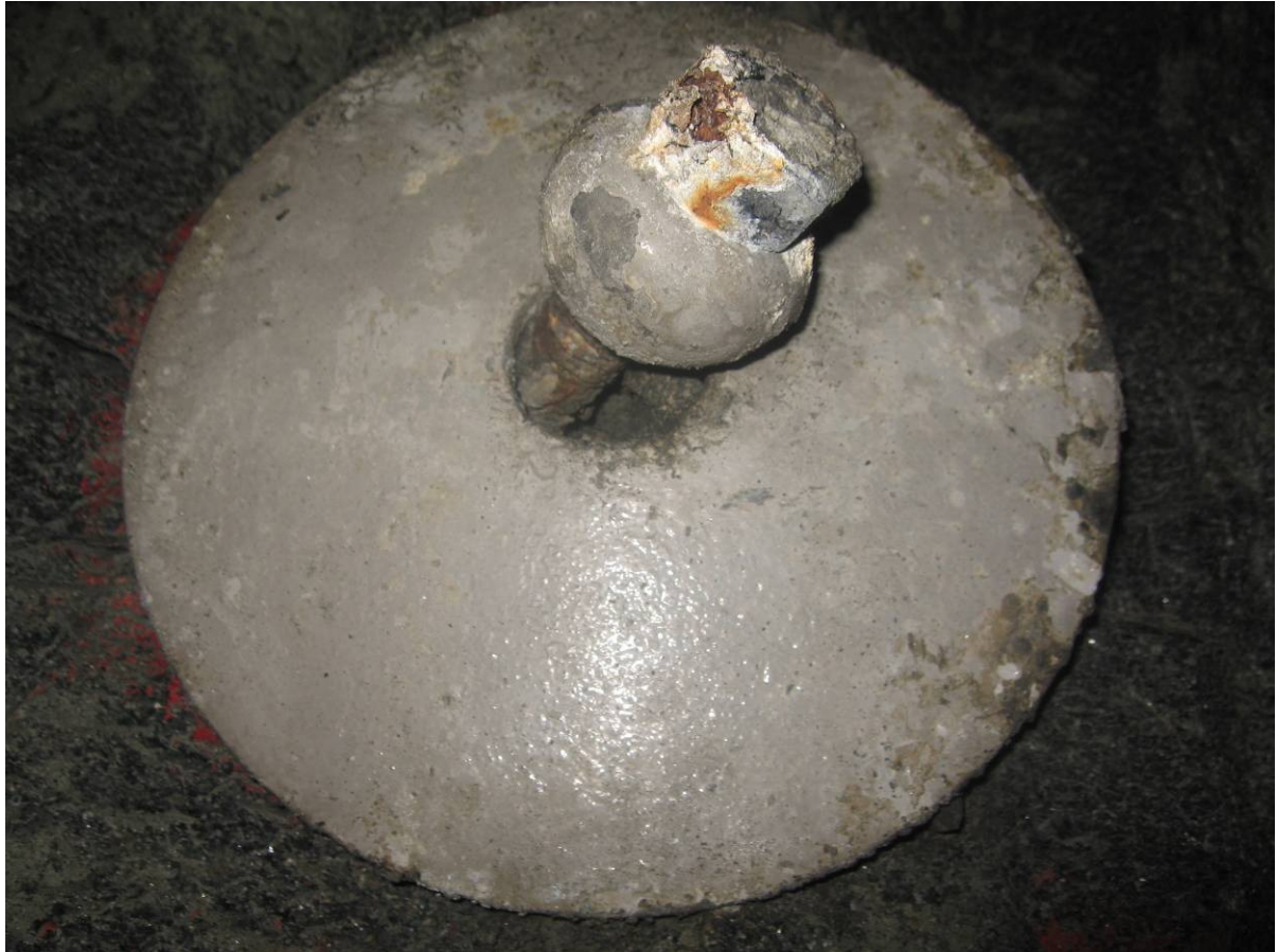
Figur 1.6-31 Gropkorrosjon på mutter, korrosjon på gjenger, småvablete pulverlakk på skive
