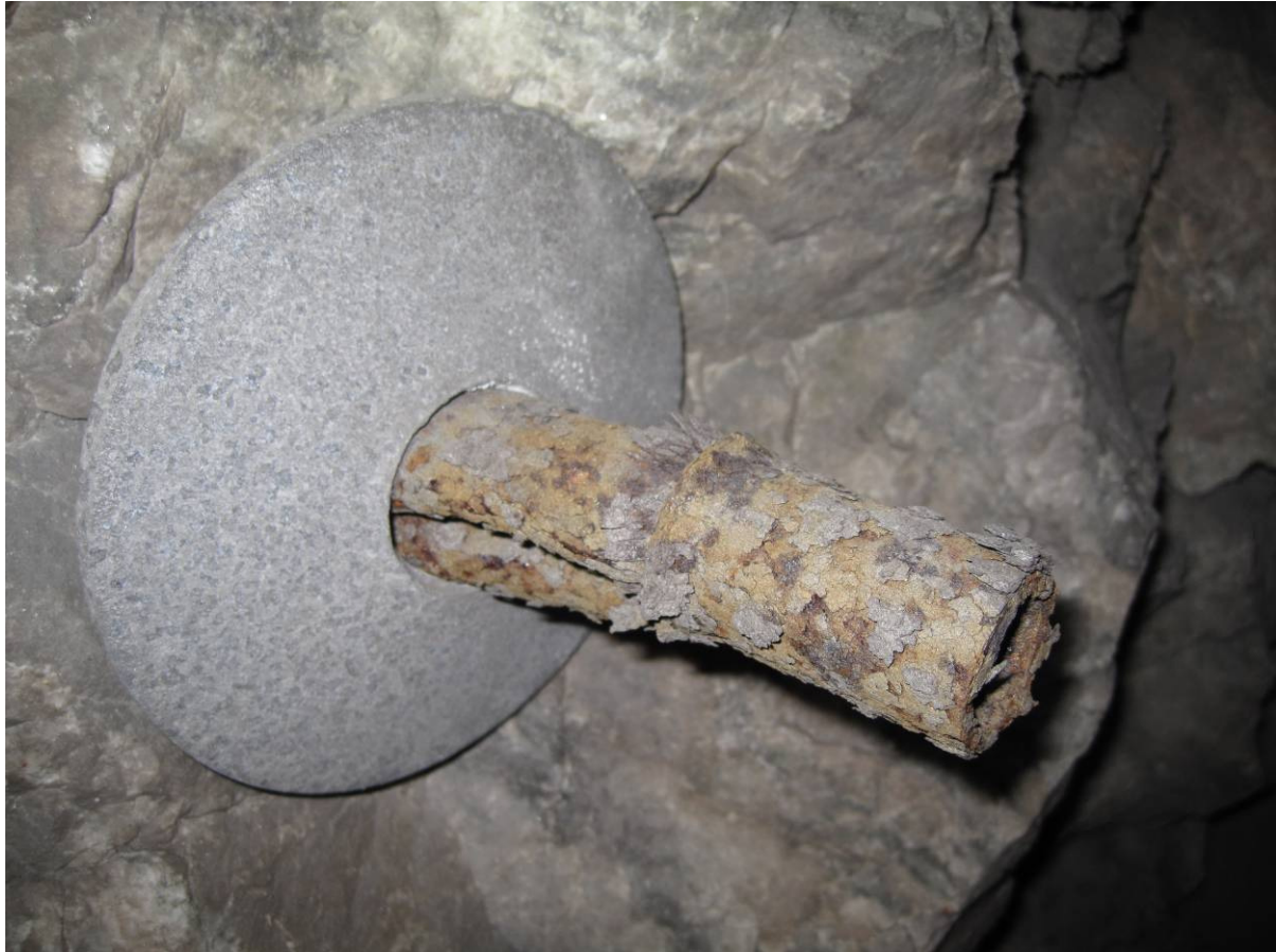
Figur 1.10-3 Swellexbolt 1. Påfallende at skiva ikke er det minste misfarget mens bolten omtrent er oppspist
