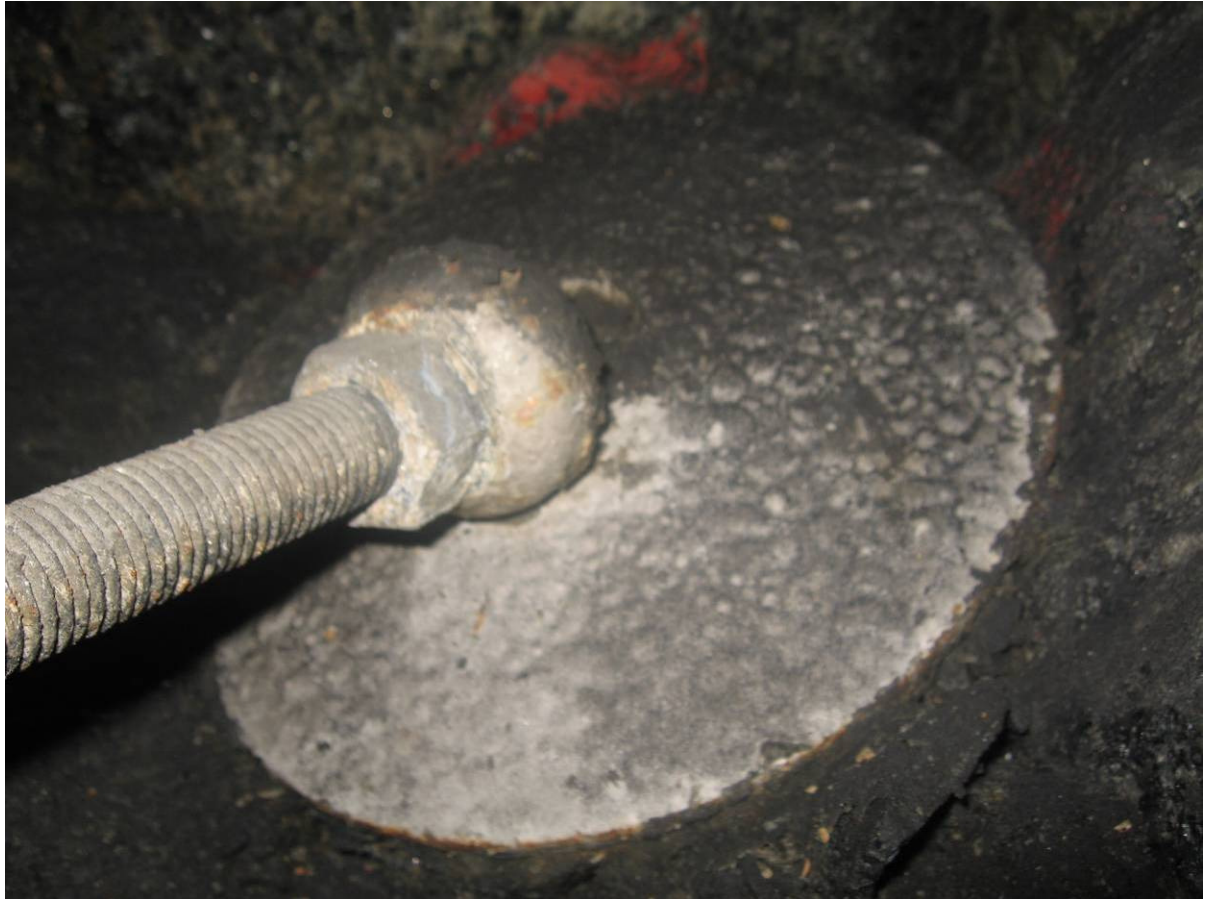
Figur 1.6-33 Bolt 1. Gulbrun rustfarge på pulverlakk som er veldig vablete
