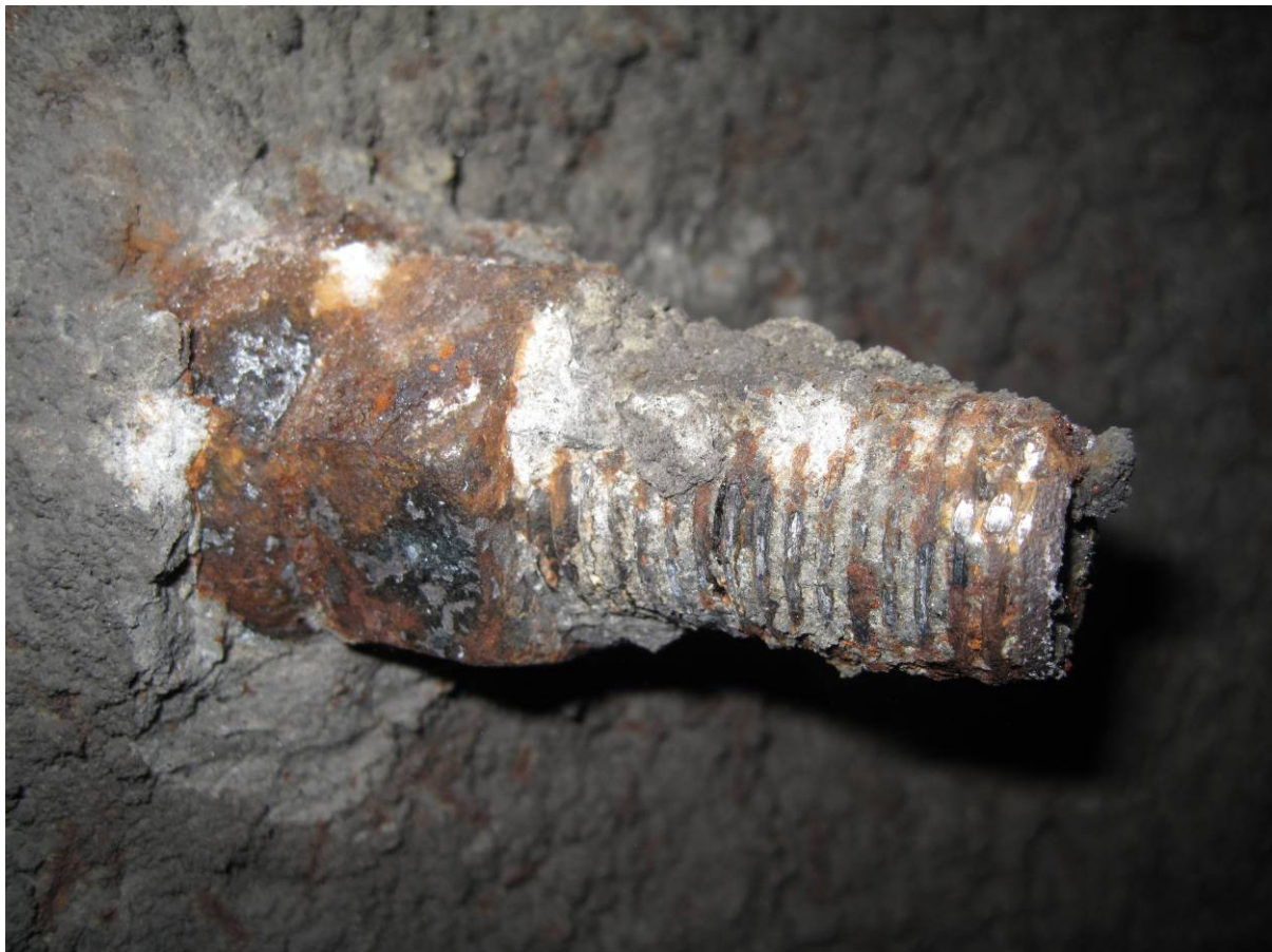
Figur 1.5-20 Bolt 10 Bolteende etter fjerning av løs korrosjon med geologhammer
