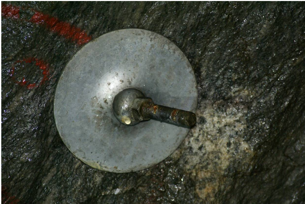
Figur 1.2-1 Bolt i fuktig parti. Synlig vann og kondens på bolt. Korrosjon på deler av utstikkende bolteende, misfarging på halvkule.
