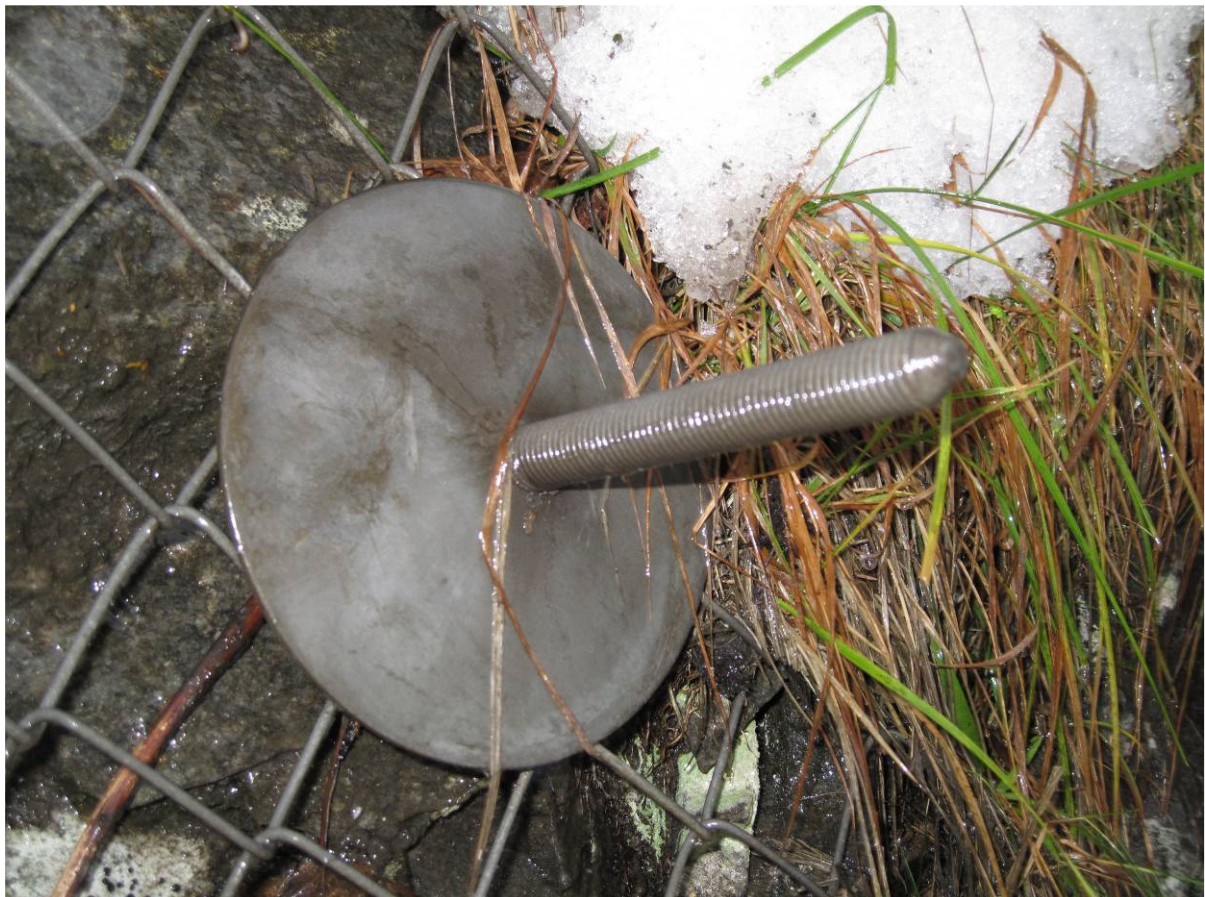
Figur 1.7-4 Festebolt og flettverksnett. Noe brunfarge på bolteskive
