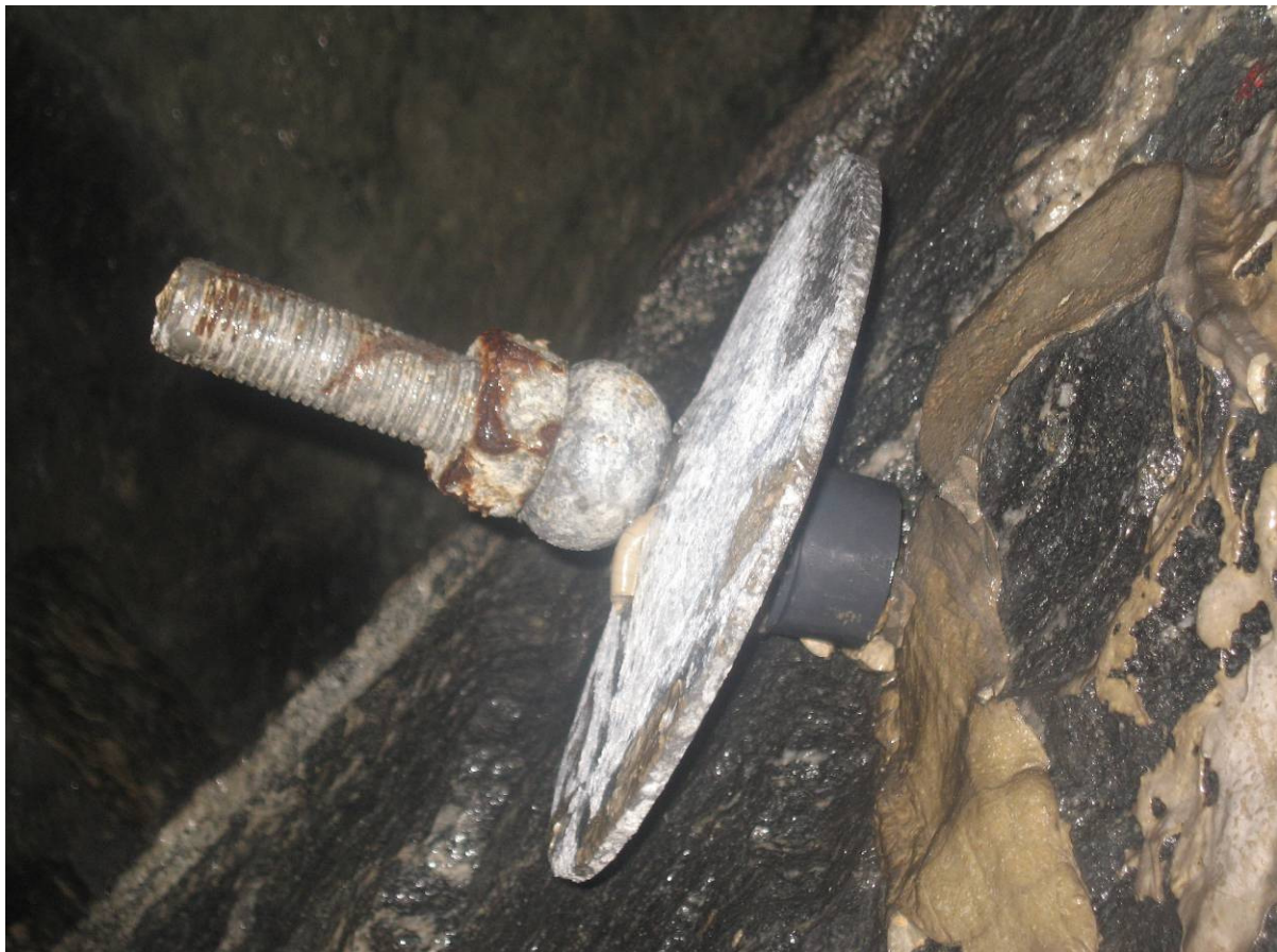
Figur 1.6-2 Annen bolt med noe mer korrosjon på bolt og mutter
