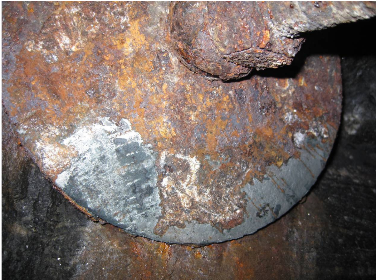
Figur 1.4-8 Bolt 1, synlig rustutfelling fra boltehullet bak skiva.
