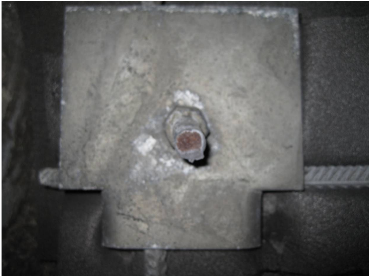
Figur 1.7-14 Korrosjon på boltetupp
