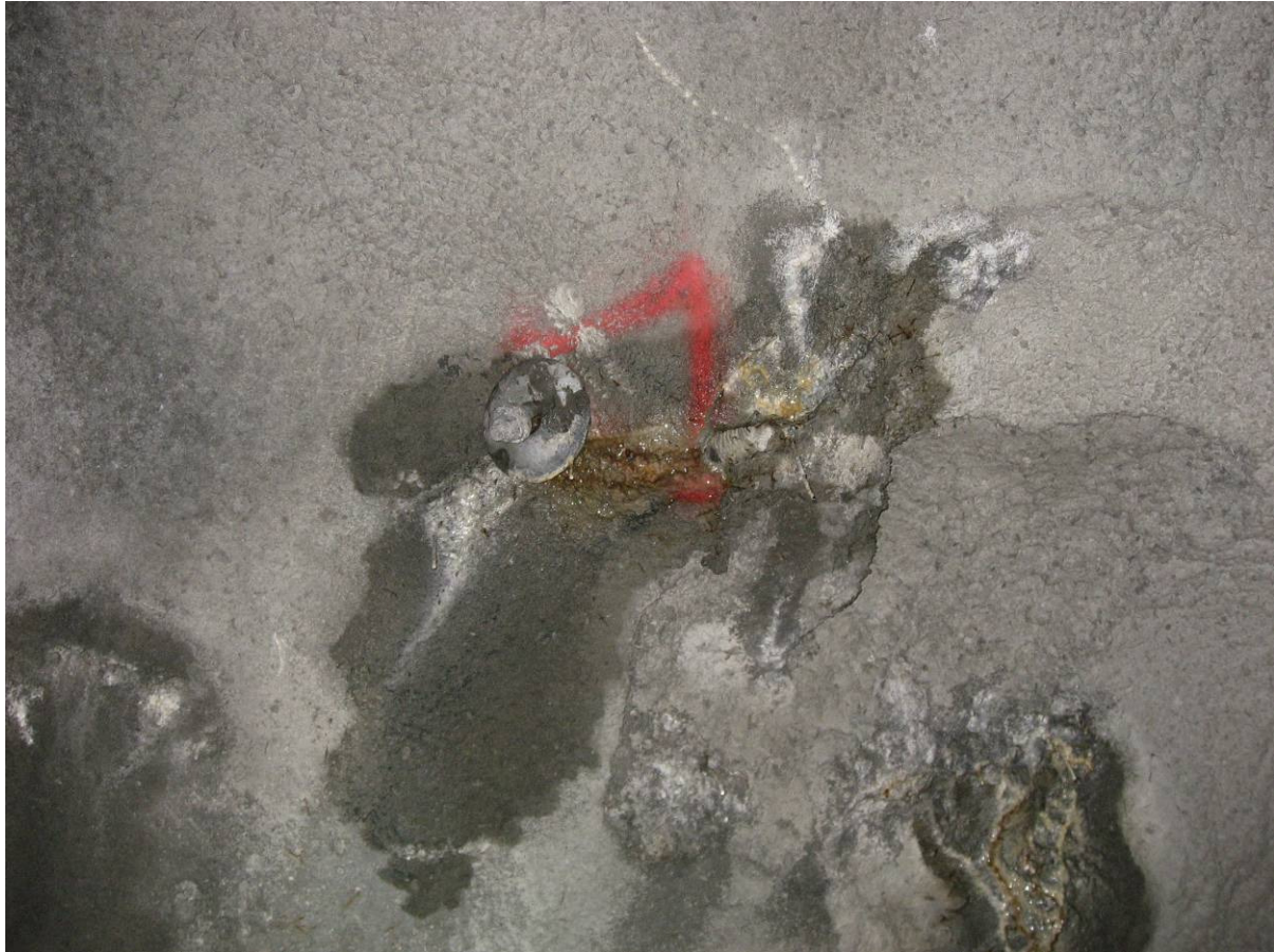
Figur 1.12-3 Fukt og rustutfelling fra bergmassen. Ikke korrosjon å se på bolt
