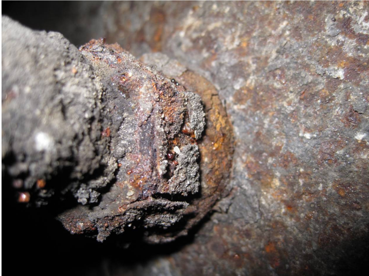
Figur 1.5-15 Bolt 8. Korrodert mutter
