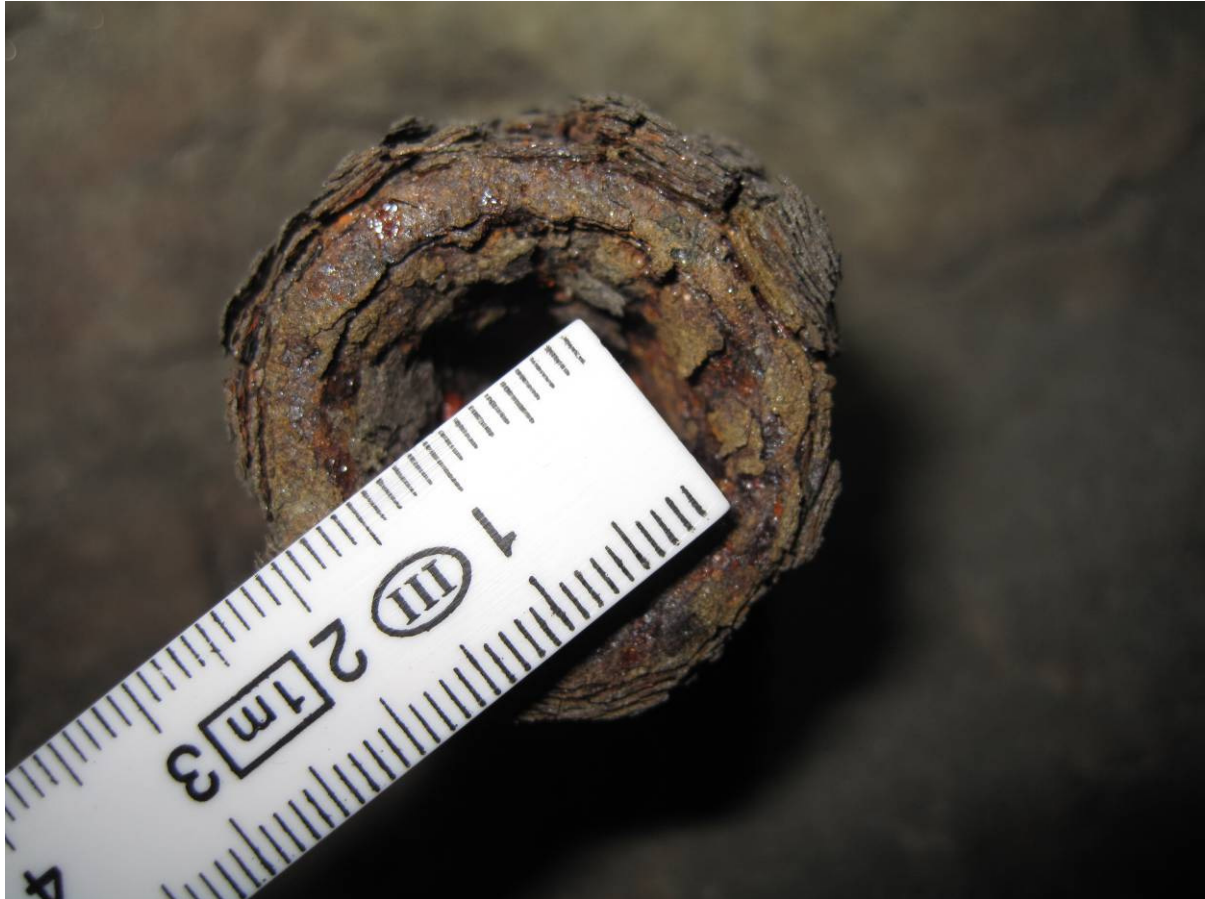
Figur 1.10-7 Swellexbolt 2. Bolteende før fjerning av rust med geologhammer
