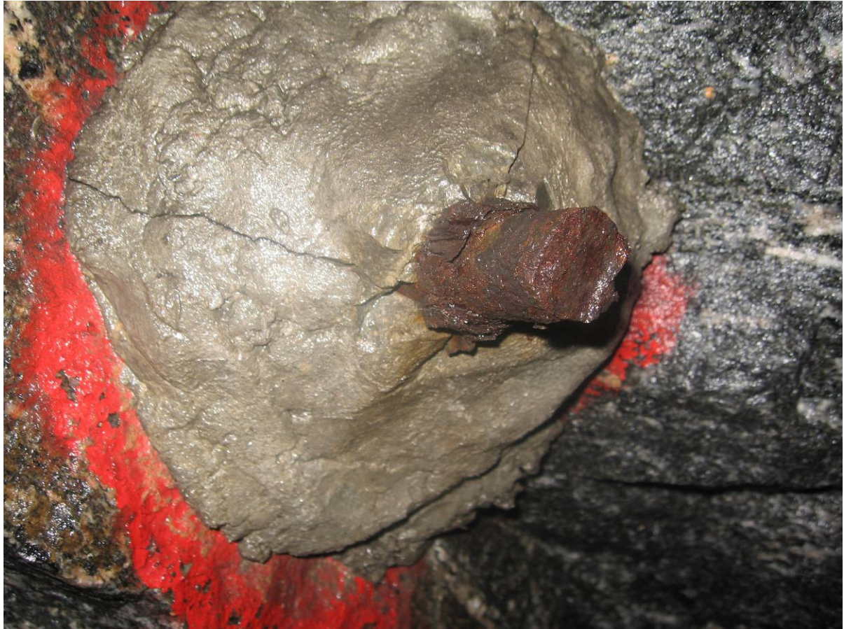
Figur 1.6-15 Korrosjonsangrepet fullt innstøpt bolt. Mørtelen har sprukket opp, trolig pga av korrosjon av ytterste del av inngyst bolt. Avskalling av korrosjonsprodukter fra den innstøpte bolten.
