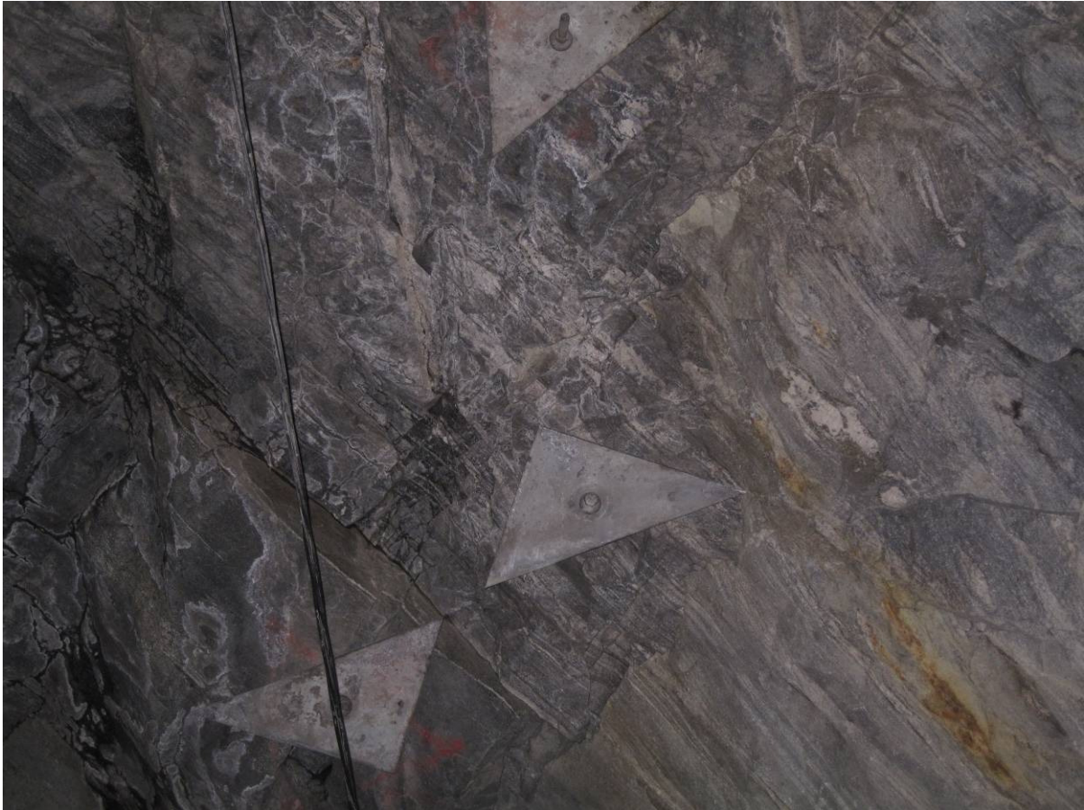
Figur 1.9-9 Noe misfarging av trekantplater
