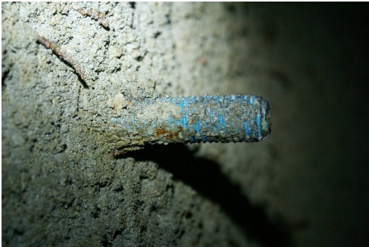
Figur 1.1-4 Utstikkende bolteende med lett korrosjon på tupp og på gjenger.
