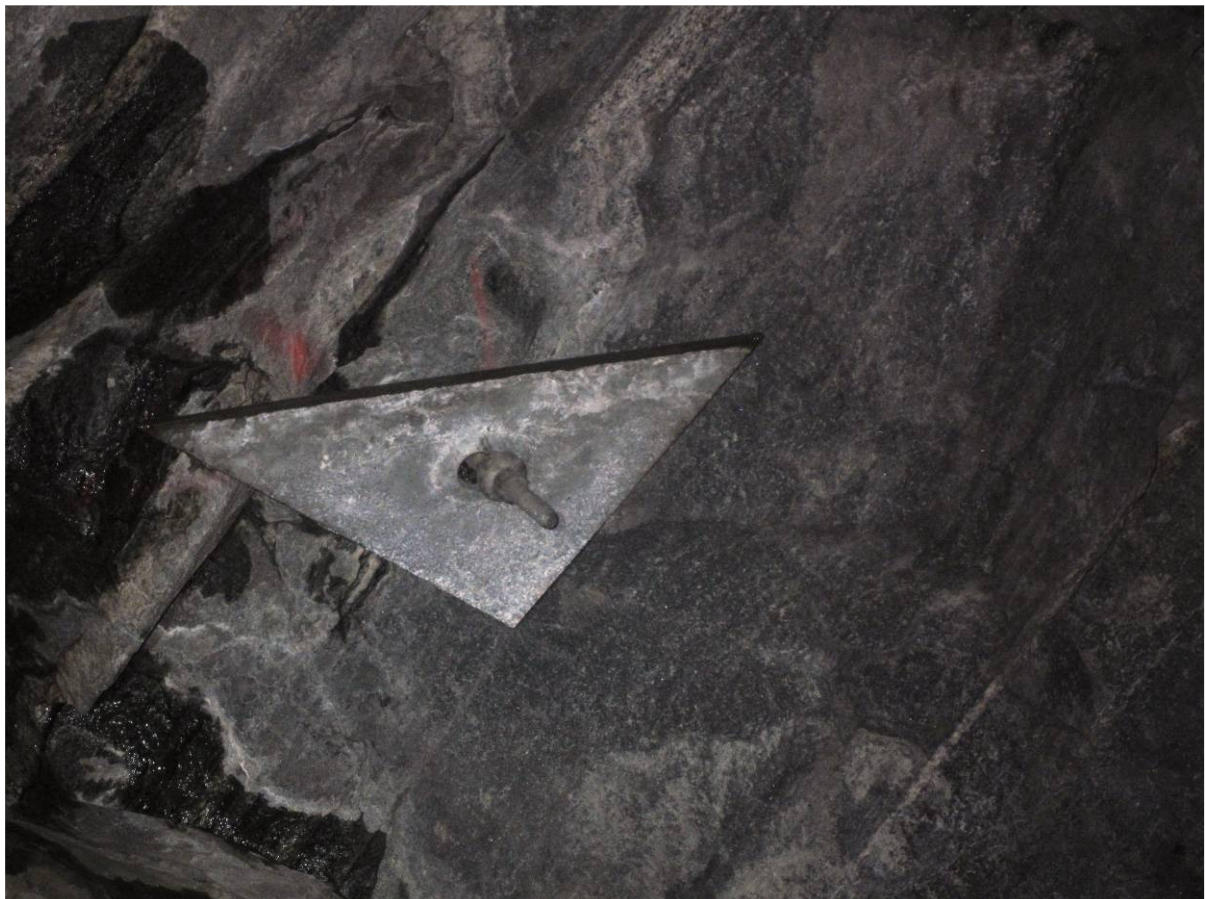
Figur 1.9-8 Fukt, men ikke misfarging av bolt eller trekantplate
