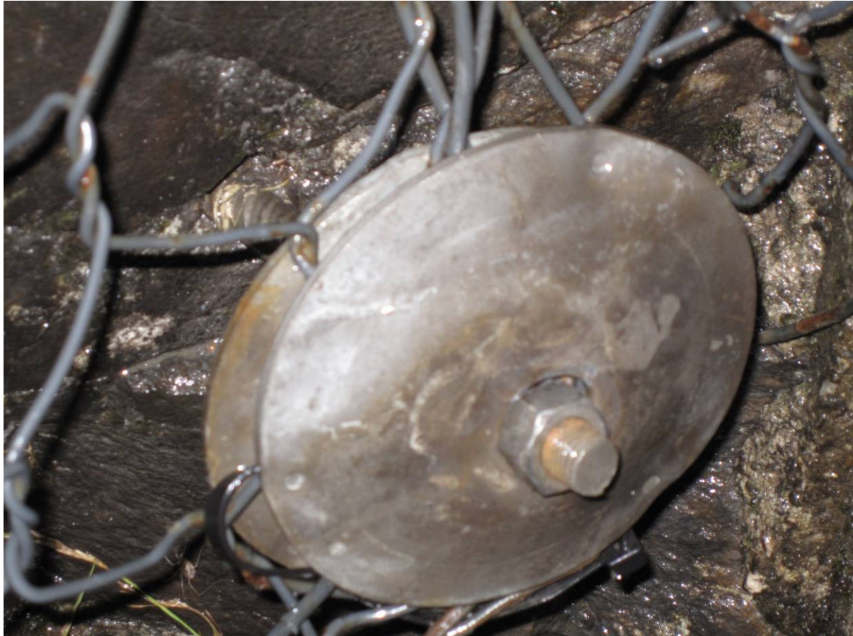
Figur 1.9-5 Misfarging på skive og bolt, og noe punktkorrosjon på nett
