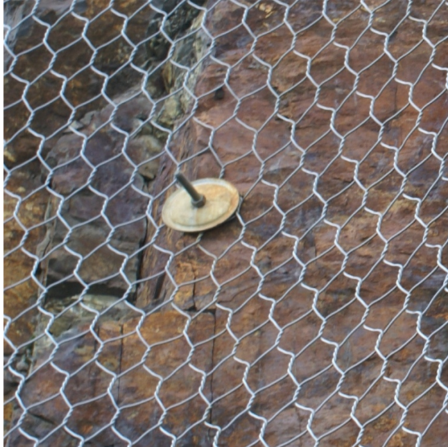
Figur 1 Misfarging av bolt. Misfarging av stålet i dette tilfelle kan skyldes oksidering av kisholdig berg (Fv. 33)
