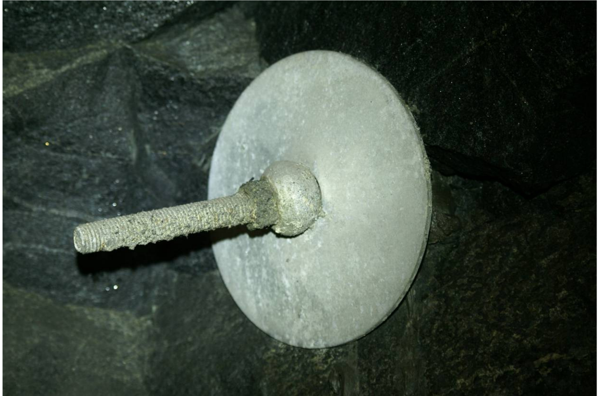
Figur 1.2-7 Bolt uten synlig korrosjon. Sprøytebetongfragmenter på utstikkende bolteende
