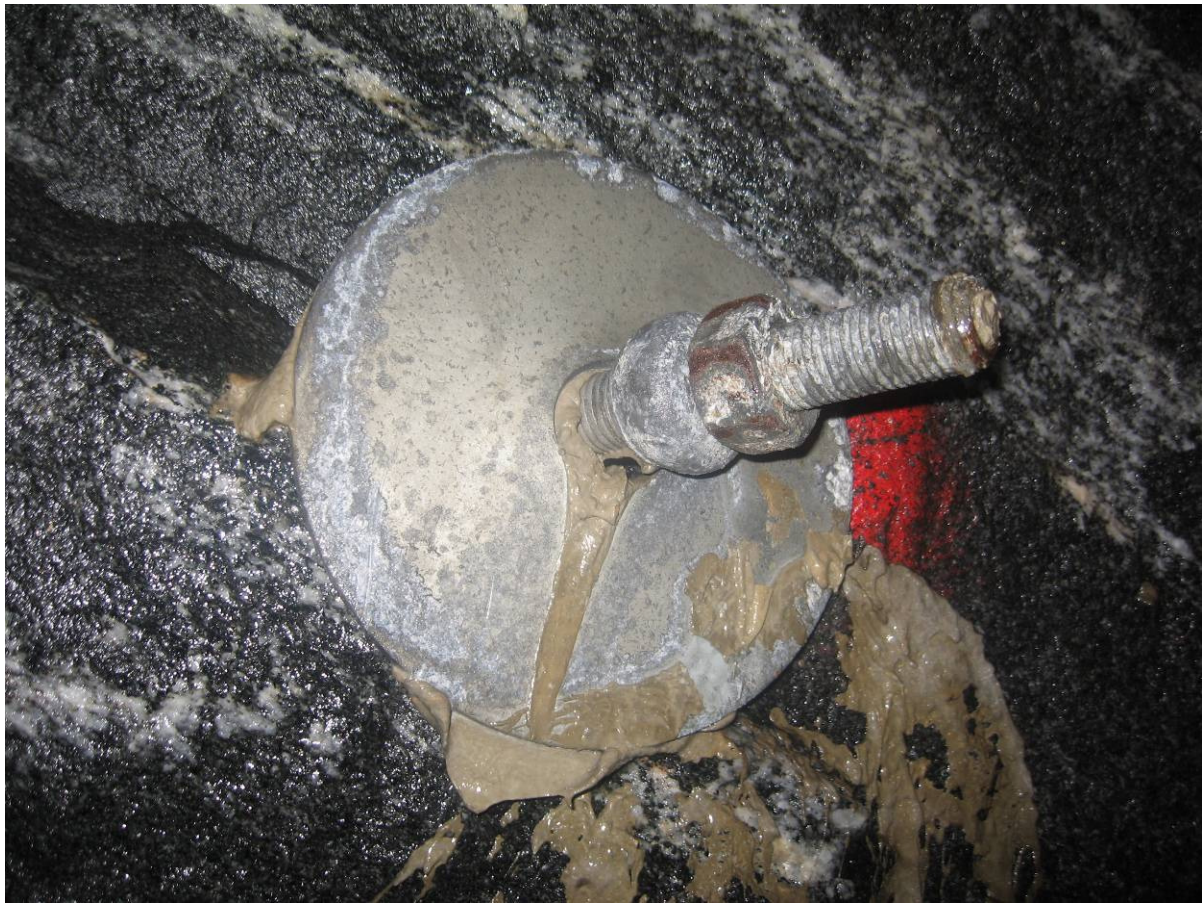
Figur 1.6-1 Rørbolt med mørtelsøl og korrosjon på mutter og bolteende
