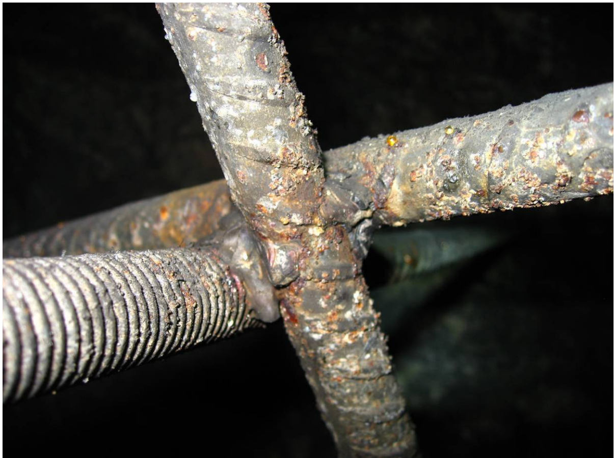
Figur 1.3-10 Punktkorrosjon på kamstål for feste av vann- og frostsikring
