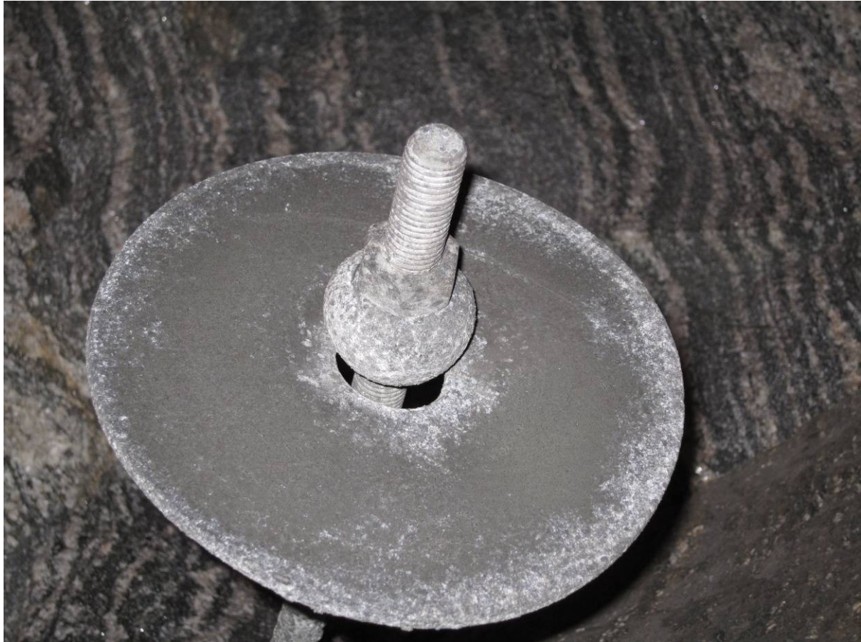
Figur 1.7-9 Hvitspetting på ståloverflater, men ellers ikke noe å se
