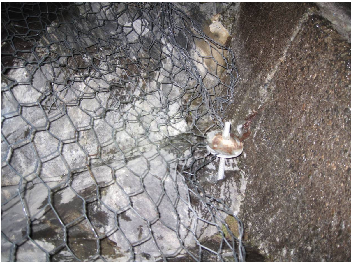
Figur 1.9-2 Noe korrosjon på enkelte festebolter og deler av nett
