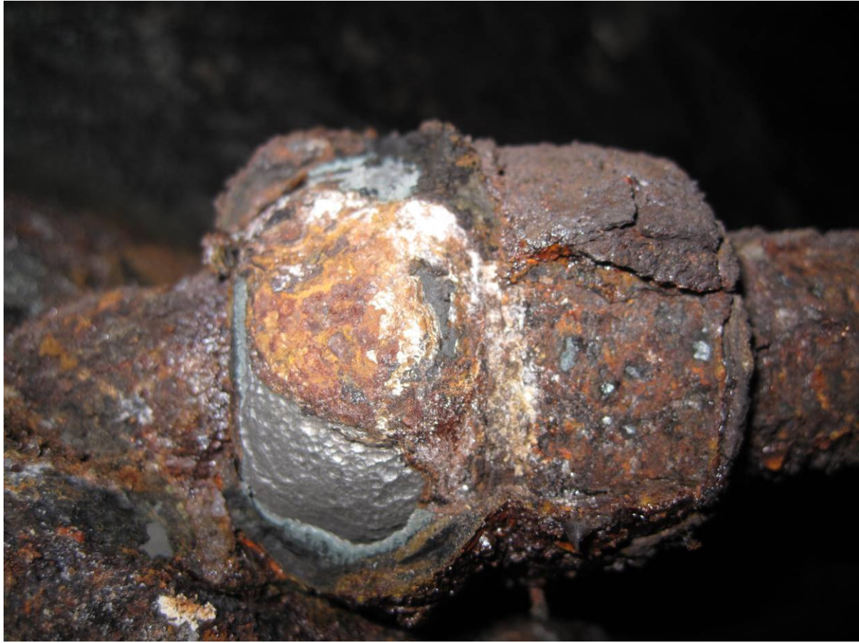
Figur 1.4-15 Bolt 4. Synlig groper i underliggende stål og tykt lag korrosjonsprodukter (~ 4 mm)
