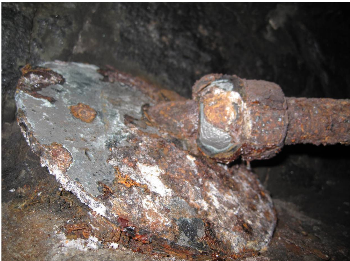
Figur 1.4-14 Bolt 4, etter at løst korrosjonsmateriale er slått vekk med geologhammer. Målt tykkelse på korrosjonslaget opptil 4 mm.
