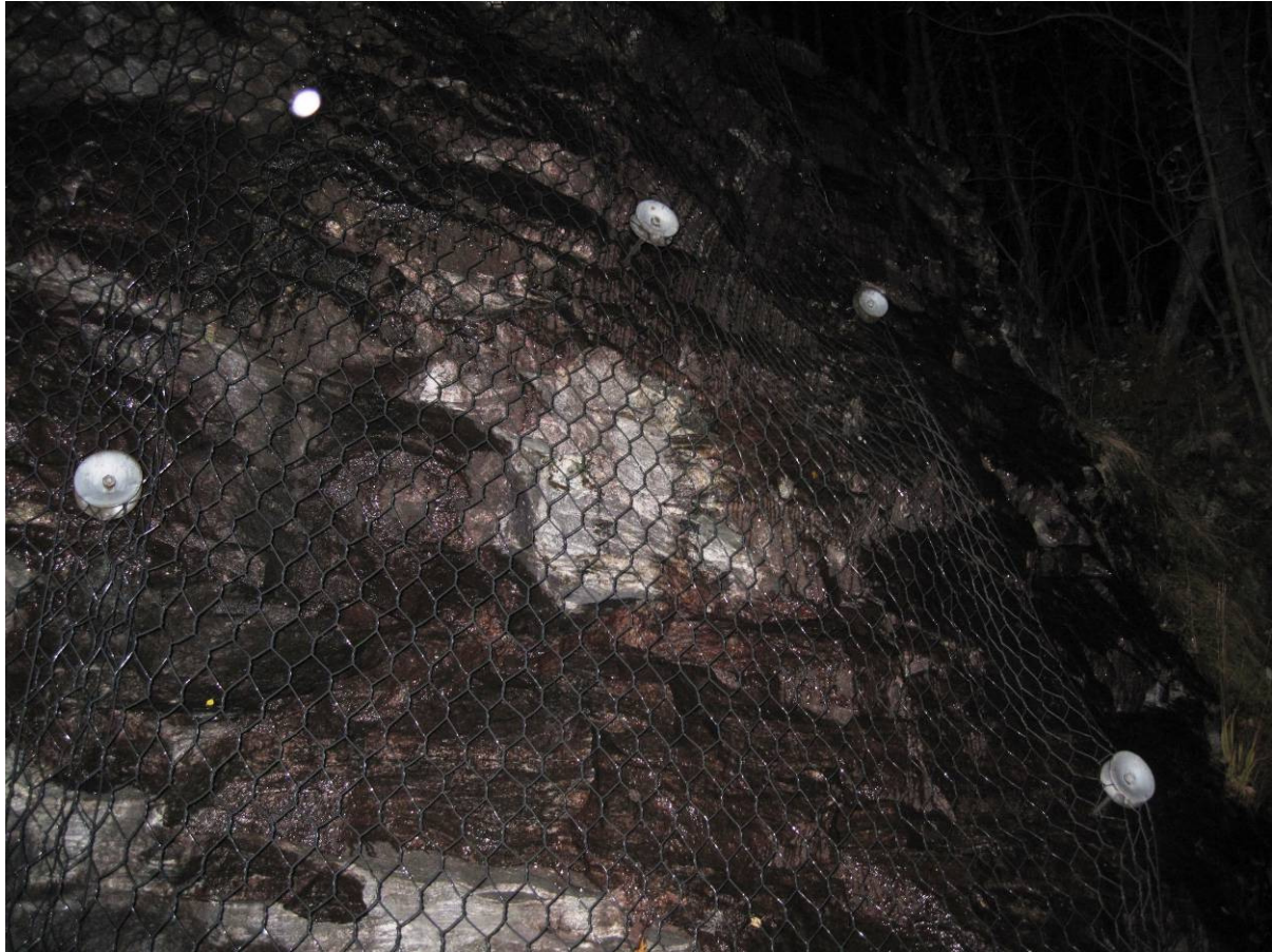
Figur 1.9-11 Portal nord. Fuktig berg, beskjeden misfarging av enkelte skiver og korrosjon på steinsprangnettet enkelte steder
