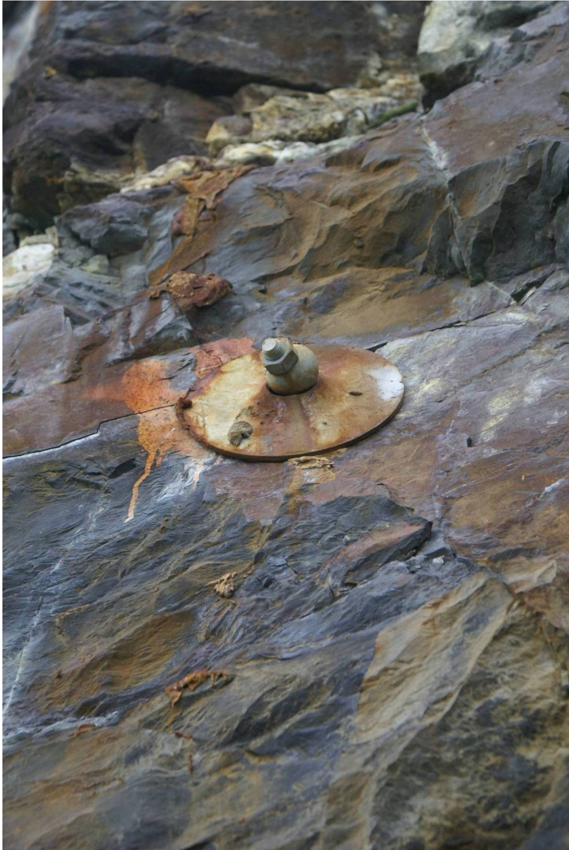
Figur 2.1-6 Korrodert bolteskive, misfarging på mutter, bolt og halvkule
