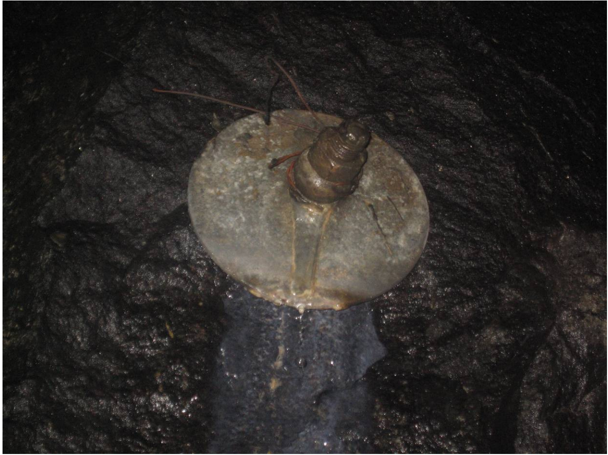
Figur 1.6-25 Bolt med tydelig vannlekkasje fra boltehullet, men bare beskjeden misfarging av boltestålet.
