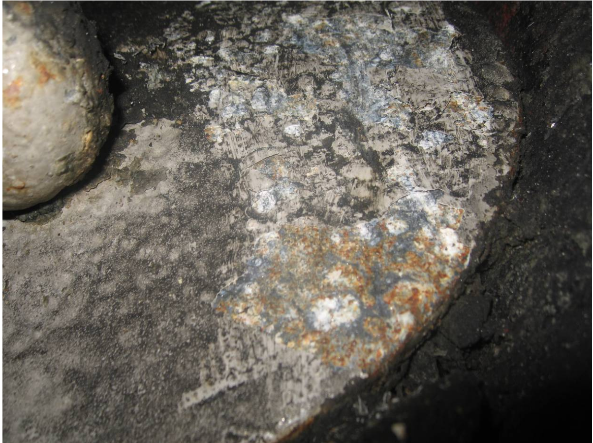
Figur 1.6-35 Bolt 1. Avskraping av pulverlakk avslører vannlommer og korrosjon på boltestålet
