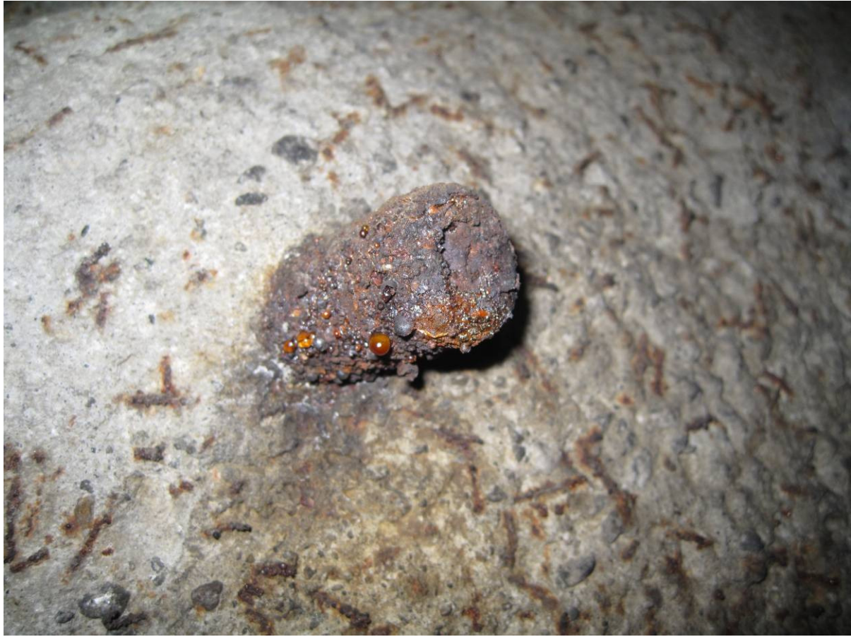
Figur 1.4-27 Bolt 9 Fullt innstøpt og fullstendig dekket av korrosjon i utstikkende del
