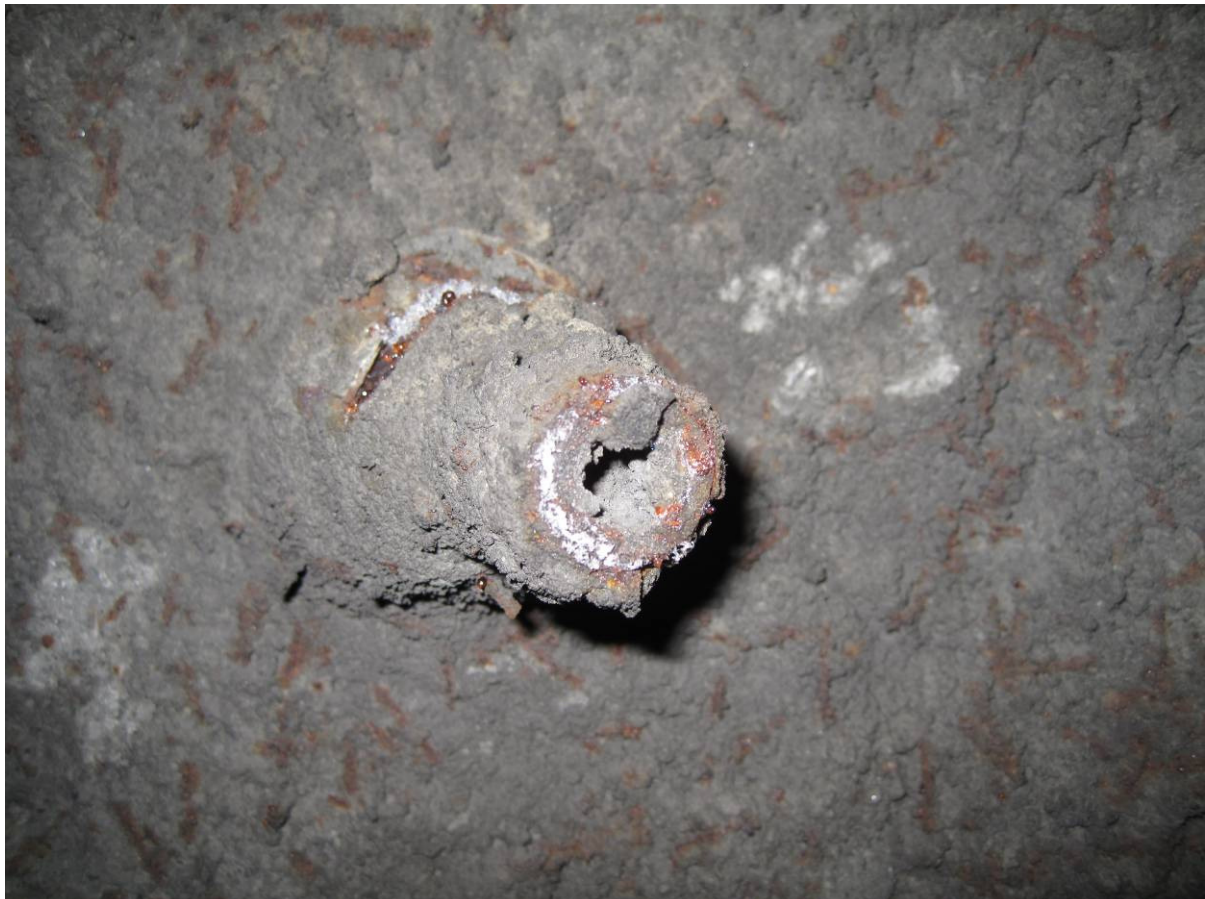
Figur 1.5-4 Bolt 1. Innsprøytet rørbolt med korrosjon på eksponerte stålfater
