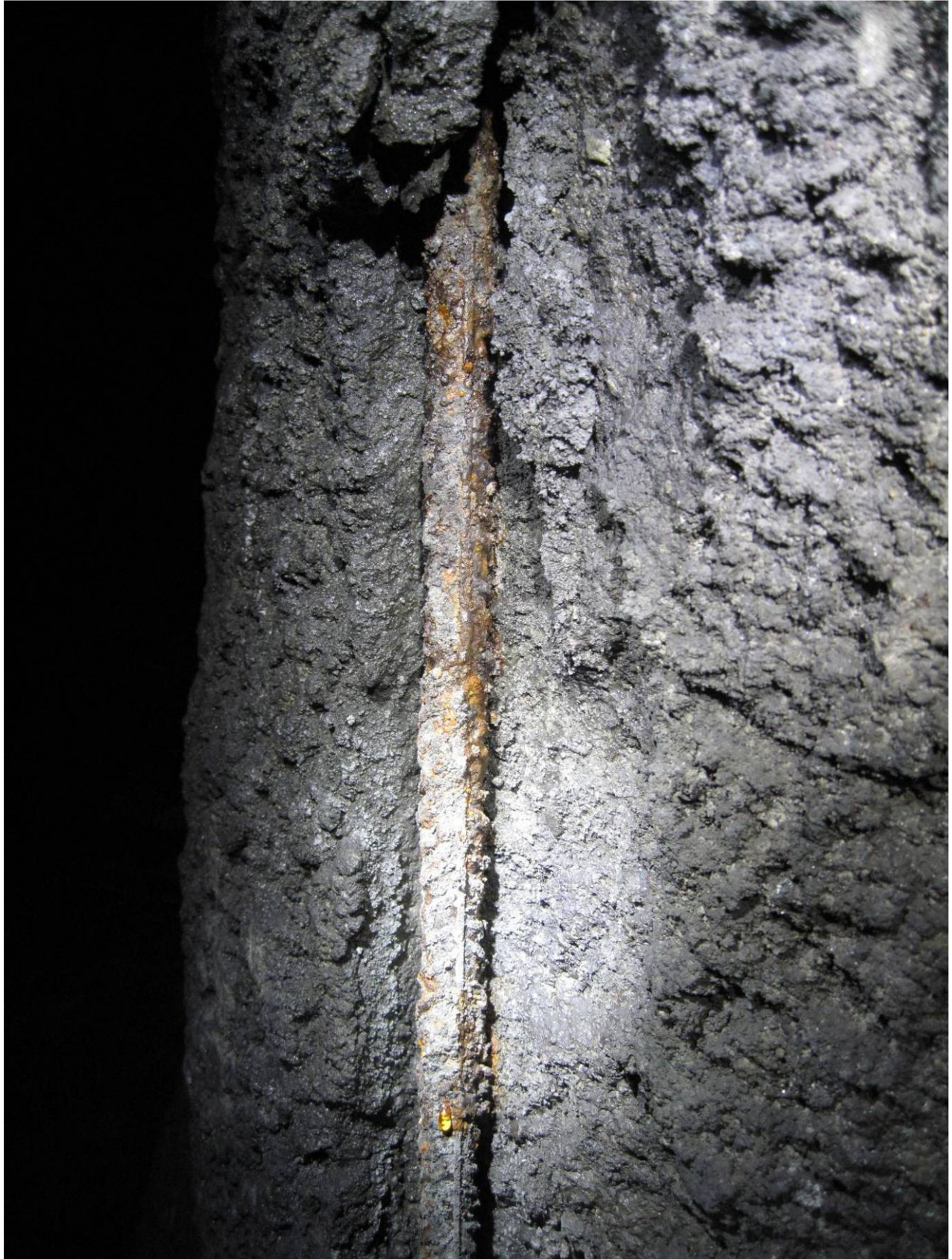
Figur 1.2-14 Det ubeskyttede kamstålet er korrodert på overflaten, men har tilsynelatende foreløpig ikke blitt svekket av korrosjonen
