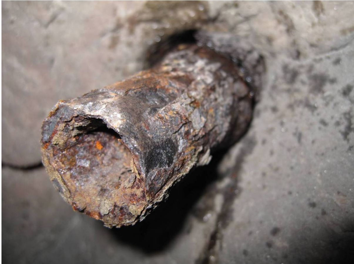
Figur 1.10-9 Swellexbolt 2. Bolteende etter fjernet korrosjon
