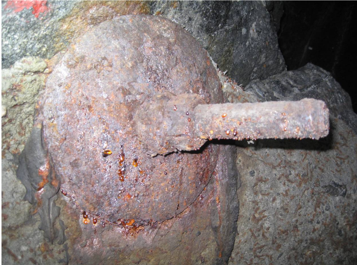
Figur 1.4-11 Bolt 2. Også kraftig angrepet av korrosjon.
