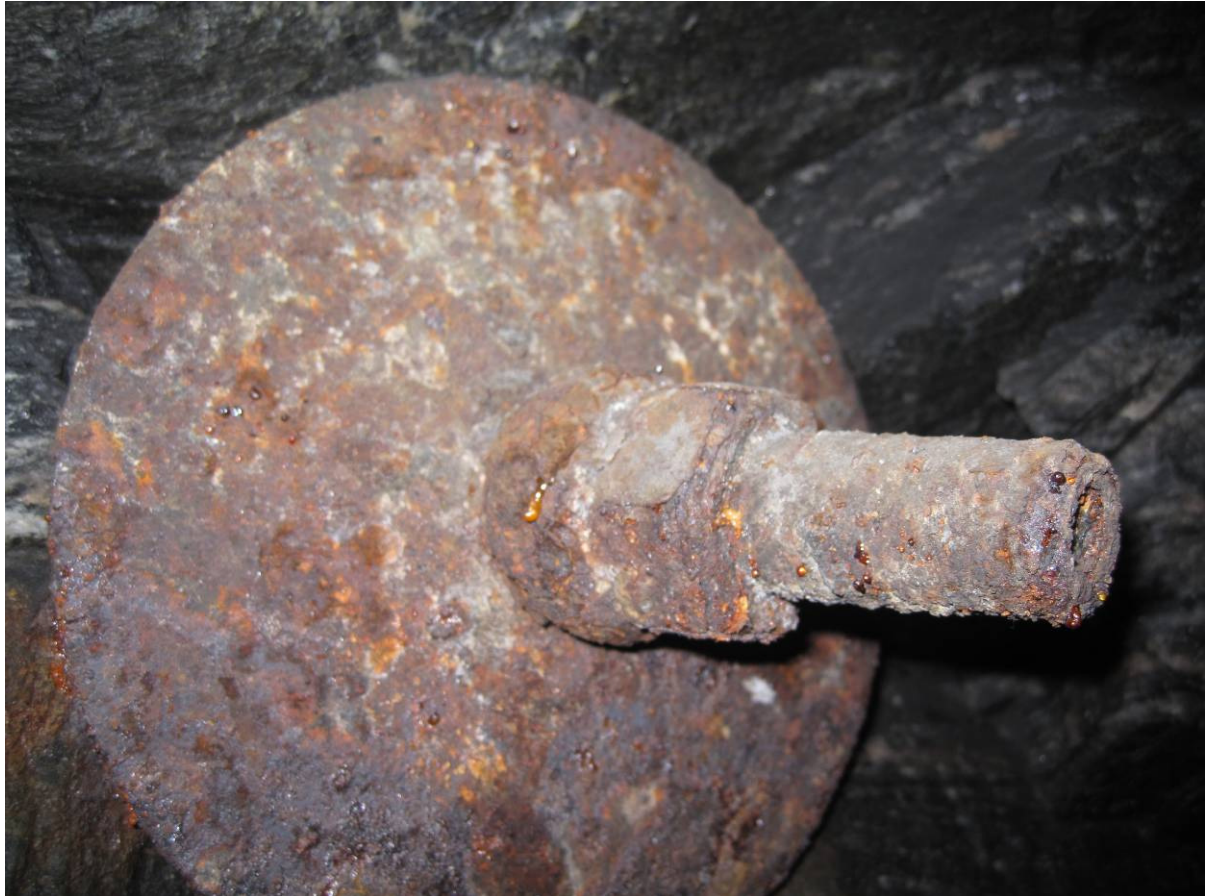
Figur 1.4-3 Bolt 1. Hele bolt inkludert skive, mutter og kule er kraftig angrepet av korrosjon. Bolt har enkel korrosjonsbeskyttelse.
