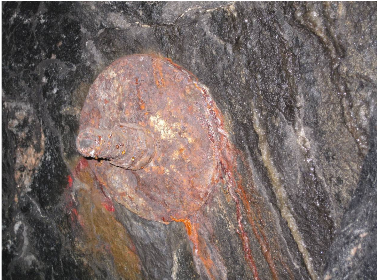
Figur 1.4-12 Bolt 3. Også kraftig angrepet av korrosjon.
