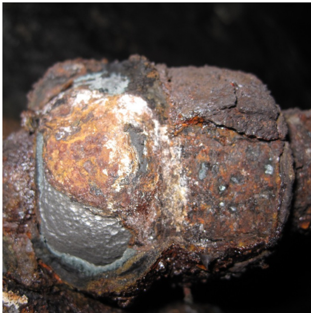
Figur 17 Dyptgående korrosjon av halvkule. Fjerning av tykt korrosjonslag avslører en ruglete ståloverflate (Ellingsøytunnelen)
