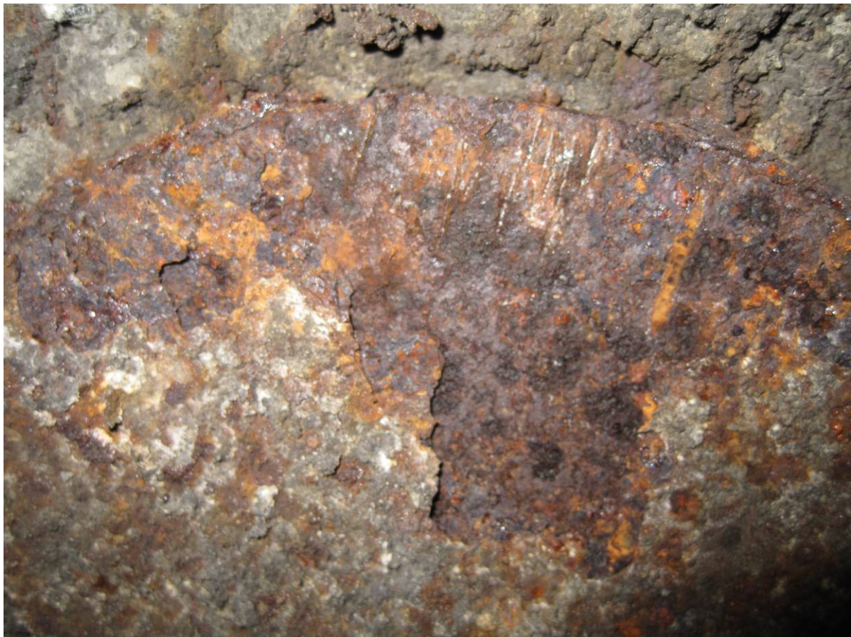
Figur 1.5-16 Bolt 8. Korrodert plate. Noe sprøytebetong og korrosjon skrapet vekk med geologhammer
