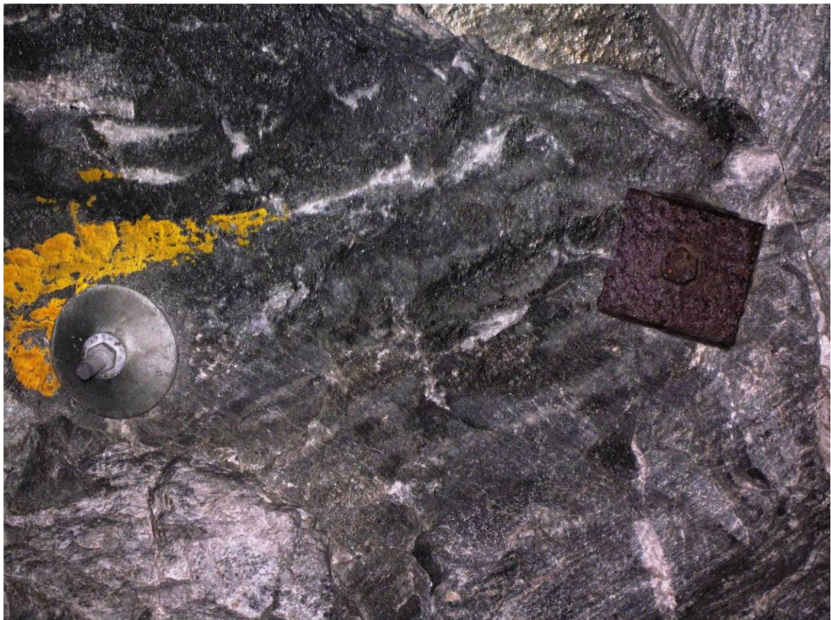
Figur 1.10-14 Gammel og ny bolt. Gammel bolt har vabler på rustoverflaten
