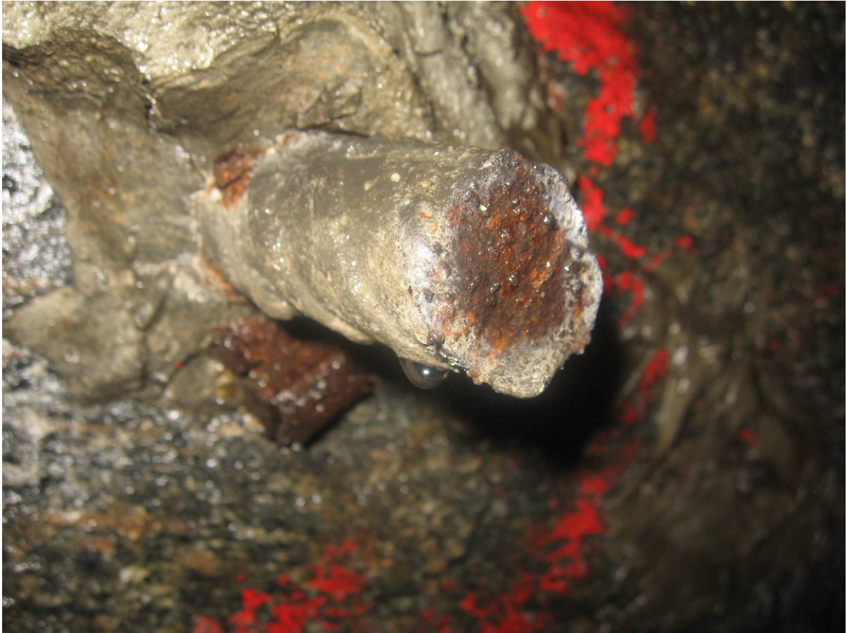
Figur 1.6-13 Fullt innstøpt bolt med korrodert bolteende og rustfarget mørtel rundt boltehullet
