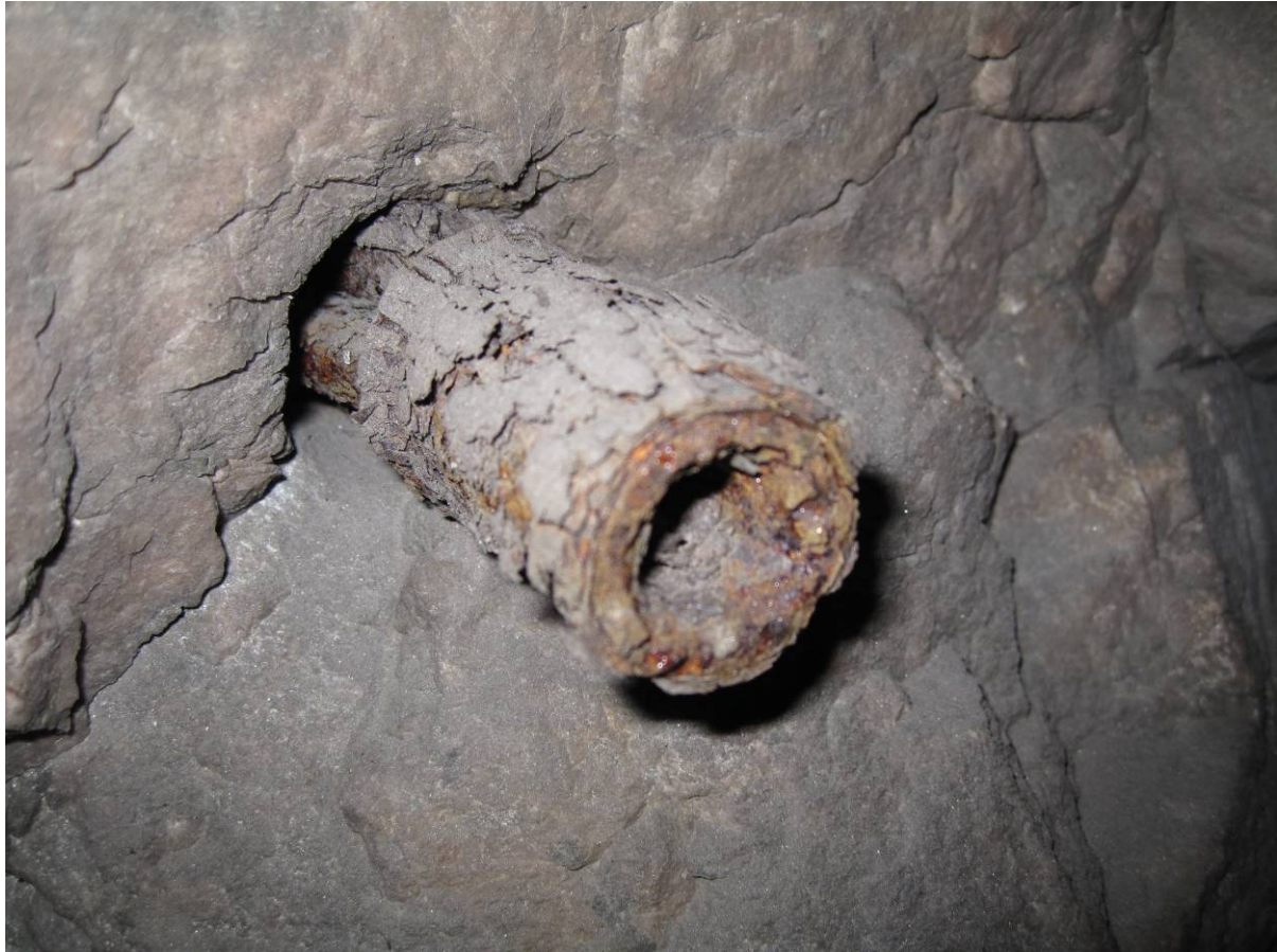
Figur 1.10-5 Swellexbolt 2. Mye løst korrosjonsmateriale på bolt
