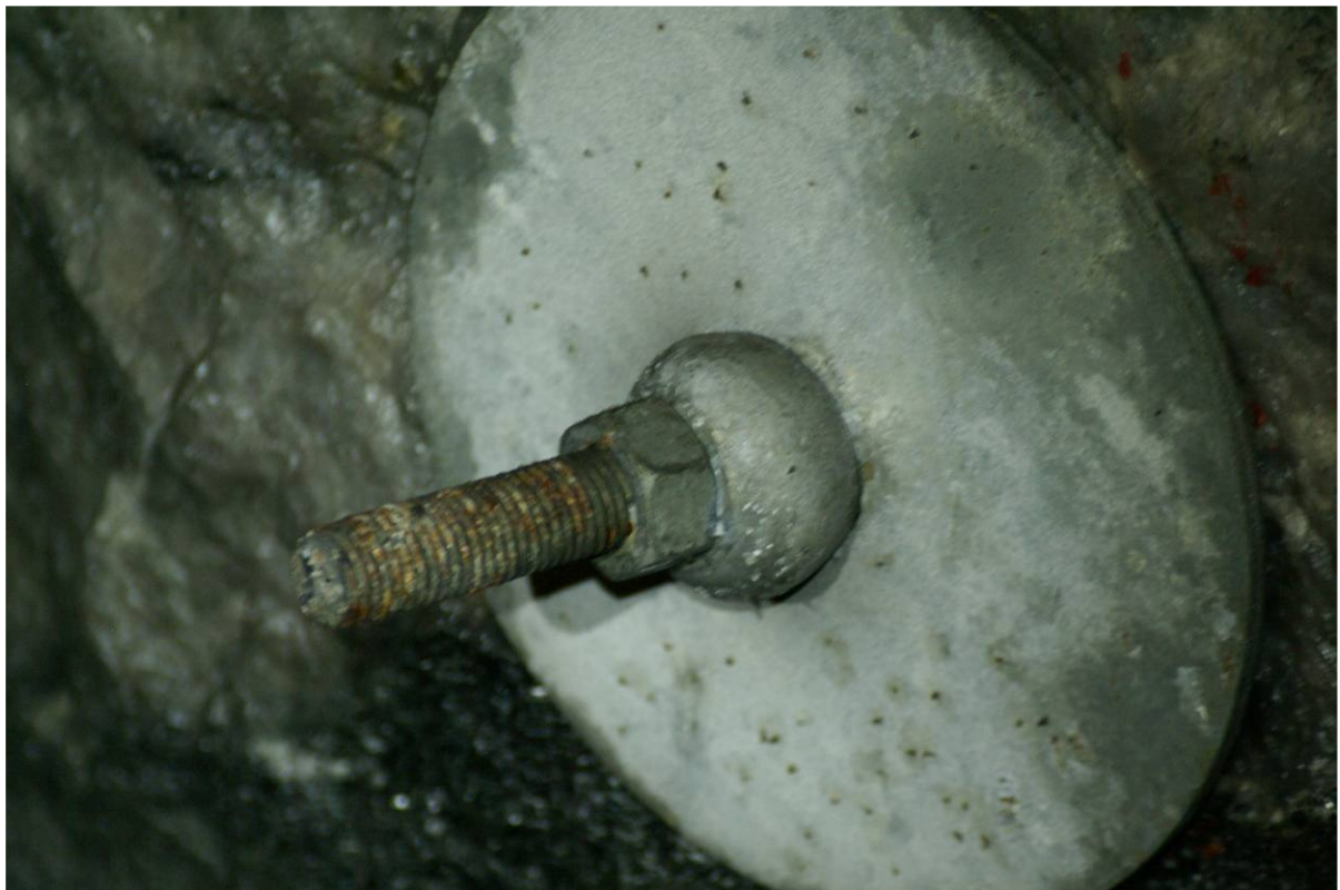
Figur 1.2-8 Noe overflatekorrosjon på gjenger.
