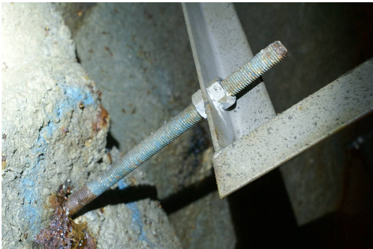
Figur 1.1-6 Korrodert festebolt. Overflatekorrosjon på gjenger, bolteende og hele bolten nærmest boltehull. Rustutfelling fra boltehull.
