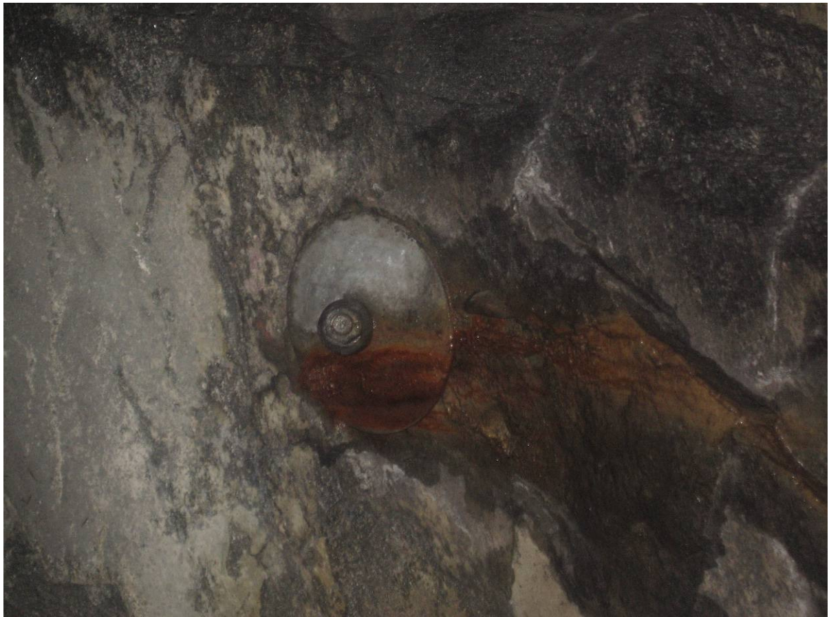
Figur 1.6-8 Rennende vann, og korrosjon på bolteplaten der denne er i kontakt med vannet
