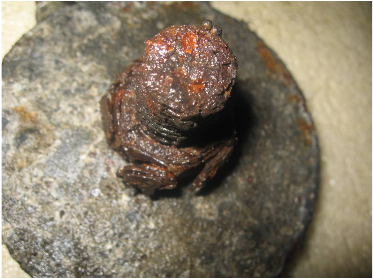
Figur 1.6-22 Festebolt for vannsikring. Korrodert bolt og mutter. Radiell oppsprekning og avskalling av rust på mutter
