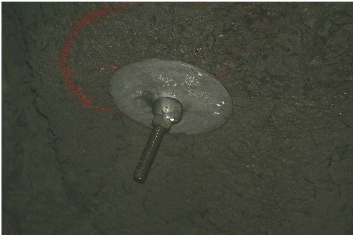
Figur 1.2-4 Bolt uten synlig korrosjon. Synlig fukt og vanddrypp.
