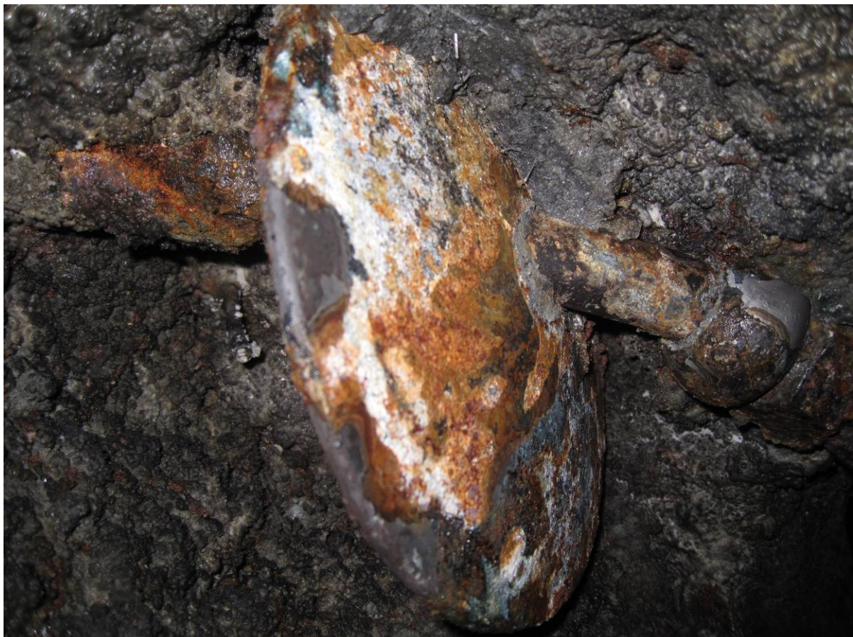
Figur 1.5-24 Bolt 13. Sprøytebetong har dekket hele plata og trolig virket retarderende på korrosjonen av stålet, men har ikke beskyttet fullstendig.
