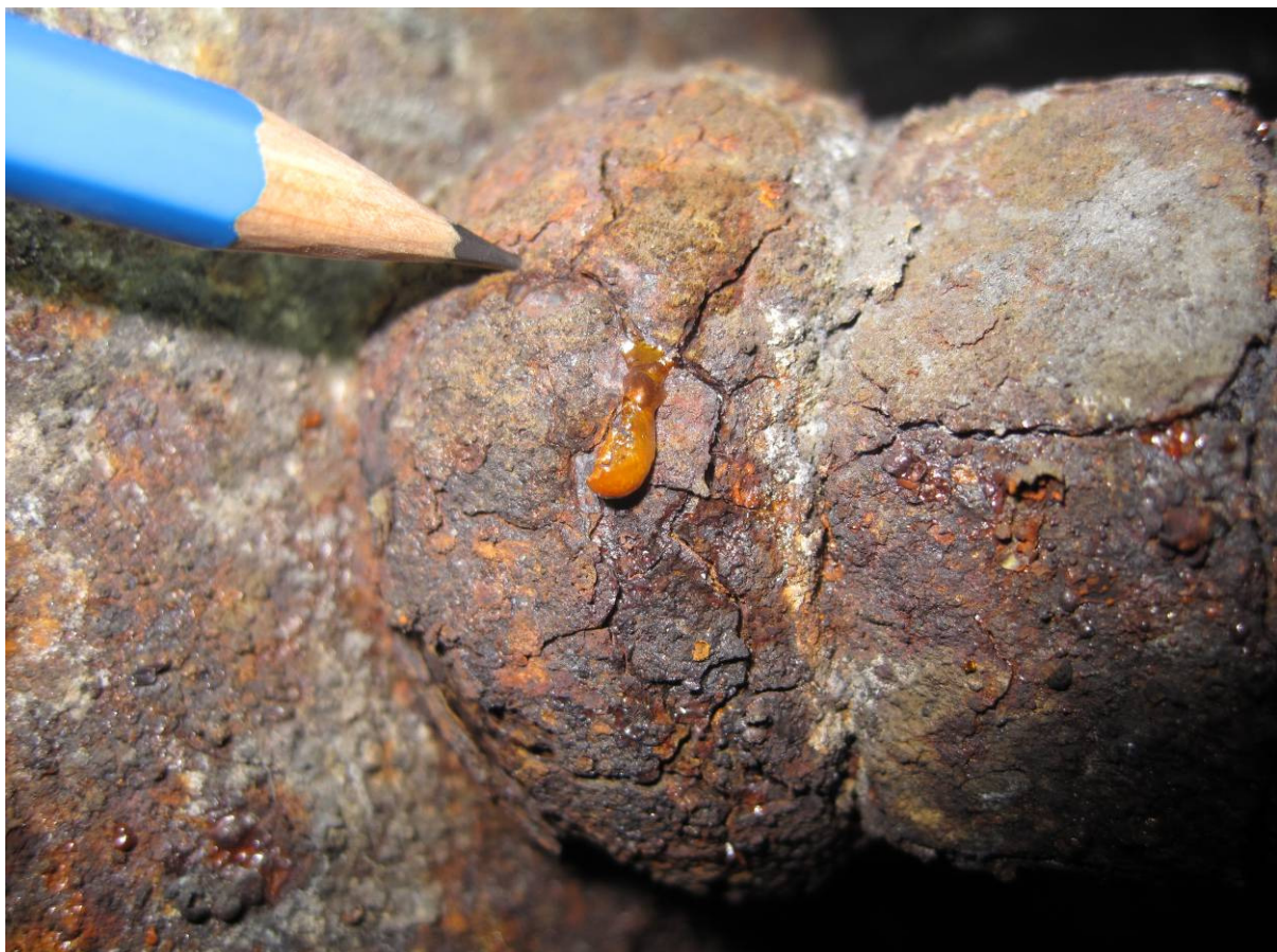
Figur 1.4-4 Bolt 1. Krakelering av korrosjonsmateriale, som ligger som flere radielle flak rundt halvkule og mutter
