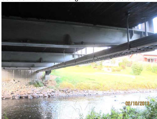
Bilde under: Kabelkanal hengt under tverrbærere.
