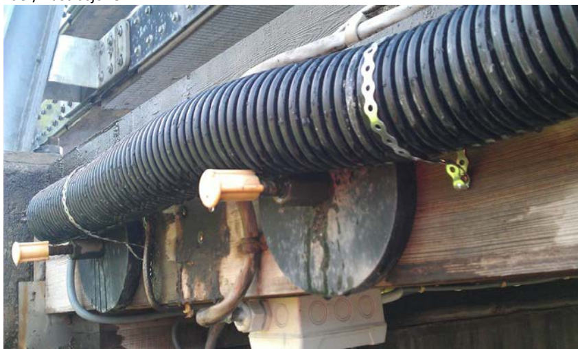
Bilde over: Opphengt til kablene fukter opp treet lokalt.
