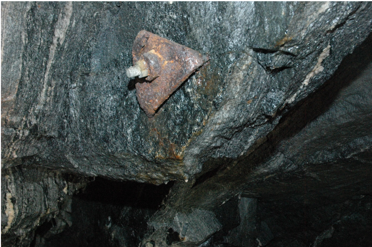
Korrodert bolteplate på bolt som stikker ut mellom to knøler
