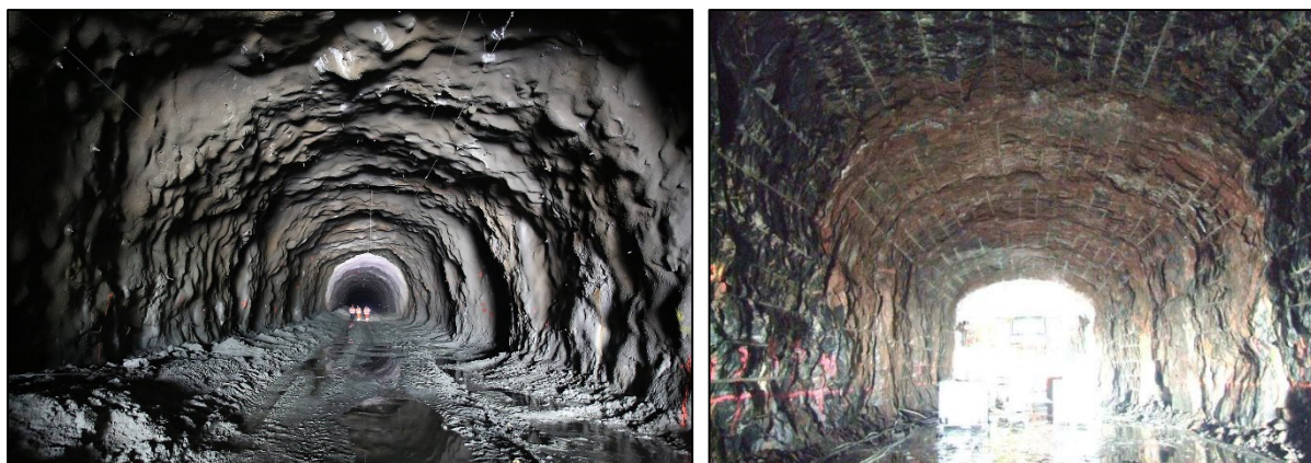
Bildet til venstre viser en ikke uvanlig kontur i en norsk samferdselstunnel (foto: Per Ivar Nikolaisen, mens bildet til høyre viser en god kontur i en svensk forsøkstunnel (foto: Anders Bouvin)
