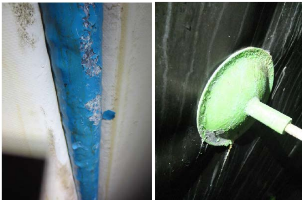
Bildet til venstre viser hulrom under blærende lakk i saltvannssonen i Bjorøytunnelen, mens bildet til høyre viser blæring og flassing i lakk i saltvannssonen i Ellingsøytunnelen.
