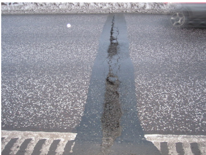
Asfaltfuge med stor skade (foto: Gaute Nordbotten)
