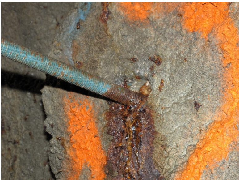
Korrosjon på bolt er ofte mest markert i overgangen mot berg. Foto: Statens vegvesen.
