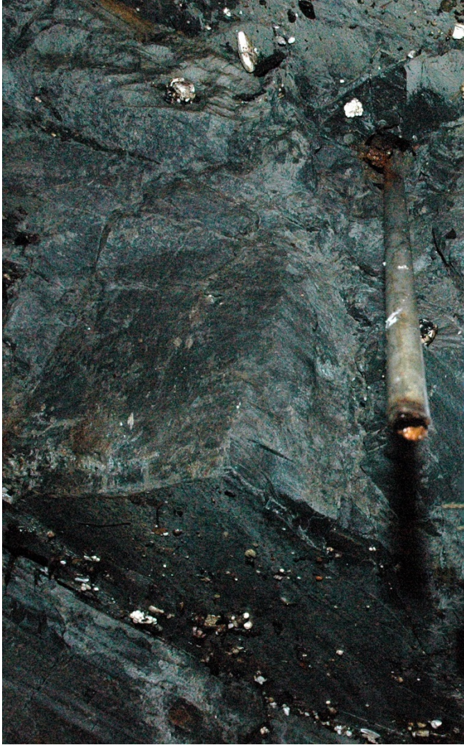
Figur 5 Rustfri bolt, nr. 2 (i boltehull nr. 5)
