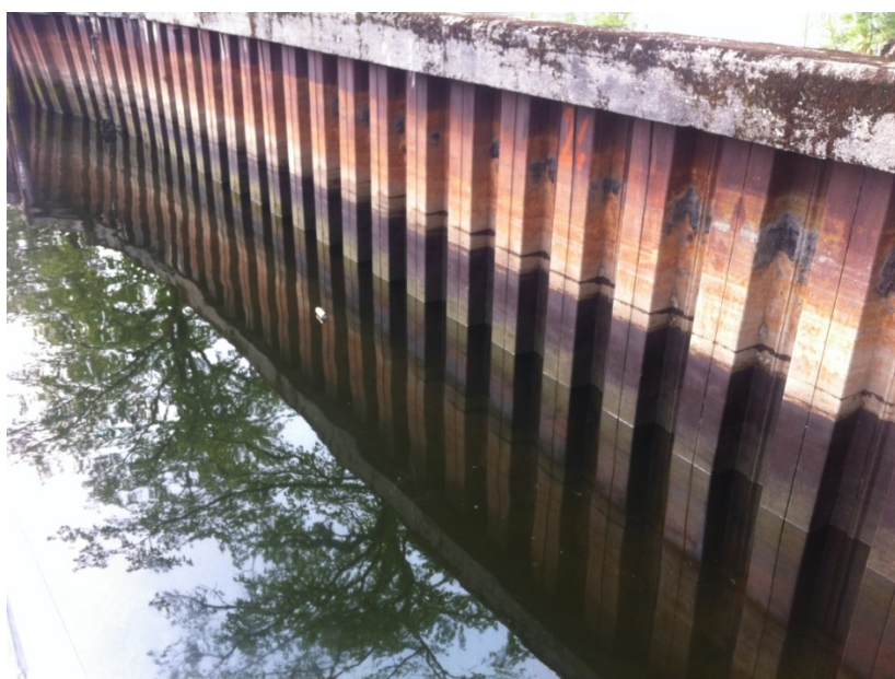
Figur 5. Generell korrosjon på spuntvegg (Foto: SINTEF)
