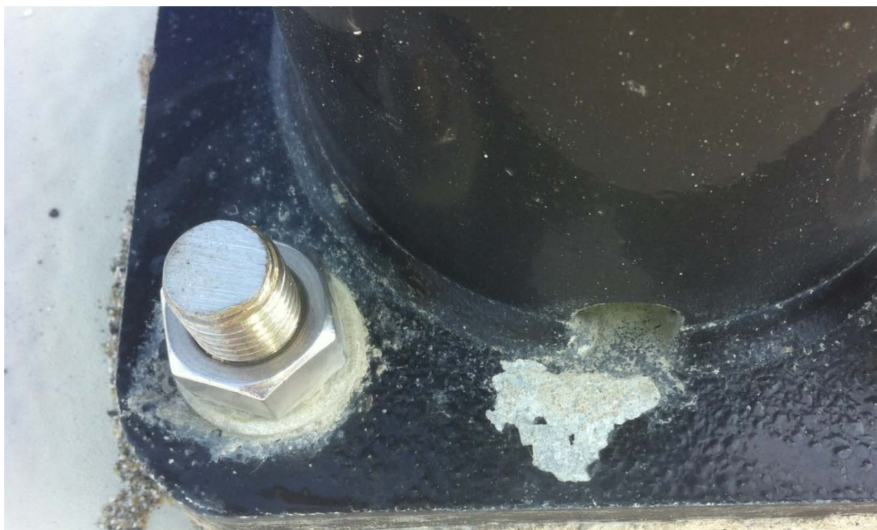
Figur 13. Korrosjon på sink under pulverlakk forårsaket av slag (sink-jern partikler) i overflata på sinken. Galvanisk effekt fra den rustfrie bolten akselererer korrosjonen. Angrep forårsaket av nålestikk vil ha et tilsvarende utseende. (Foto: SINTEF)
