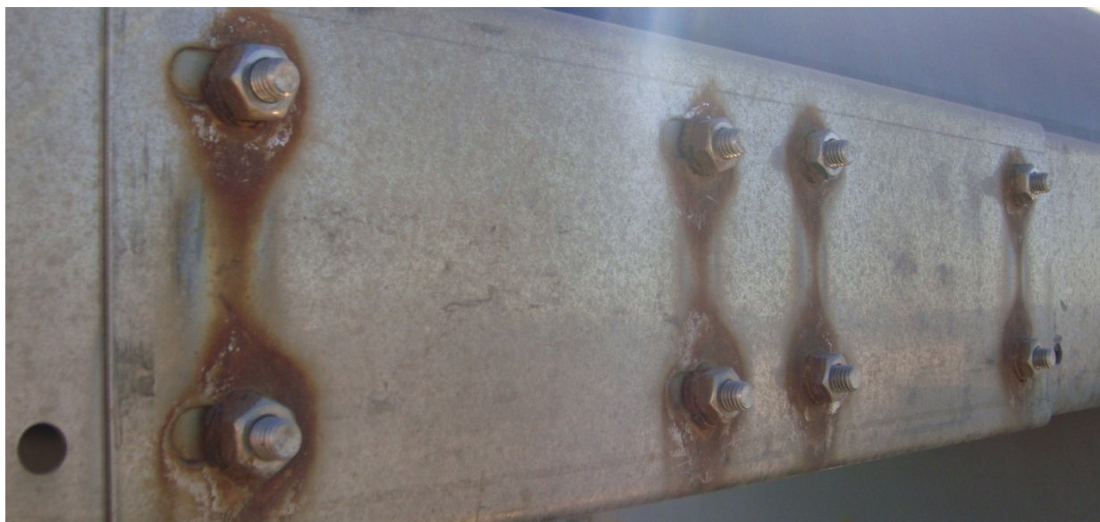
Figur 6. Galvanisk korrosjon på skivene mellom rustfrie muttere og skinne (Foto: Wikipedia)
