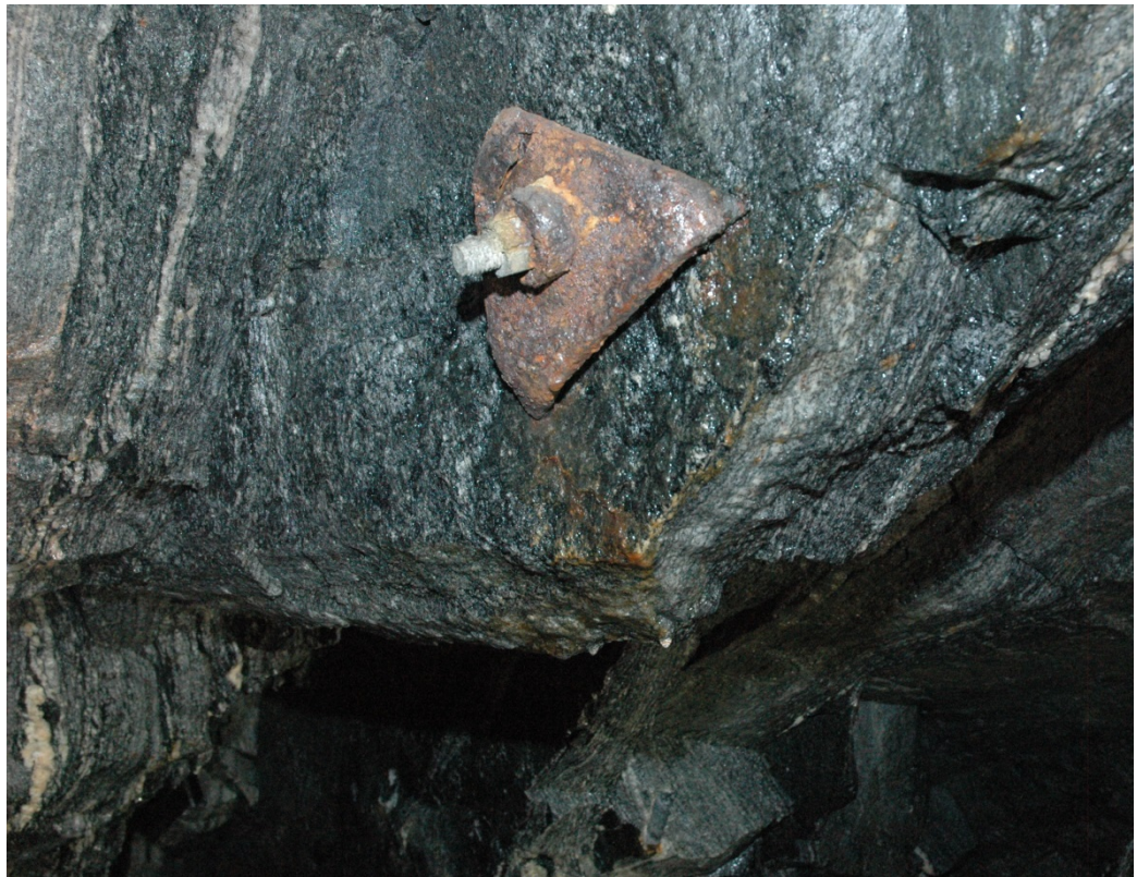
Korroderert bergsikringsbolt, Rv15 Grasdaltunnelen, Stryn, åpnet 1977 (Foto: Karen Klemetsrud, Statens Vegvesen)
