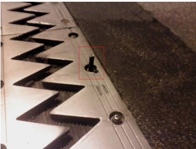
Figur 1 Gjengestang som har skrudd seg ut (foto: Nina Utne)
