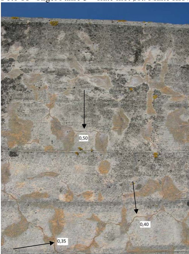
Foto 19 Rigel i akse 3 – flate mot øst. Nærbilde av målsatte riss på foregående bilde.
