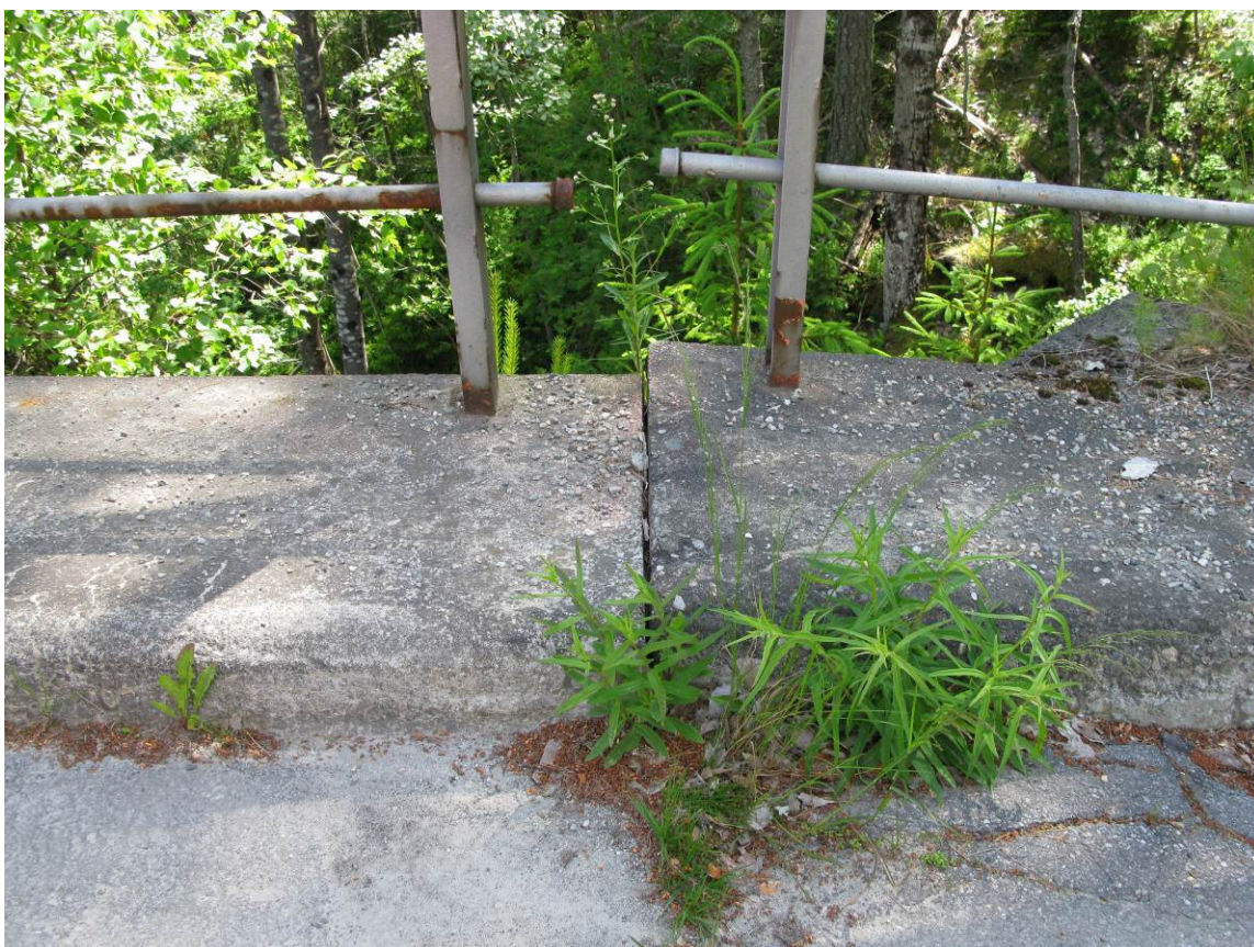
Foto 27 Kantbjelke ved landkar i akse 6.
