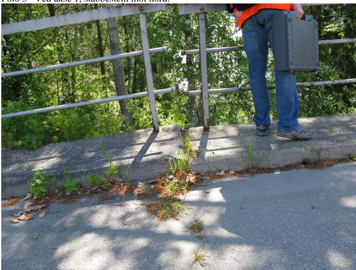
Foto 4 Kantbjelke ved landkar i akse 1.
