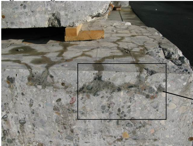
Figur 55 Rigel i akse 4. Riss vertikalt på flate mot øst går over i overflateparallele riss
