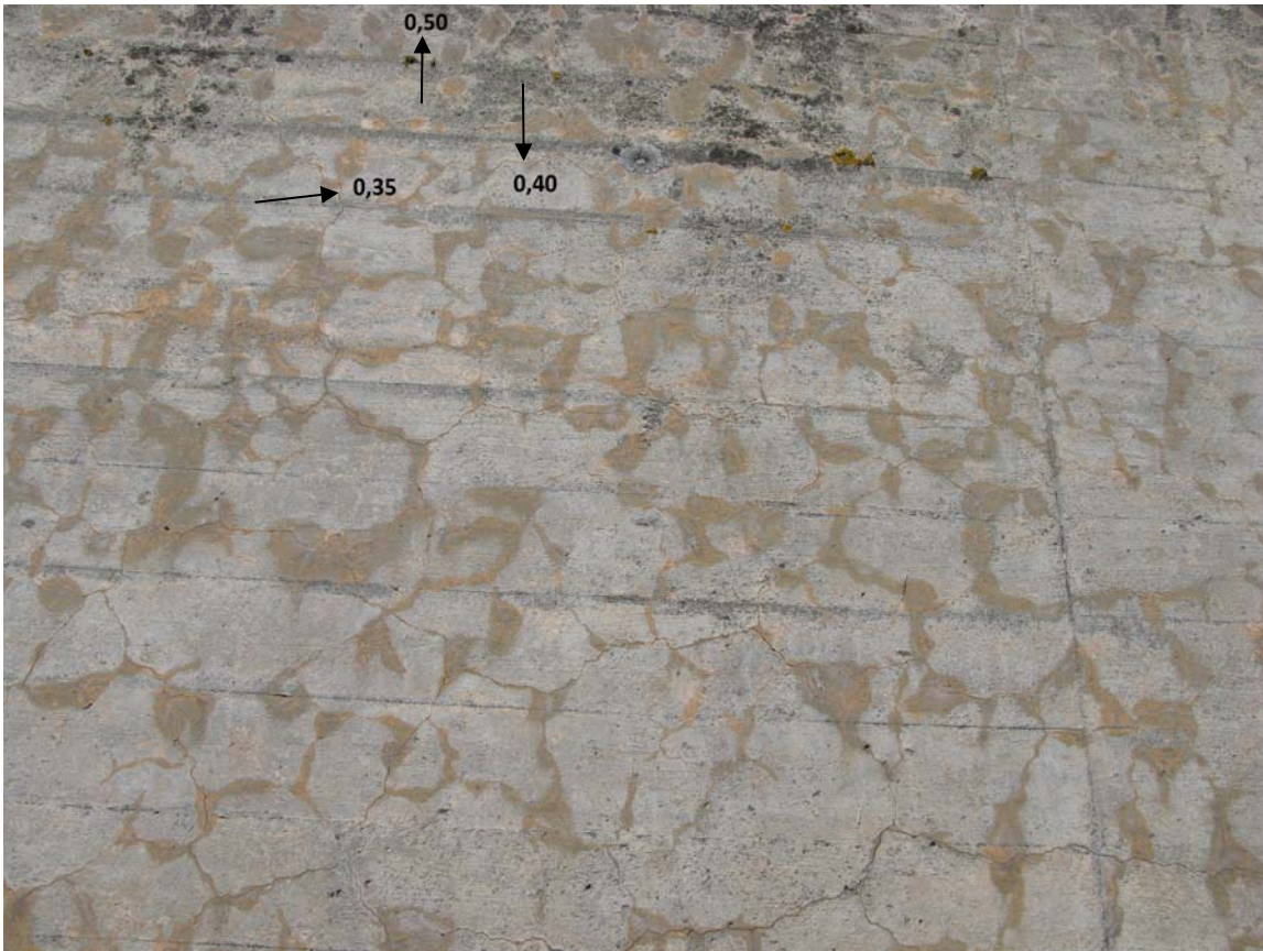
Foto 18 Rigel i akse 3 – flate mot øst. Målte rissvidder påtegnet.
