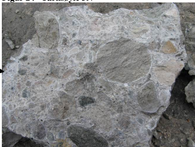
Figur 26 Betongbit fra dekkeseksjon. Merk hvite runder rundt tilslag
