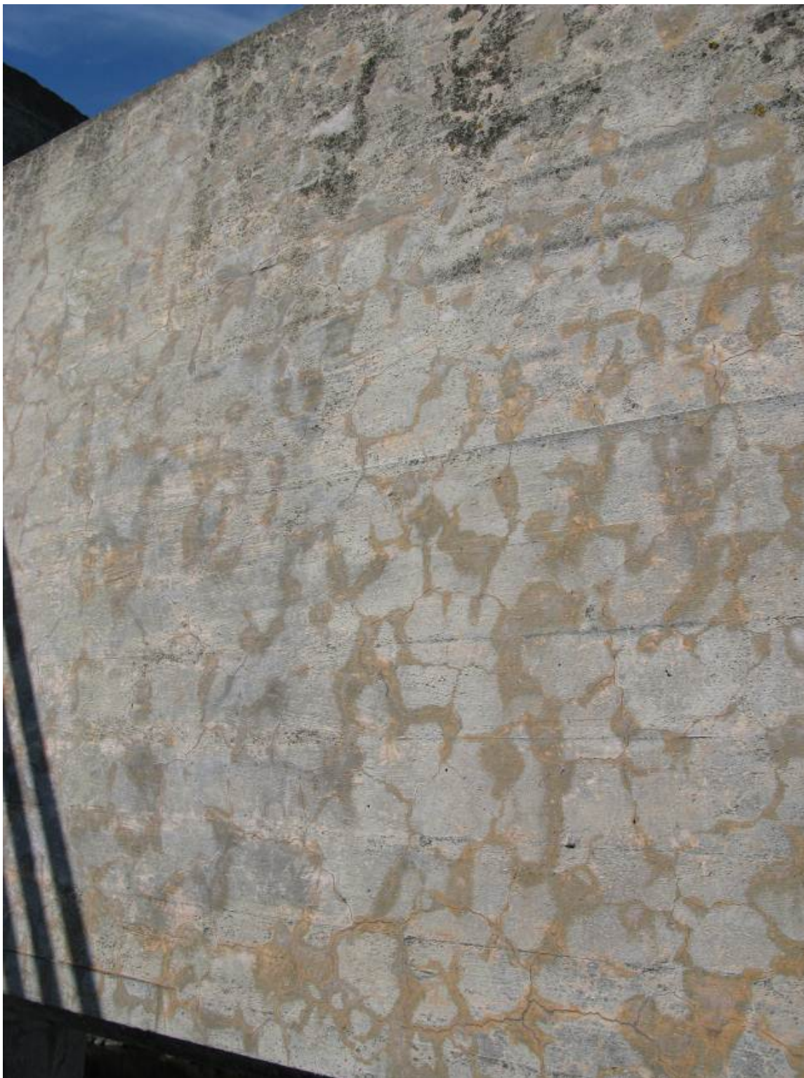
Foto 17 Rigel i akse 3 – flate mot øst. Krakeleringriss.
