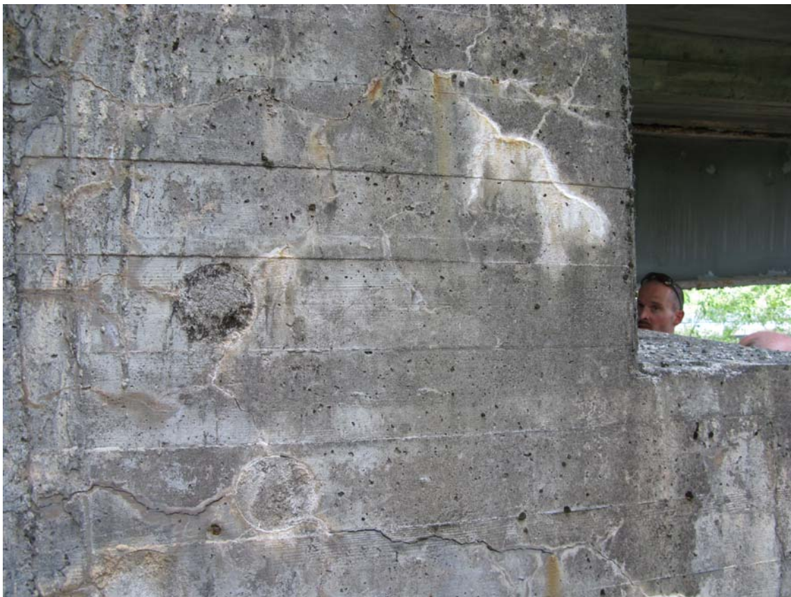
Foto 28 Landkar i akse 6 flate mot sør. Gjenstøpte hull etter prøvetaking i 2001.
