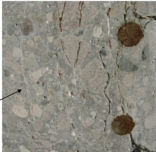
Figur 59 Grove overflateparallele riss. Merk også grove riss i enkelte tilslagskorn.
