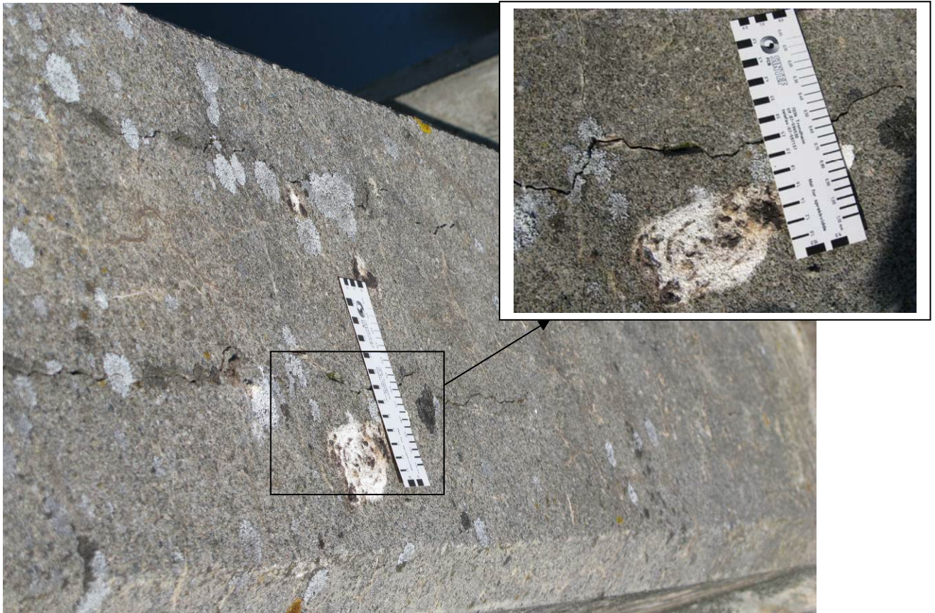
Foto 22 Rigel i akse 3 – toppflate. Langsgående riss med rissvidde 2,5 mm.
