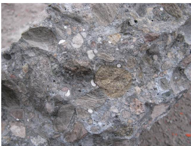
Figur 27 Betongbit ved landkar i akse 1, ukjent opprinnelse.
