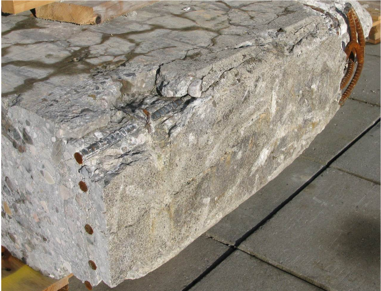
Figur 57 Rigel i akse 4. Grove langsgående riss i toppflata og stedvis delaminering parallelt med armering.
