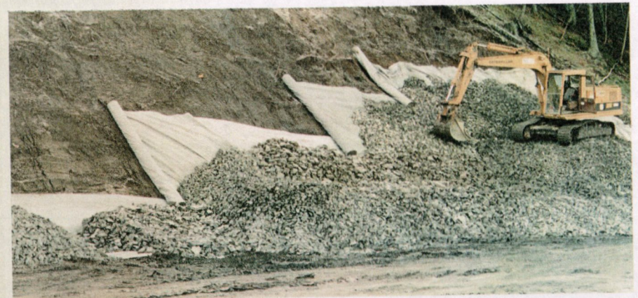
Figur 3.1 Dersom grunnen består av erosjonsømfintlige materialer (silt - sand) kan det være nødvendig å sikre grunnen mot erosjon med lag av grov grus/pukk på fiberduk for å hindre utvasking av masser fra skråningen inn i fyllingen. (Foto: Nils Rygg, Veglaboratoriet)
