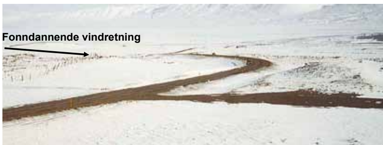
Figur 6-3. Eksempler på veger hvor lokale forhold fører til at det er nødvendig å bruke snøfres over korte strekninger for å holde vegene åpne. (Foto: Harald Norem)
