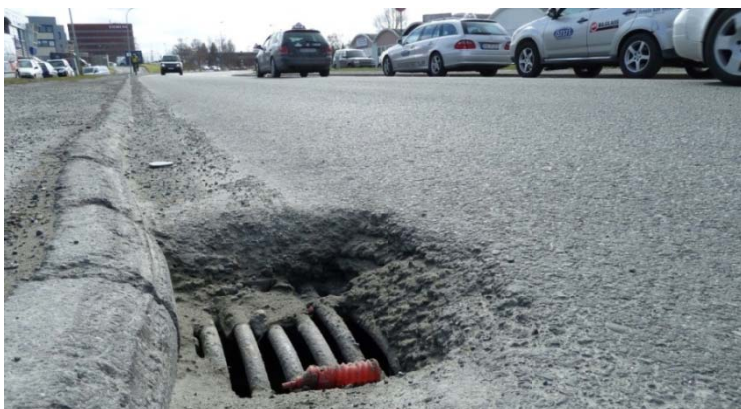
Figur 6.4: Sykkelfelt med manglende oppmerking, dårlig renhold og manglende justering av sluk
