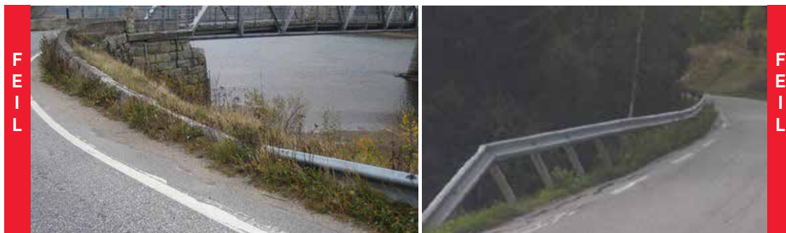
Figur 3.44: Eksempel på rekkverk som skal erstattes eller justeres. Begge disse foto viser situasjoner som utgjør stor sikkerhetsrisiko ved evt. utforkjøring. En bil på avveier kan enden hoppe over rekkverket (venstre foto) eller bøye det ned (høyre foto).
