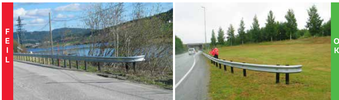
Figur 4.7: Eksempel på feil (venstre) og riktig (høyre) montasje av ikke-energiabsorberende rekkverksende. Venstre foto viser en rekkverksende som slipper kjøretøyet forbi til et sideterreng som utgjør en sikkerhetsrisiko.
