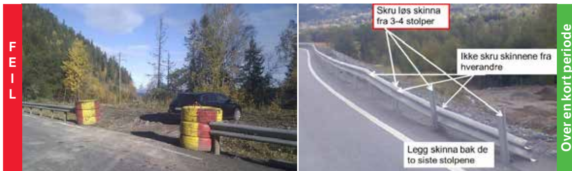
Figur 3.42: Eksempel på feil sikring (venstre) og akseptabelt sikring over en kort periode (høyre) av rekkverk ved montering. Dekkstablene foran en rekkverksskinne som er avsluttet i full høyde, er ikke tilstrekkelig til å ufarliggjøre rekkverksenden.
