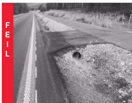
Figur 2.24: Eksempel på påkjørselsfarlig stikkrenneavslutning gjennom kryssende veg
