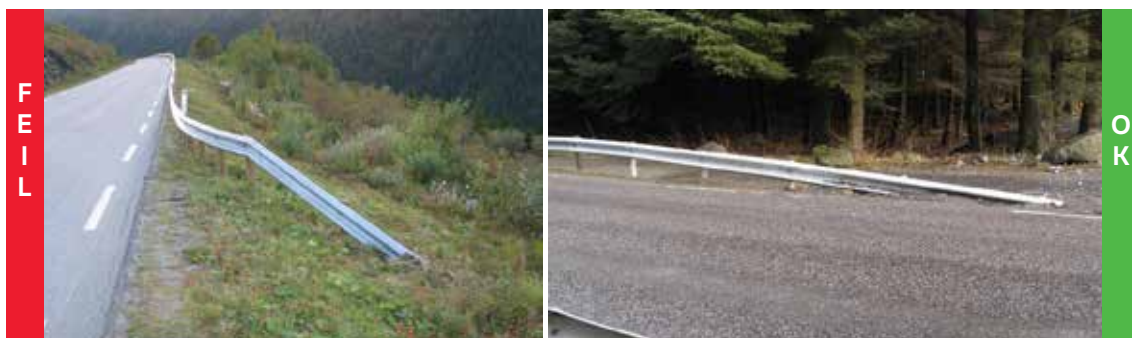
Figur 4.11: Eksempel på feil (venstre) og riktig (høyre) bruk av nedføring av rekkverksende. Venstre foto viser en altfor bratt nedføring (over kun en skinnelengde) med ikke tilfredsstillende forankring (stolpetetthet).
