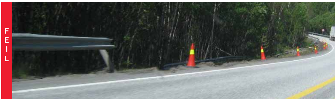
Figur 3.43: Eksempel på rekkverk som står ubeskyttet etter påkjørsel for en lang periode. En rekkverksskinne som står ubeskyttet i full høyde utgjør en meget stor sikkerhetsrisiko.
