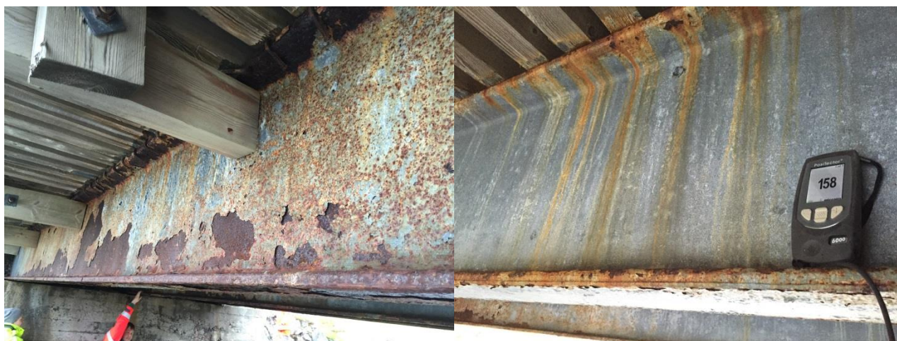
Figur 7. Nedbrytning av belegget på bjelkene. Til venstre vises den bjelken som står nærmest sjøen, den siden som er vendt mot sjøen. Til høyre vises midterste bjelke vendt fra sjøen.
