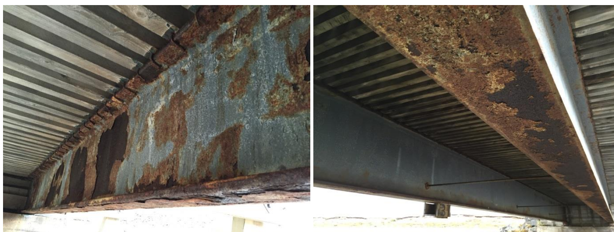
Figur 2. Korrosjon på bærebjelkene. Bildet til venstre viser siden som er vendt mot sjøen, mens bildet til høyre viser siden som er vendt bort fra sjøen.
