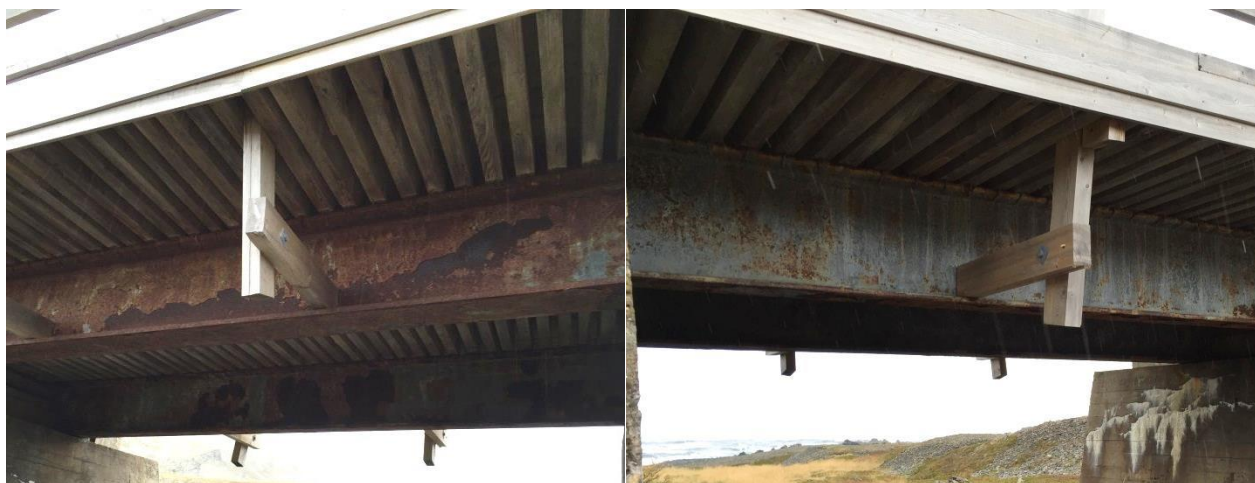
Figur 5. Nedbrytning av belegg på bærebjolkene på siden som vender mot havet (venstre) og siden som vender fra havet (høyre).
