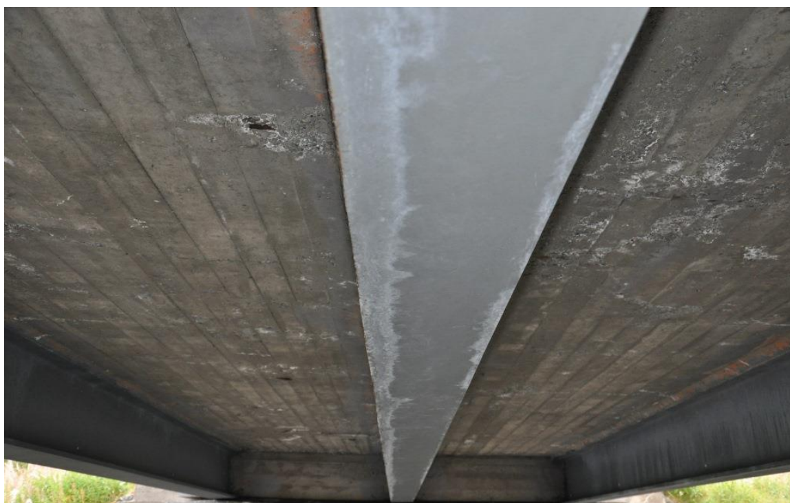
Figur 17. Beleggtilstand på Ifjord bru i 2013
