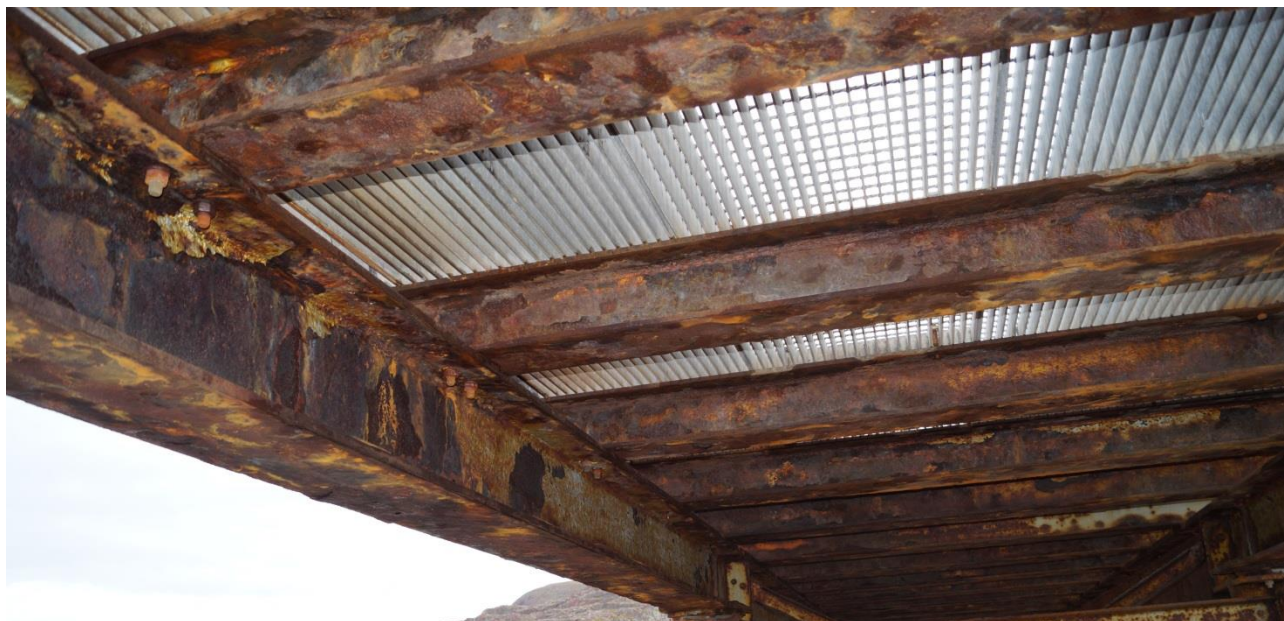
Figur 22. Beleggtilstand på Østerelv bru i 2015
