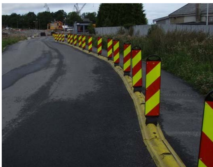
Figur 4. 7: Eksempel på hindermarkeringer montert i rekke
