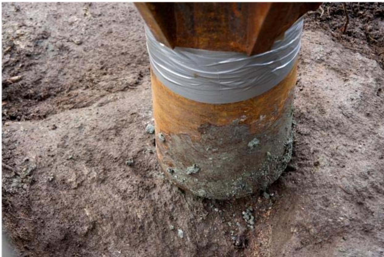
Berget før spissen ble rammet.
