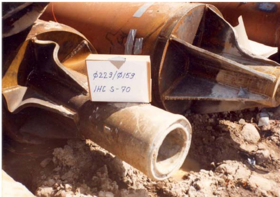
Figur 9-2: Bukling av avstivningsplater med tykkelse t=15 mm Foto: Hannu Jokiniemi
