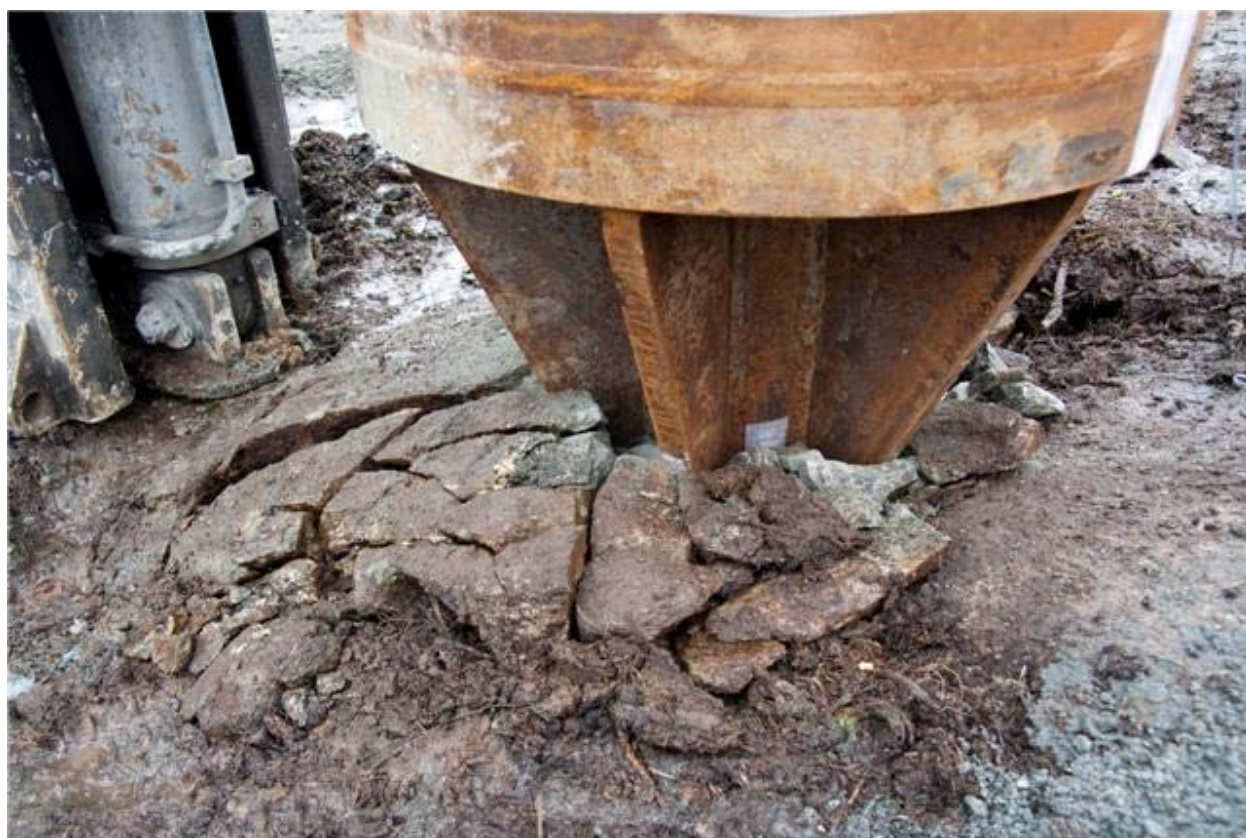
Oppsprukket berg etter at spissen ble rammet ned.
