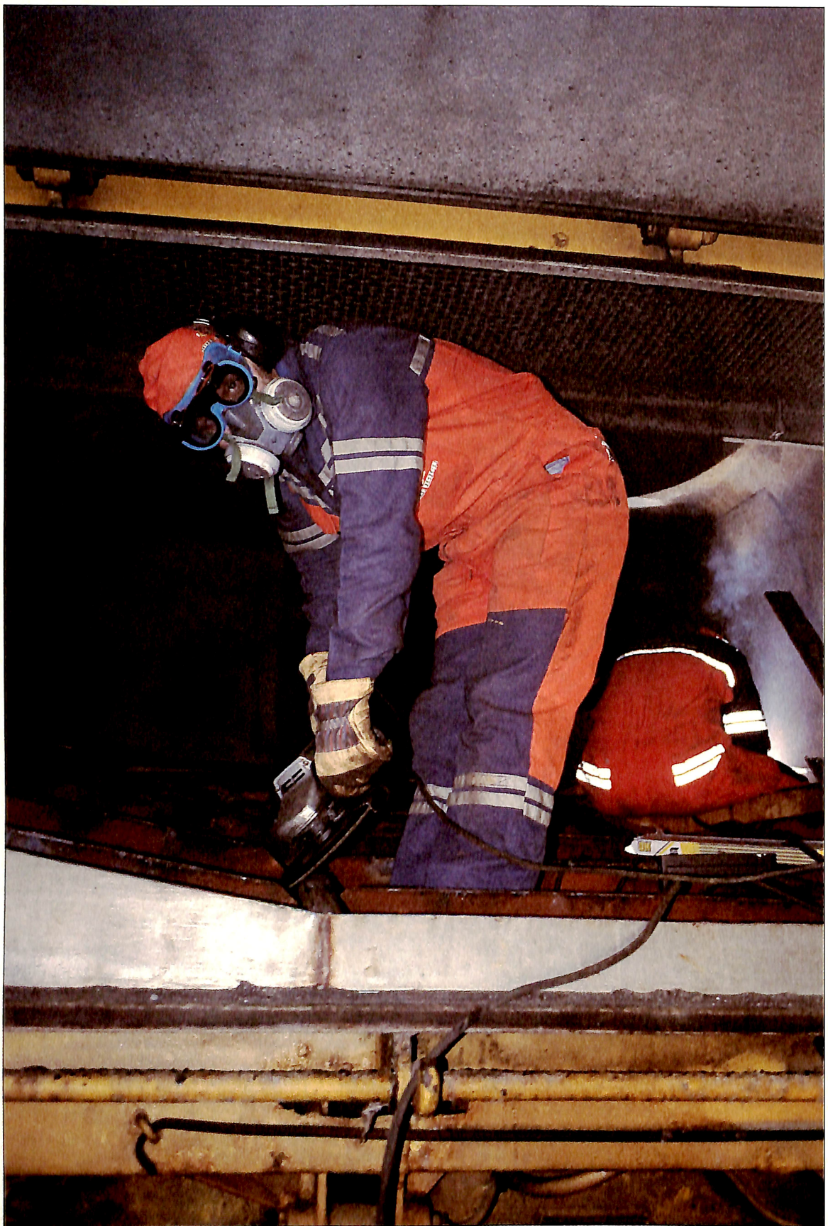
Det er påbode å bruke verneutstyr når arbeidsoppgåven tilseier det.
