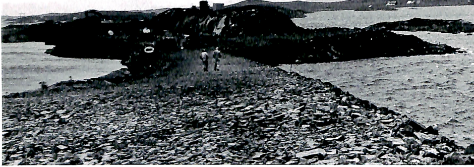
Fra anlegget sett mot Edøy. Her kjem den første brua i vegsambandet Smøla–Edøy. Arbeidet på brua tar til i løpet av november. Når denne brua er ferdig neste år, vil Hestøya bli landfast med Smøla, med bru over Dampleia mellom Nørholmene (Rossvoll på Smøla) og Lamøya og fylling Lamøya–Hestøya.
