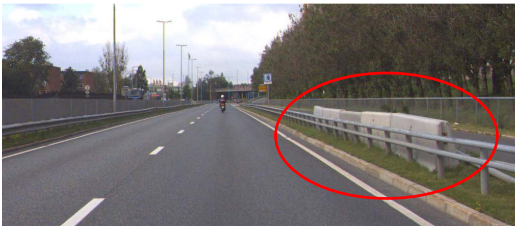
Figur 3: Ut plassering av midtdelelementer type Secura N2 langs E6 ved Rv. 4 Veitvet i Oslo
