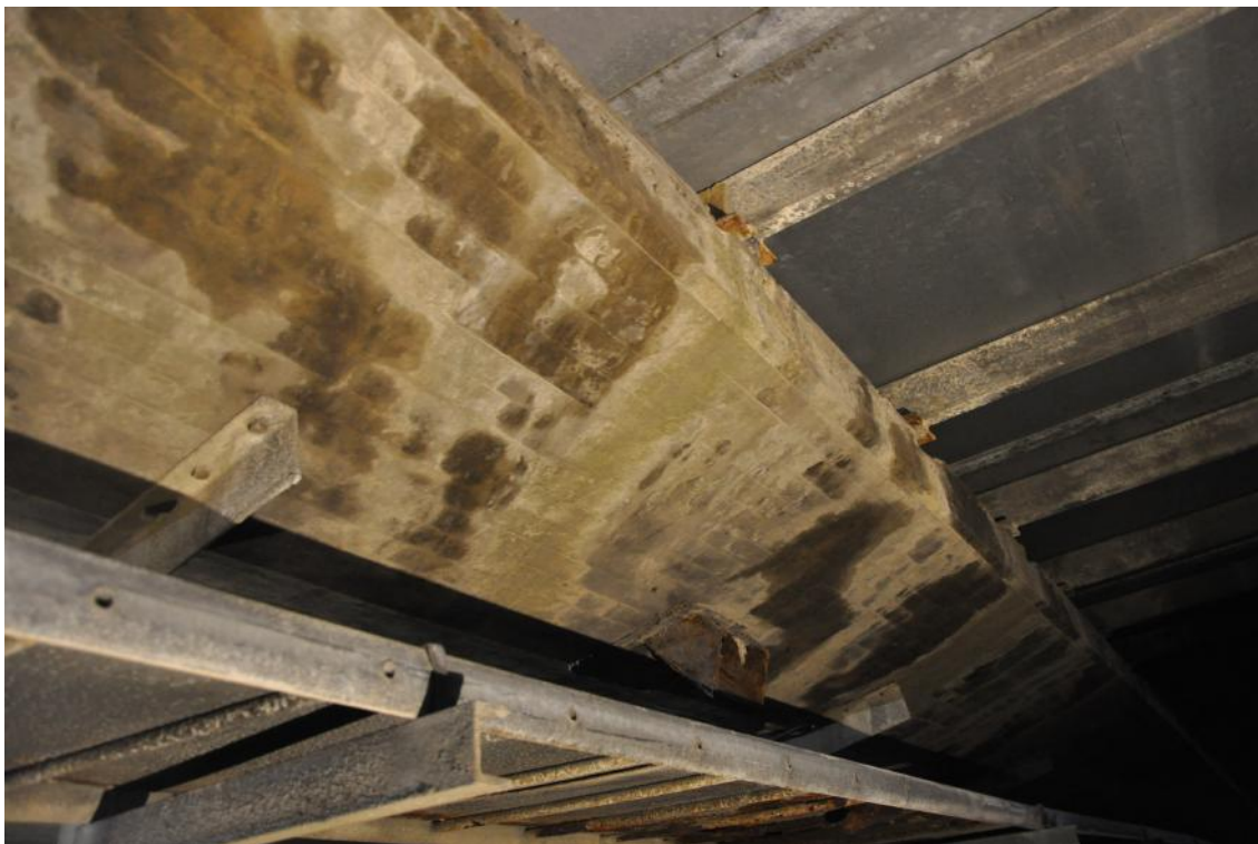
Figur 5.6: Fuktig bruplate under påhengt gangbane
