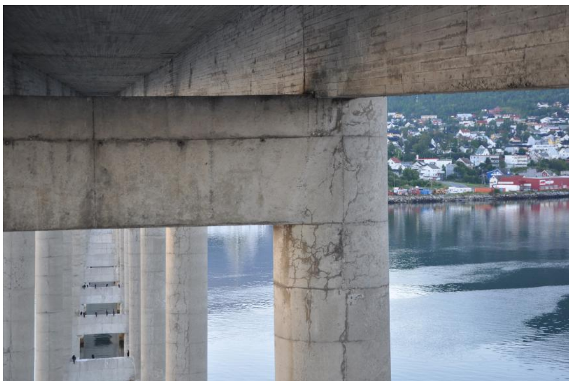
(a) Mer markant krakelering i toppen av søylen
