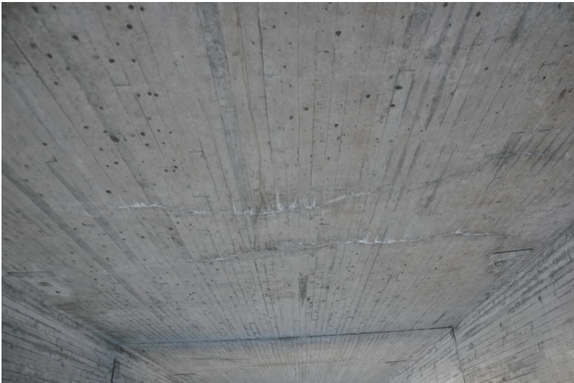
Figur 5.5: Svinnriss observert på undersiden av bruplata
