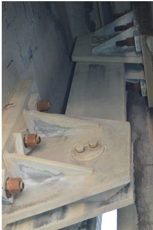
Figur 6.17: Korrosjon på skruer
