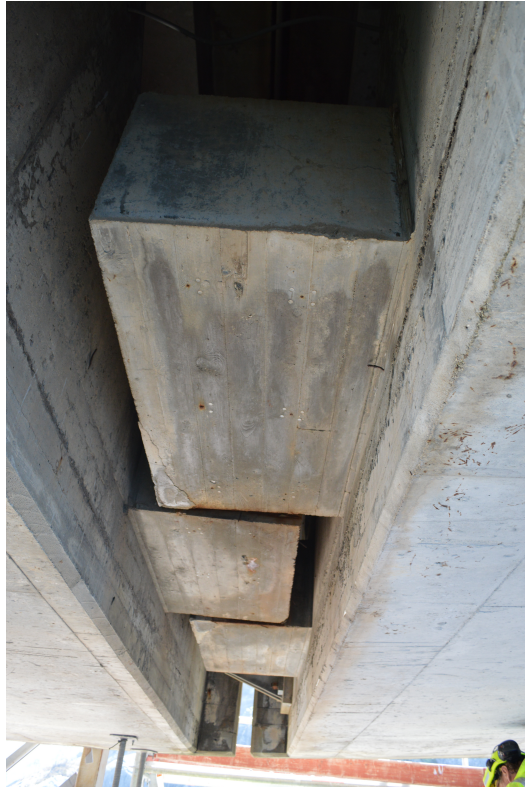
Figur 6.16: Korrosjon i betongen
