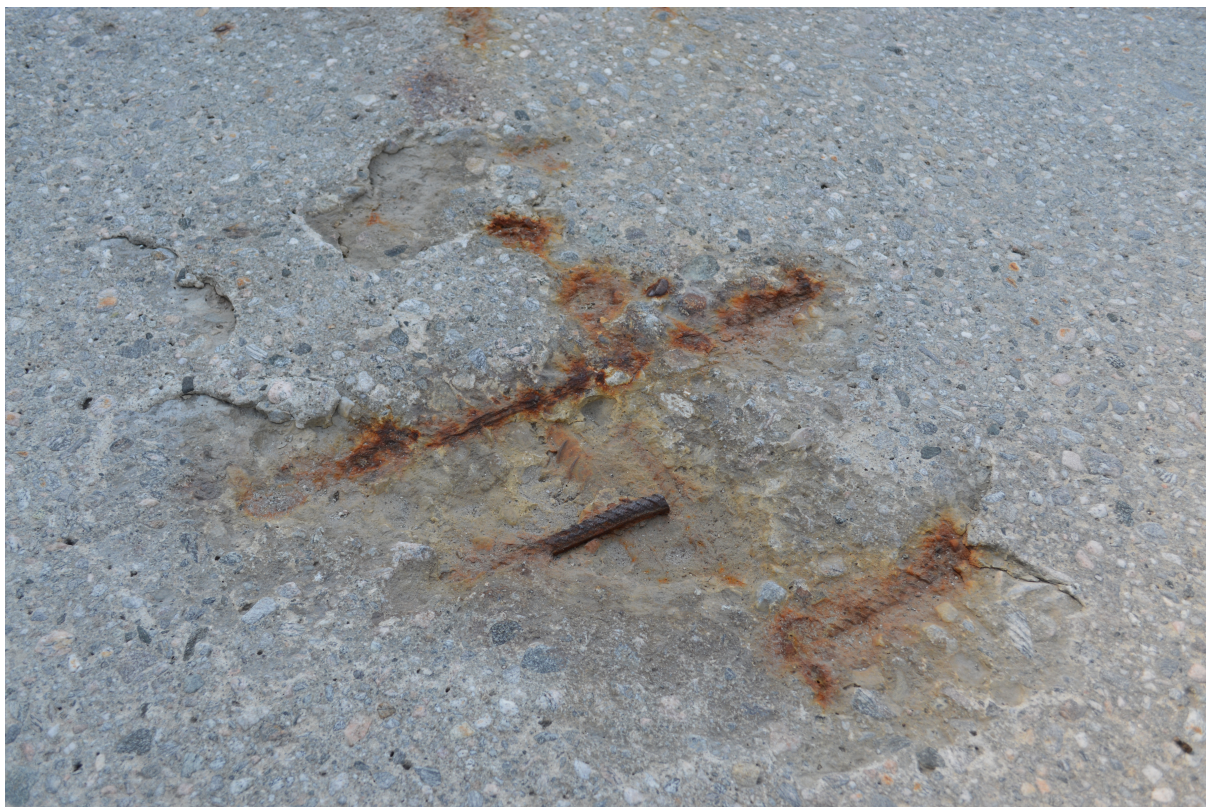
Figur 6.2: Synlig tverr- og lengdearmering i brudekket
