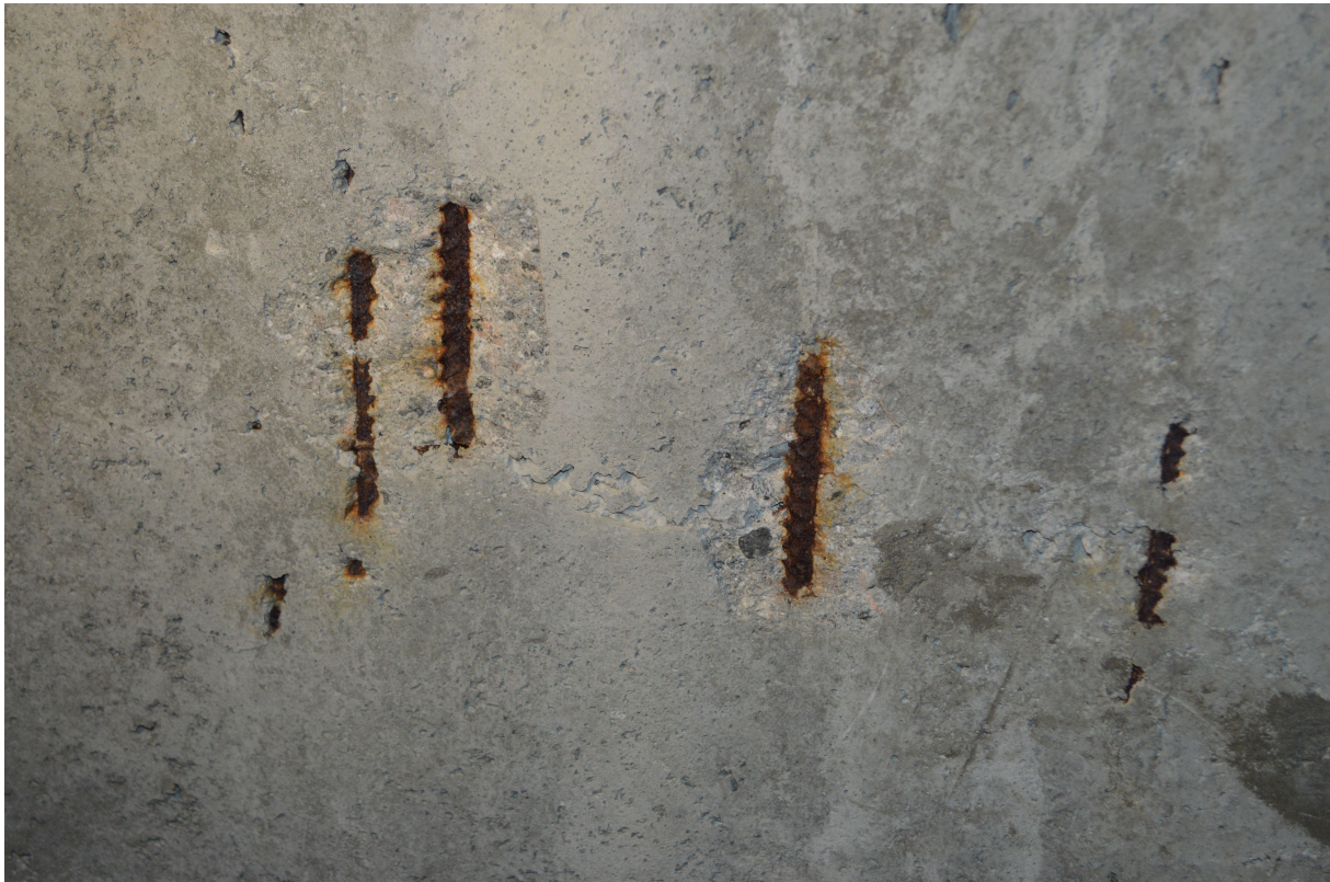
Figur 6.6: Eksponert vertikalarmering på innside av steg
