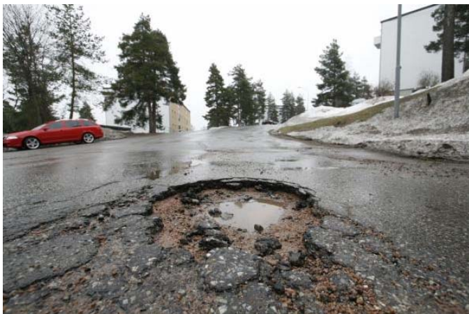
Figur 8.13 Slaghull i asfaltdekke (Foto: Drammens Tidende)
