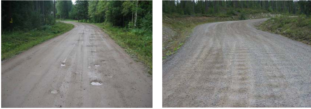
Figur 8.2 Ujevnt grusdekke (hull og korrugering). Alvorlighetsklasse 3, dvs behov for tiltak (Foto: Vägverket)
