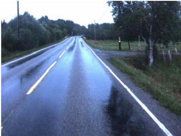
Figur 5.28 Eksempel på dekke hvor det er betydelig glattere i spor enn mellom spor
