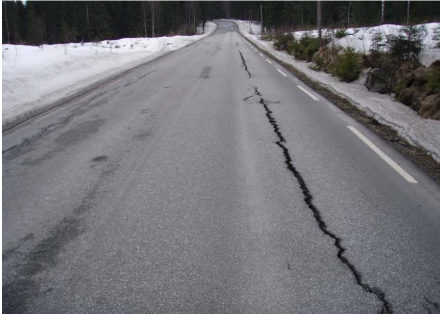
Figur 9.9 Oppsprekking etter breddeutvidelse
