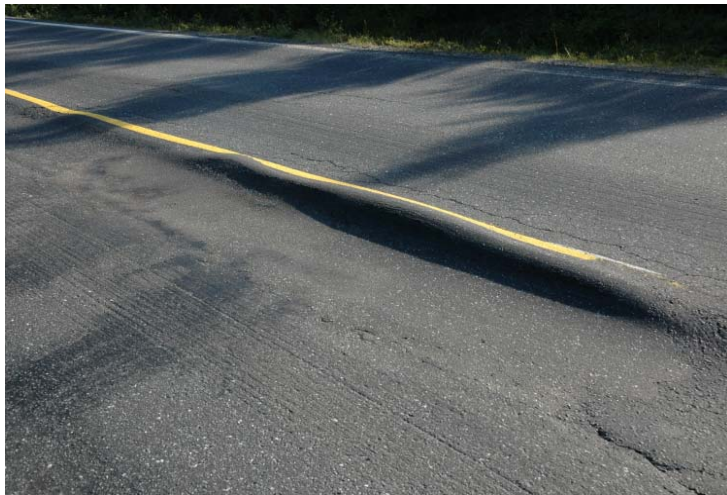
Figur 3.5 Eksempel på asfaltdeformasjon på E6 i Nordland (Foto: Inge Hoff)
