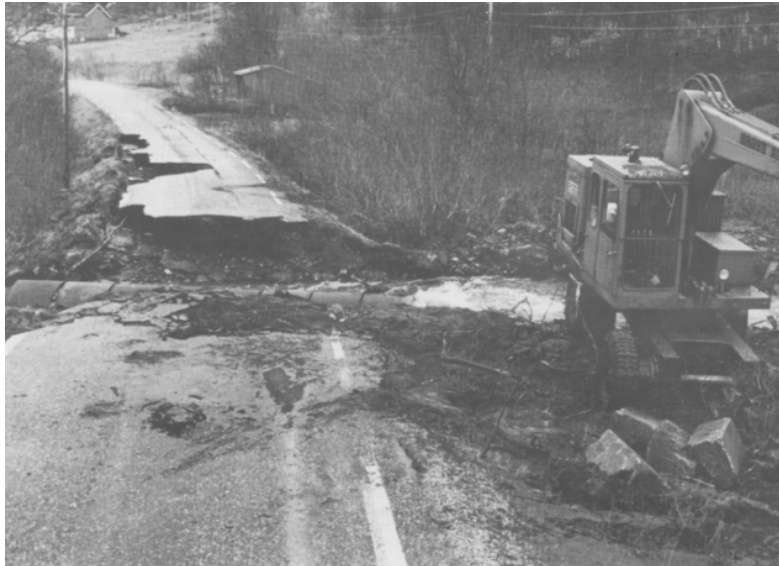
Figur 7.18 Konsekvensene av blokkert stikkrenne kan være store
