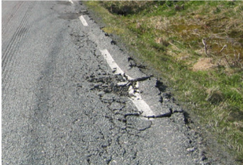
Figur 3.8 Typisk kantskade med deformert skulder (Foto fra Roadex.org)
