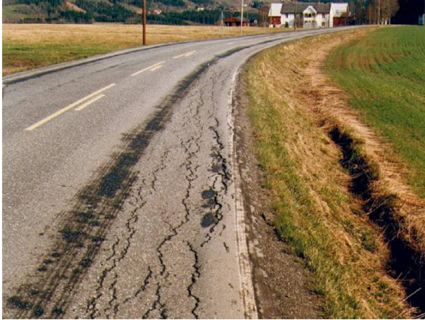
Figur 8.14 Nedkjørt vegkant; deformert skulder og langsgående oppsprekking (Foto: Jostein Aksnes)
