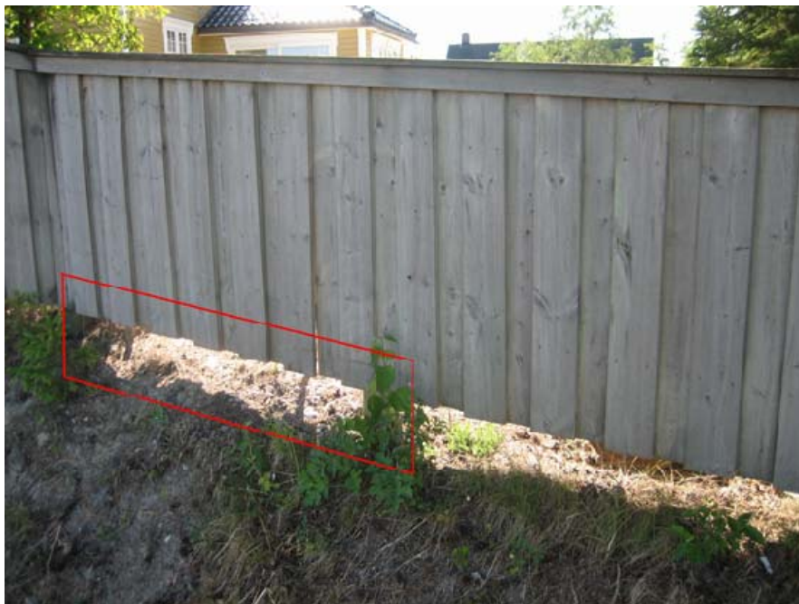
Figur 22.2 Støyskjermer skal være tette. Effekten av en støyskjermer med slike sprekker er liten og dermed kan det hende at skjermen ikke oppfyller støyregelevkrets krav. (Foto: Statens vegvesen)
