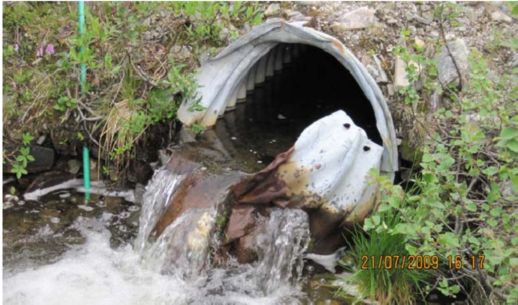
Figur 22.4 Skadet kulvert som kan hindre fiskevandring. (Foto: Statens vegvesen)
