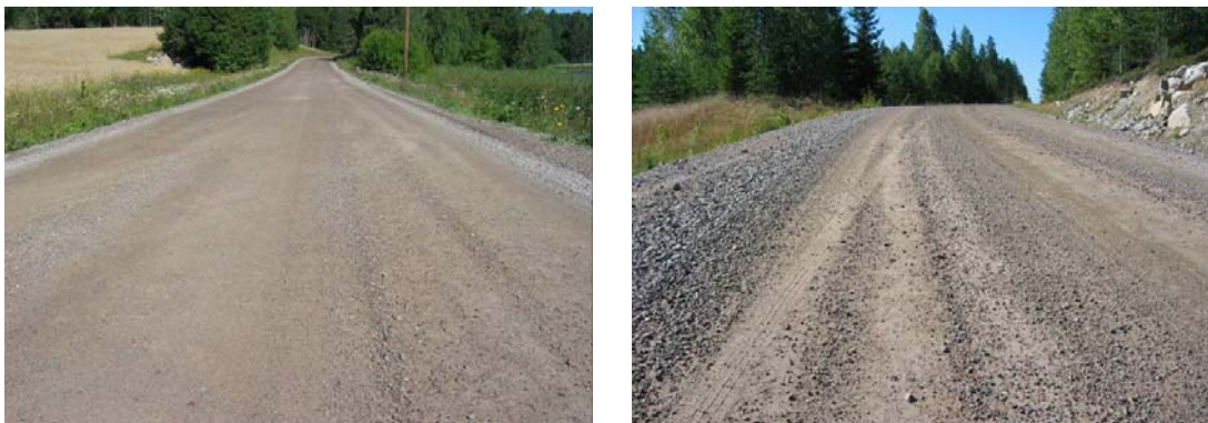
Figur 8.3 Løs grus. Til venstre alvorlighetsklasse 2, akseptabel tilstand. Til høyre alvorlighetsklasse 3, dvs behov for tiltak (Foto: Vägverket)
