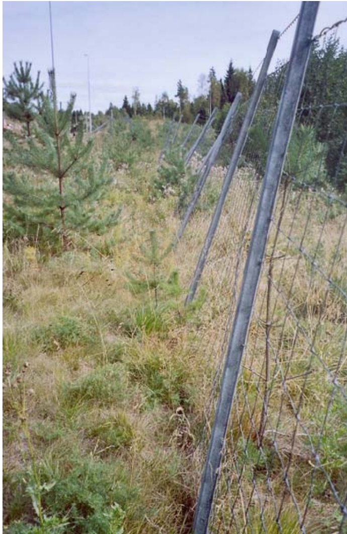
Figur 22.3 Viltgjerdet er i ferd med å brytes ned, sannsynligvis på grunn av en kombinasjon av mye snø og dårlig fundament. Dette kan på sikt gjøre det lettere for store dyr å forville seg inn på vegen. (Foto: Statens vegvesen)
