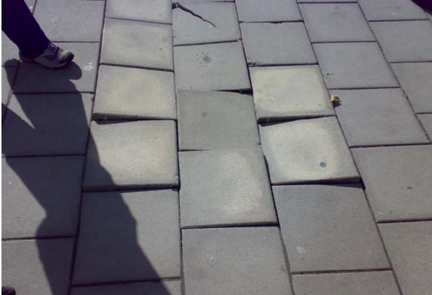
Figur 18.1 Fundamentet til betonghellene har sviktet på et område
