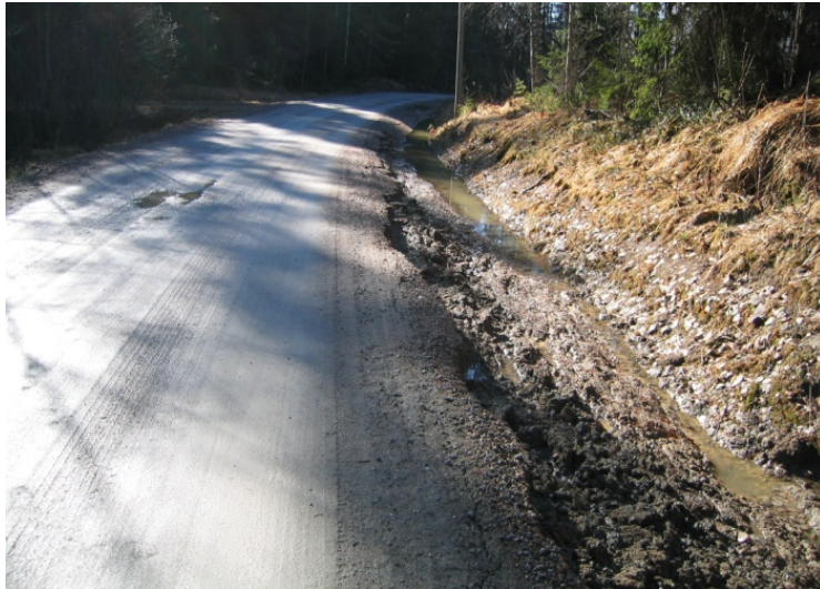
Figur 7.14 Dype sidegrøfter må renskes jevnlig for å opprettholde funksjonen (Foto: Geir Berntsen)
