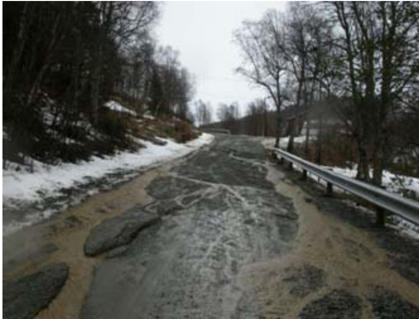
Figur 7.5 Regn og snøsmelting kan gi omfattende skader på et grusdekke
