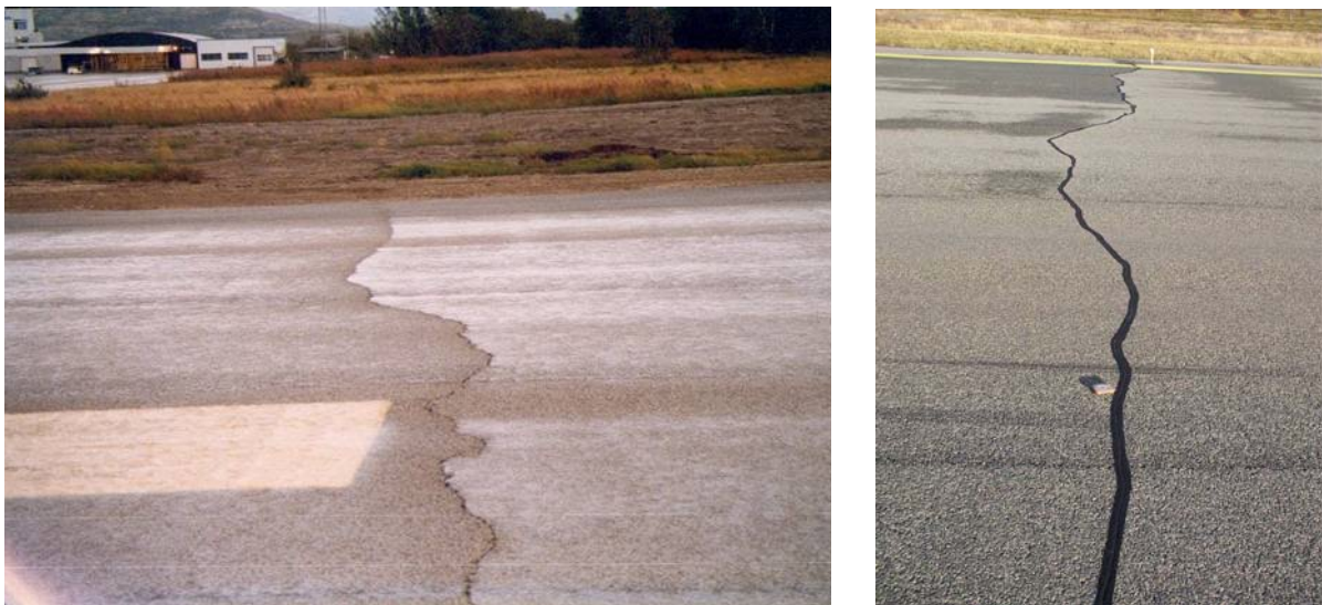
Figur 8.19 Lavtemperaturoppsprekking. Til venstre, åpen uttettet sprekk som gir fritt nedløp for vann. Til høyre, forseglet sprekk (Lakselv lufthavn, Banak). (Foto: Joralf Aurstad)
