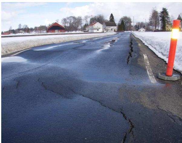
Figur 9.4 Selv om en veg er dimensjonert helt korrekt bæreevnemessig, så er vi avhengig av en frostteknisk vurdering for å sikre at vi får en veg med en tilfredsstillende tilstand
