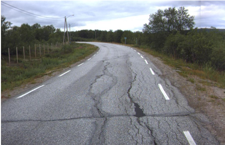
FIGUR 50 DEKKESKADER GRUNNET SVAKT VEGFUNDAMENT OG BEGYNNENDE UGLIDNING - RV 893 VED ØVRE NEIDEN I FINNMARK (FOTO: STATENS VEGVESEN)
