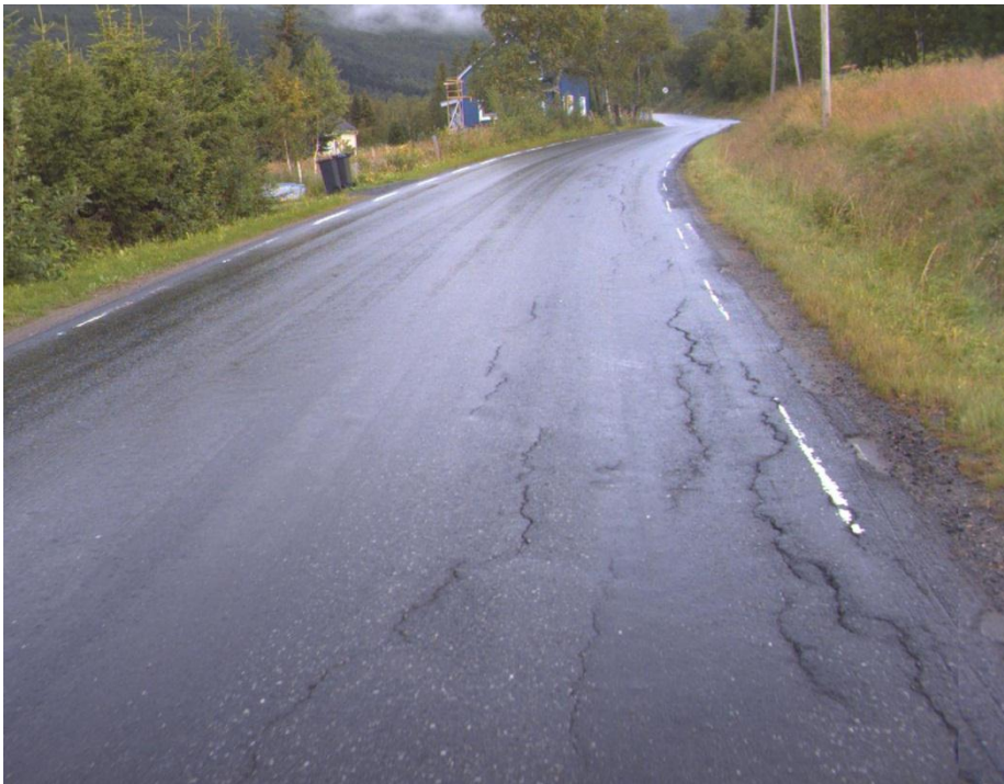
FIGUR 47 SKADET VEGDEKKE – E6 VED BJERKVIK I NORDLAND (FOTO: STATENS VEGVESEN)
