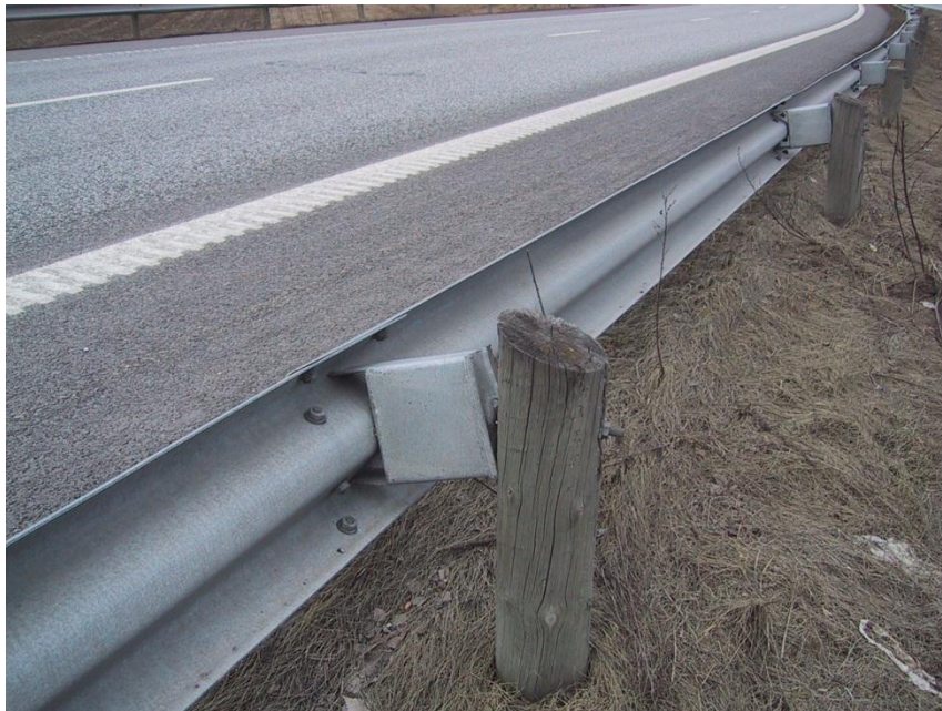
FIGUR 9 EKSEMPEL PÅ REKKVERK HVOR SKADENE HAR UTVIKLET SEG OVER TID (FOTO: STATENS VEGVESEN)
