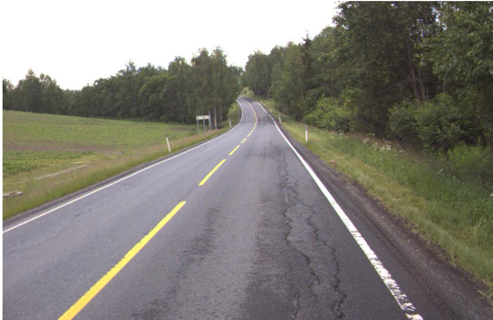
FIGUR 28 SKADET VEGDEKKE – RV 35 I BUSKERUD (FOTO: STATENS VEGVESEN)
