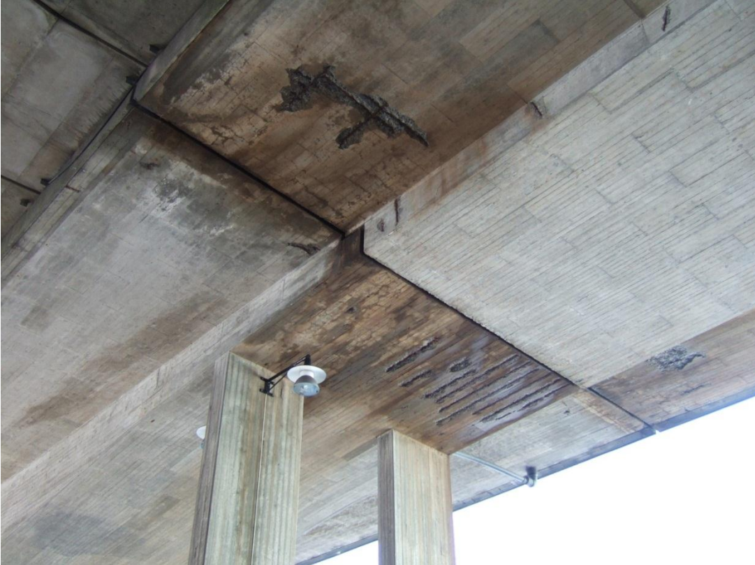
FIGUR 22 SALTSKADER PÅ BJØRNSVIK BRU - E18 (FOTO: STATENS VEGVESEN)
