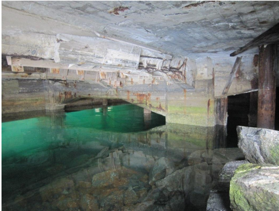
FIGUR 43 EKSEMPEL PÅ KLORIDSKADER – SJØGATA FERJEKAI I ÅLESUND –E 136 (FOTO: STATENS VEGVESEN)
