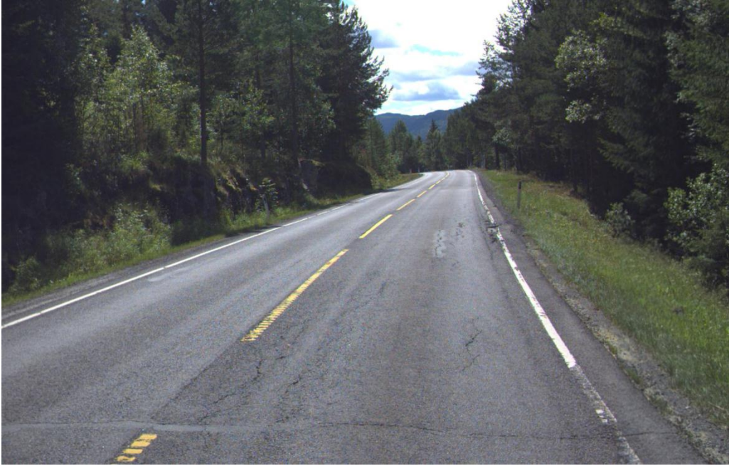
FIGUR 34 SKADET VEGDEKKE MED DYPE SPOR – E 16 (FOTO: STATENS VEGVESEN)
