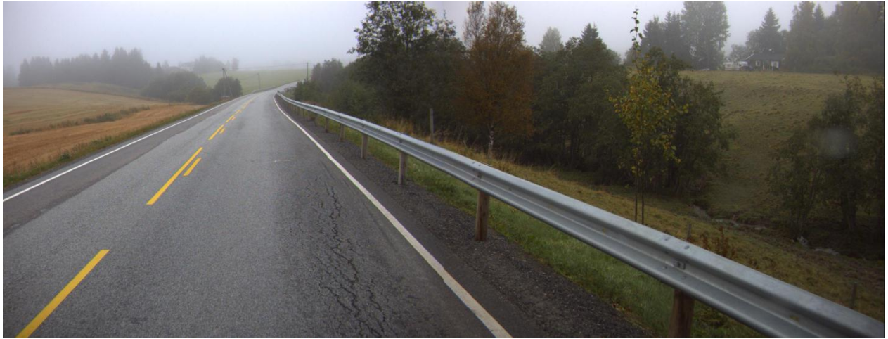
FIGUR 18 SKADET VEGDEKKE PÅ RV22 I ØSTFOLD (FOTO: STATENS VEGVESEN)
