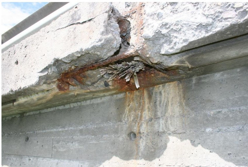
FIGUR 31 SKADE PÅ MUR – E134 I TELEMARK (FOTO: STATENS VEGVESEN)
