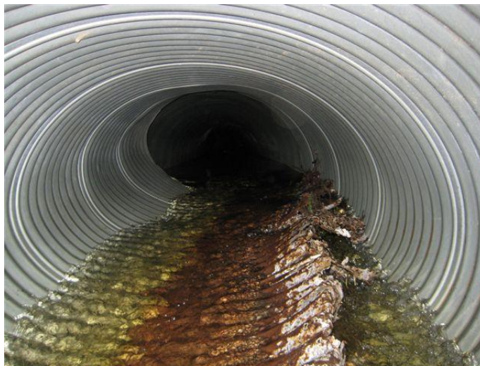
FIGUR 30 KORRODERT OG DEFORMERT STIKKRENNE – E134 I BUSKERUD (FOTO: STATENS VEGVESEN)
