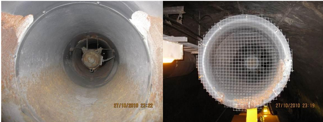
FIGUR 37 VIFTER UTEN ROTORBLAD I EIKEFETTUNNELEN PÅ EV39. DET ER MONTERT GITTERSKJERM FRAMFOR VIFTENE FOR Å HINDRE NEDFALL PÅ KJØRETØY I TUNNELEN (FOTO: STATENS VEGVESEN)
