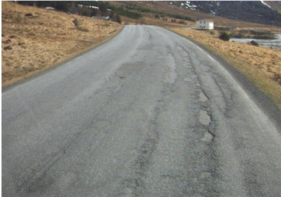
FIGUR 48 DEKKESKADER PÅ E10 (FOTO: STATENS VEGVESEN)
