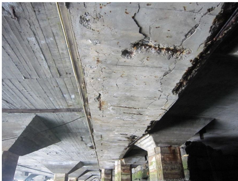
FIGUR 3 EKSEMPEL PÅ BETONGSKADER PÅ FERJEKAI (FOTO: STATENS VEGVESEN)
