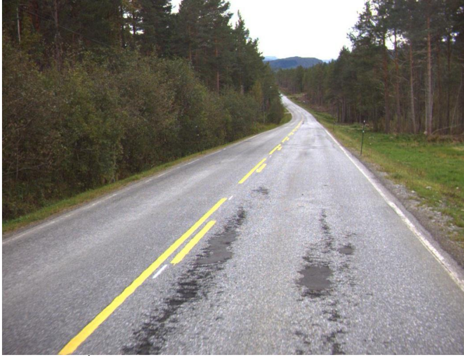
FIGUR 44 DEKKESKADER PÅ RV 70 MELLOM TINGVOLL OG SUNNDALSØRA (FOTO: STATENS VEGVESEN)
