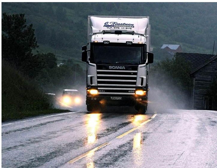
FIGUR 7 EKSEMPEL PÅ VANNFYLTE SPOR PÅ E6 I SOKNEDALEN I SØR-TRØNDELAG (FOTO: KNUT OPEIDE, STATENS VEGVESEN)
