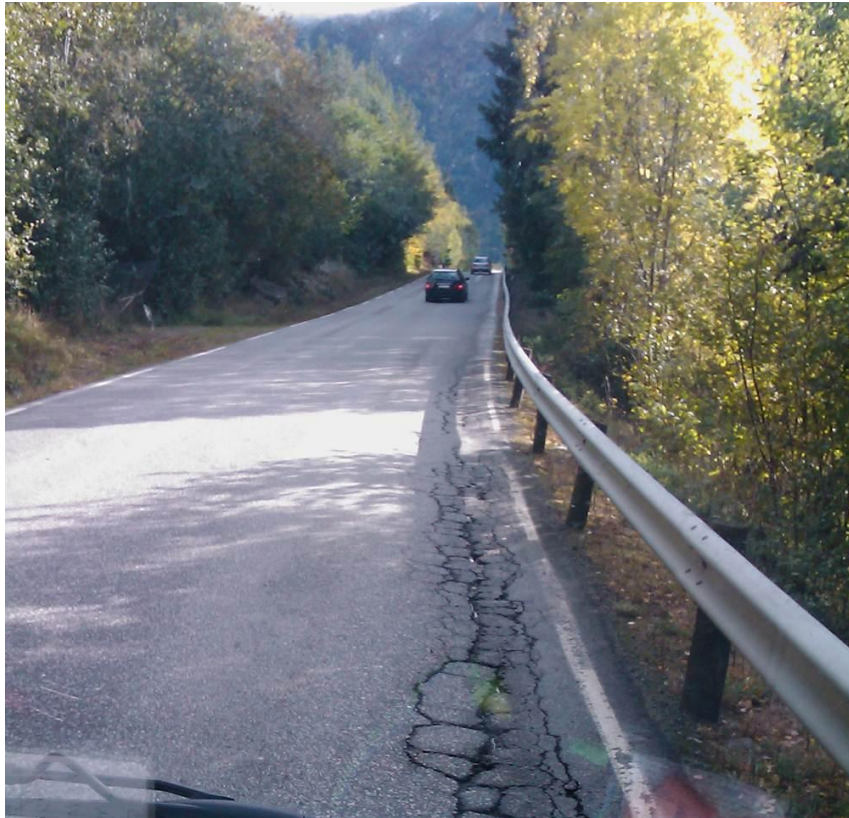
FIGUR 39 EKSEMPEL PÅ DÅRLIG VEGDEKKE/VEGFUNDAMENT PÅ RV 55 LEIKANGER – SOGDAL (FOTO: STATENS VEGVESEN)
