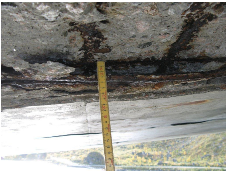
FIGUR 49 AVSKALLING AV BETONGOVERDEKNING GRUNNET ARMERINGSKORROSJON - SUNDKLAKKSTRAUMEN BRU PÅ E10 I LOFOTEN (FOTO: JAN MAGNUS ØSTVIK, STATENS VEGVESEN)
