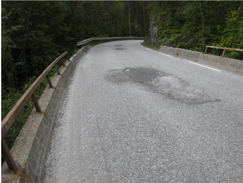
FIGUR 38 MYE DÅRLIG REKKVERK PÅ BRUER, HER PÅ EV 39 LAVIK - VADHEIM (FOTO: STATENS VEGVESEN)
