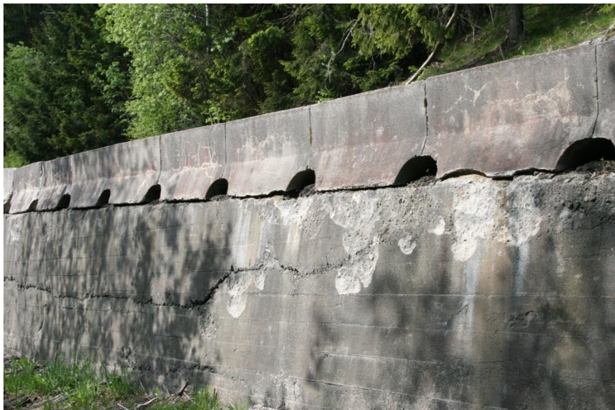
FIGUR 10 EKSEMPEL PÅ SKADET MUR (FOTO: STATENS VEGVESEN)
