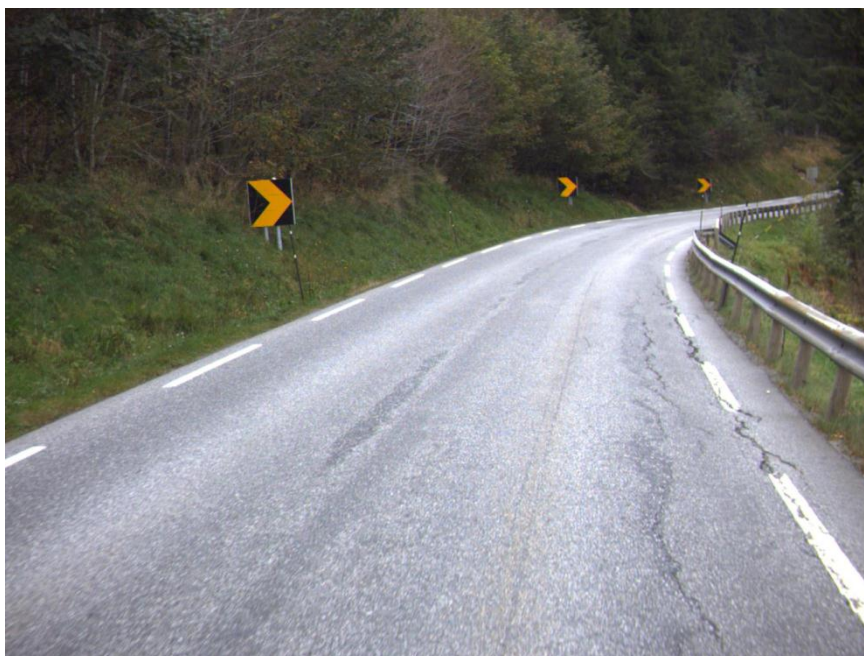
FIGUR 42 SKADET VEGDEKKE – E 39 NÆR ØRSTA (FOTO: STATENS VEGVESEN)
