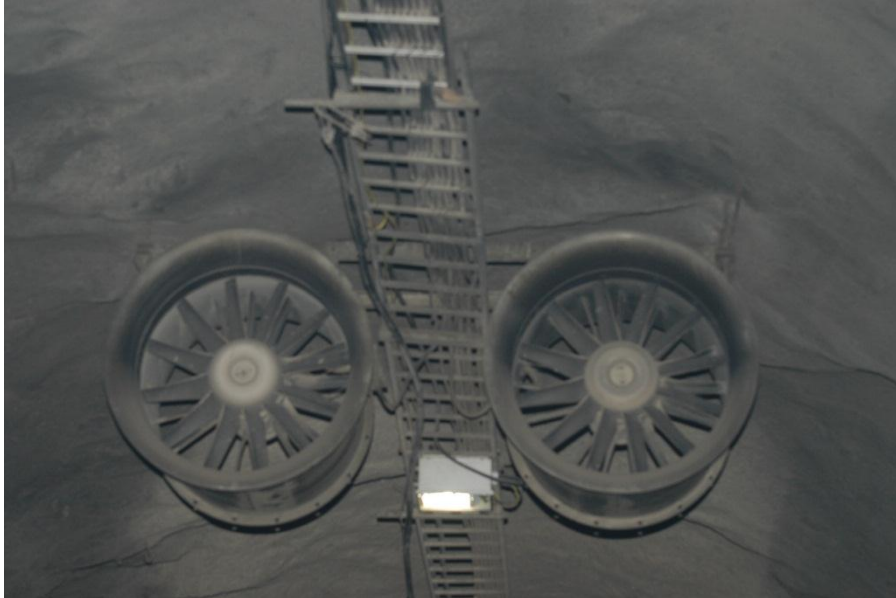
FIGUR 5 TUNNELVIFTER UTSATT FOR AGRESSIVT TUNNELKLIMA I VALLVIKTUNNELEN PÅ RV13 (FOTO: GEIR BREKKE, STATENS VEGVESEN)
