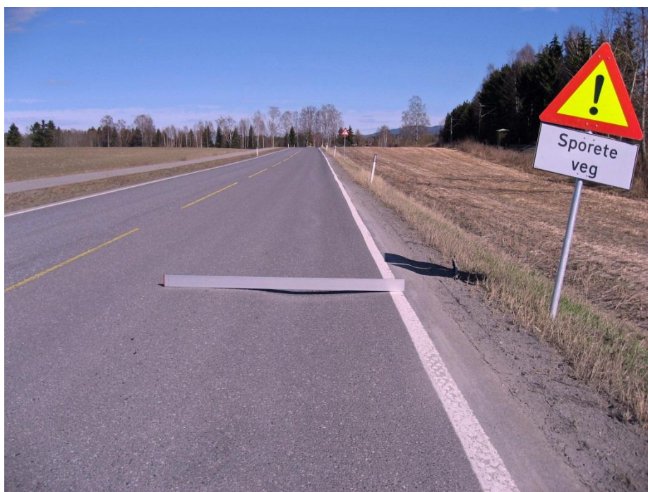
FIGUR 8 NOEN GANGER ER SPORDYBDEN SÅ STOR AT DET MÅ SKILTES – HER FRA RV35 VED HØNEFOSS (FOTO: TORLEIF HAUGØDEGÅRD, STATENS VEGVESEN)
