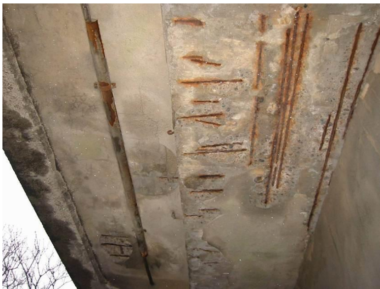
FIGUR 1 EKSEMPEL PÅ EKSPONERT OG KORRODERT ARMERING PÅ BETONGBRU (FOTO: STATENS VEGVESEN)
