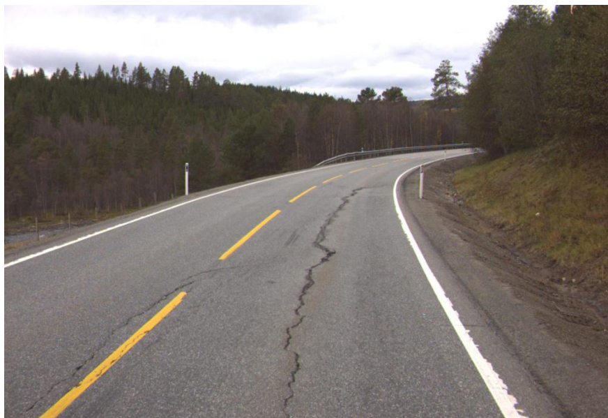
FIGUR 26 SKADET VEGDEKKE – RV 3 I HEDMARK (FOTO: STATENS VEGVESEN)
