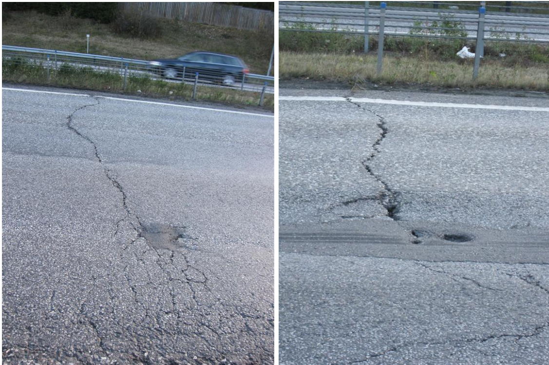
FIGUR 24 EKSEMPLER PÅ DEKKESKADER PÅ E6 VED GARDERMOEN I REGION ØST (FOTO: STATENS VEGVESEN)
