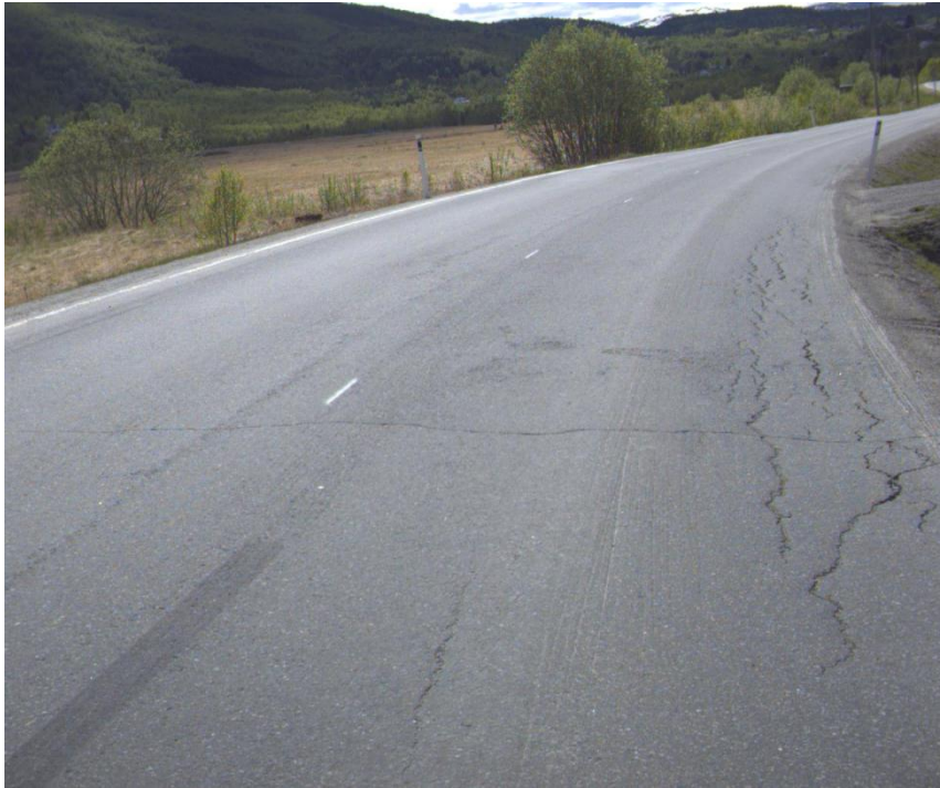
FIGUR 46 SKADET VEGDEKKE – E6 VED BALLANGEN I NORDLAND (FOTO: STATENS VEGVESEN)
