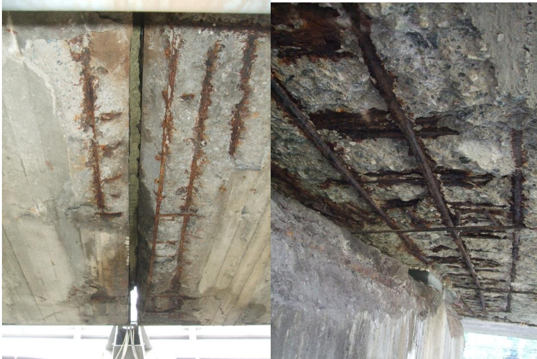
FIGUR 25 BETONGSKADER OG KORRODERT ARMERING – E6 ARTEID BRU (FOTO: STATENS VEGVESEN)
