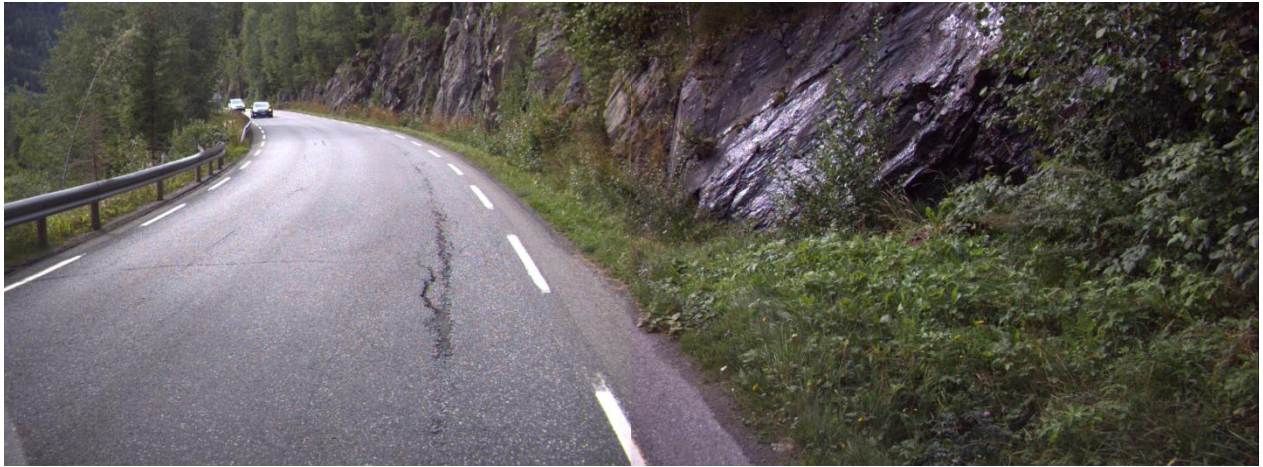
FIGUR 23 DEKKESKADER PÅ E16 VED BAGN (FOTO: STATENS VEGVESEN)
