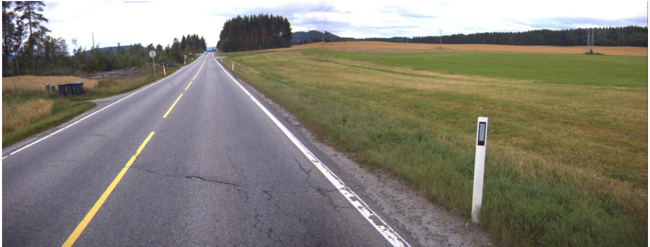
FIGUR 21 DEKKESKADER PÅ RV20 (FOTO: STATENS VEGVESEN)
