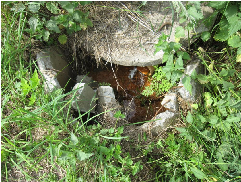
FIGUR 6 EKSEMPEL PÅ KNUST BETONGKUM (FOTO: STATENS VEGVESEN)
