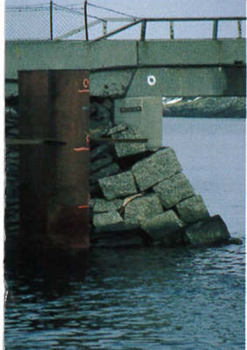
Steinane i eine karet på gamlebrua frå 1916 er i ferd med å siga ut i fjorden. Også elles er bru og fundament i elendig forfatning.
