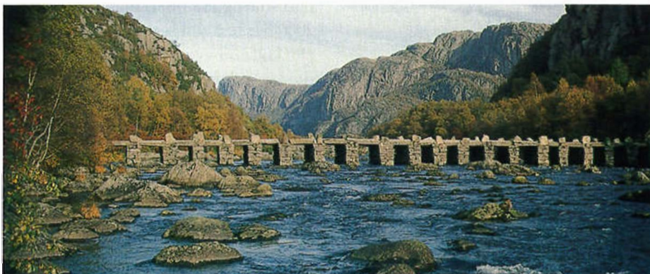
Terland klopp i Eigersund. Brua er mer enn 60 meter lang og har 21 lysåpninger.
