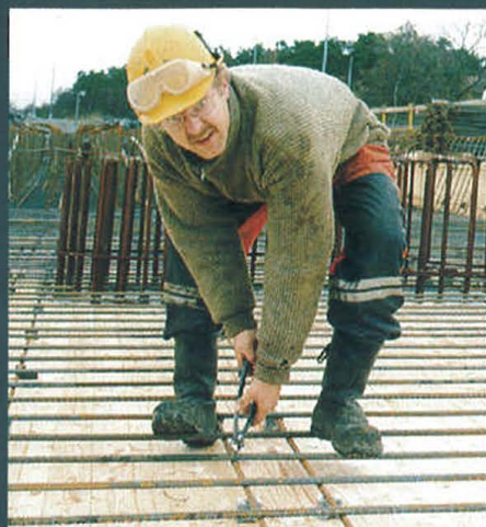
Det går med 153 tonn armeringsjern i brua. Her er Curt Lid på gang med binding av armeringsstengene.
