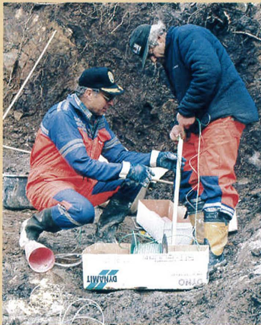
Bjarne Dybing (t.v) og Jan Hove i arbeid med dynamitt, fengheter og skyteledning. Her er det mange hol som skal ha den rette ladninga, før storsalven skal gå.
