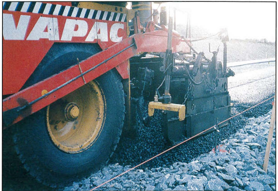
Asfaltering på den nye firefelts motorvegen, med bruk av ultralyd-teknikken. Ultralydsensoren er plassert i klaven over snora. Ved hjelp av sensoren blir asfalten lagt i konstant avstand til snora med millimeters nøyaktighet. Foto: Geir Strømstad
