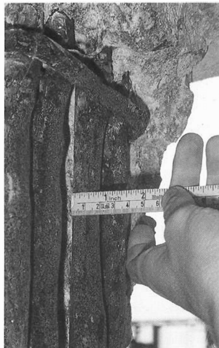
Underkant av brubjelke med ganske store saltskader. Armerings-diameteren som var 26 mm, er nå bare 20 mm.
