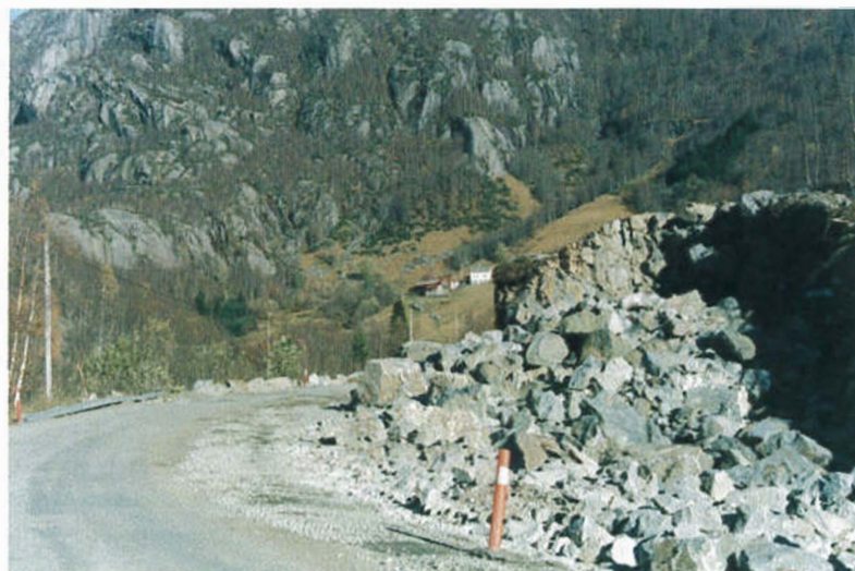
Frå Bratland, ca 2 km frå Hordaland grense. Arbeidet er kome langt på dei neste 2.6 km fram til fylkesgrensa, og den nye vegen skal vera ferdig til sommaren.
