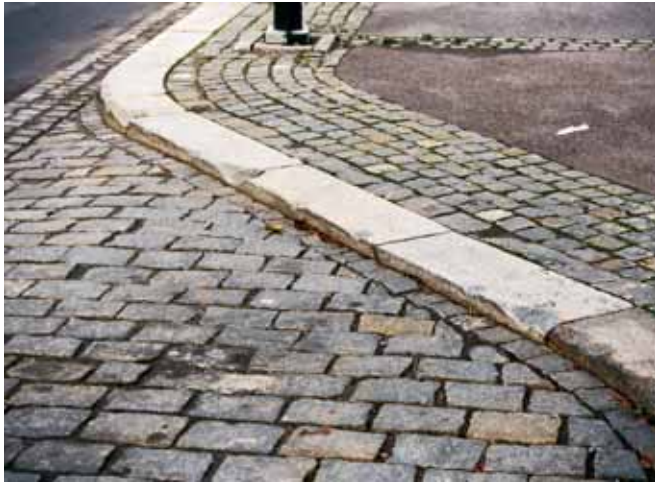
Brøyteskader på kantstein. Foto: Amund Vik
