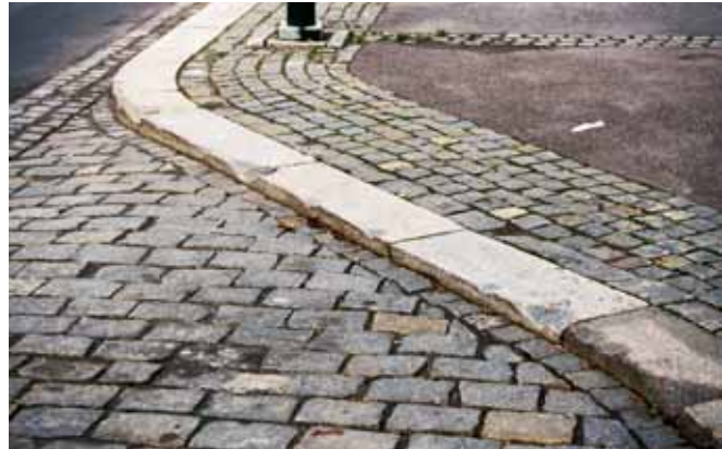
Brøyteskader på kantstein
