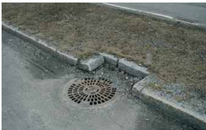
Prosjekterings- eller anleggsfeil?
