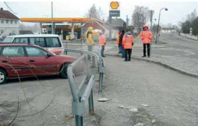
Skjeve lysmaster - og skader på gjerdene
