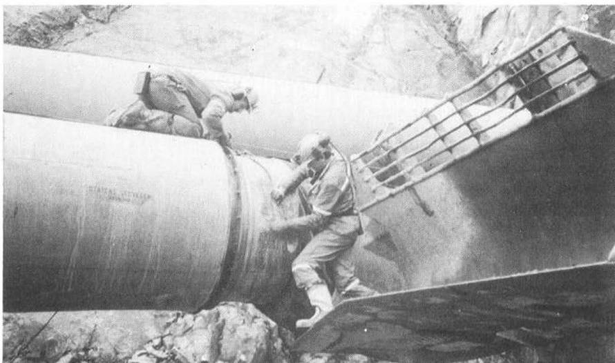
Reparasjon av tunnelduken. Rune Nerheim oppå duken, i skuffa står Magnus Welsin.
