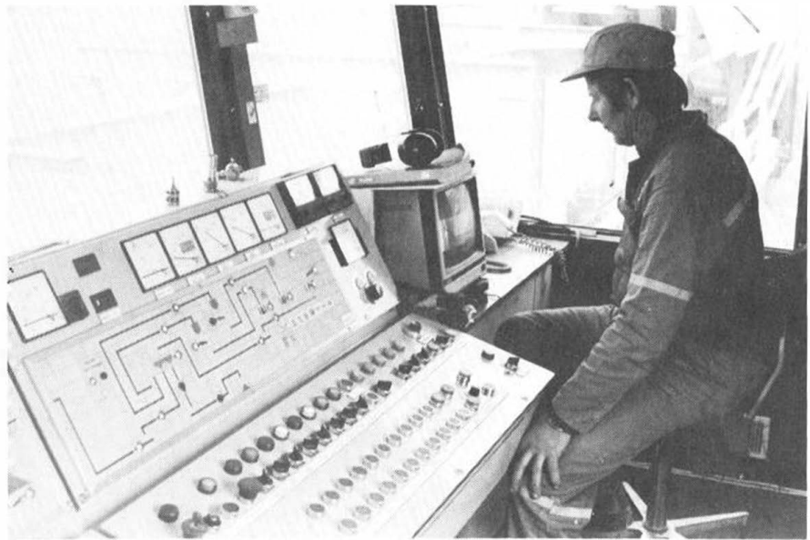
Her ser man John Vårvik inne i kontrollrommet på verket.
