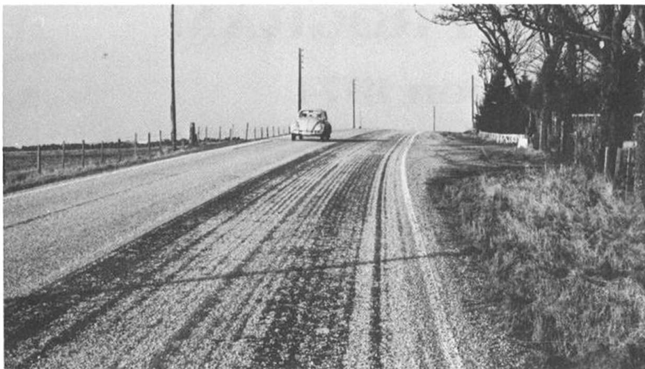
Bildet viser stripedannelse i overflatebehandlingen ved Reime på Rv. 44. Bildet er tatt tidlig i piggsesongen.
