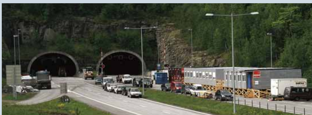
125 mann: Veidekke har nå 125 mann i jobb med tunnelutbedring på E18 i Vestfold. (Foto: Kjell Wold)
