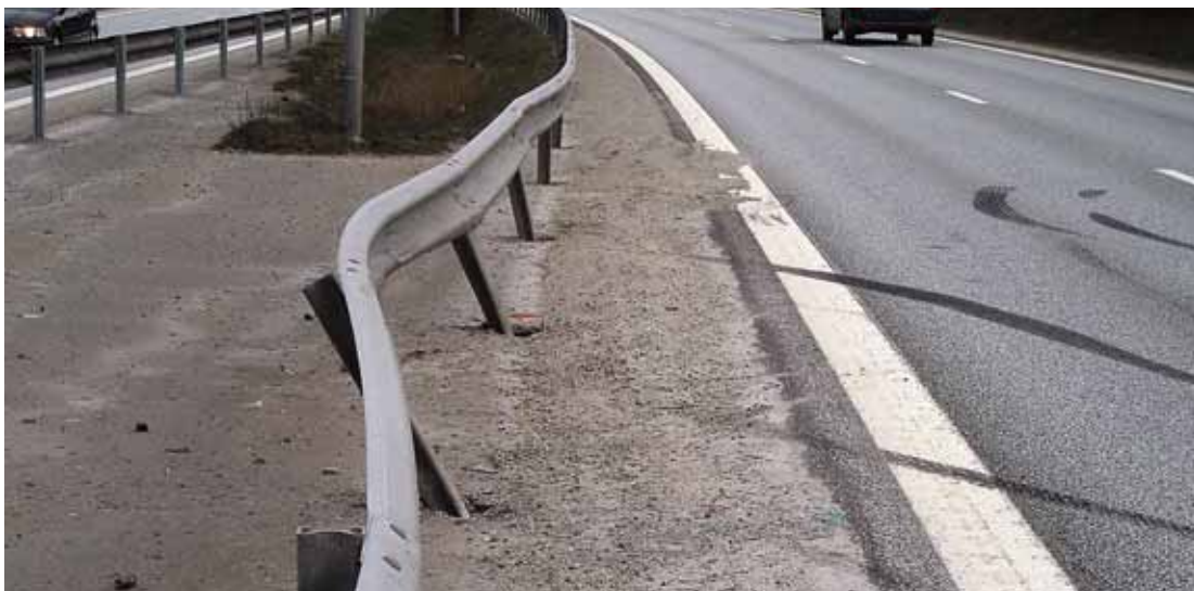
Rask effekt: Eit par dagar etter at midtrekkverket var ferdig køyrde ein bil inn i rekkverket, som dermed hindra det som kunne blitt ei alvorleg møteulykke. (Foto: Tor Oscar Walskaar)
