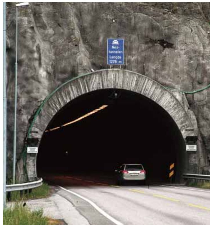
Må utbedres: E16 Nestunnelen i Hole i Buskerud. (Foto: Kjell Wold)
