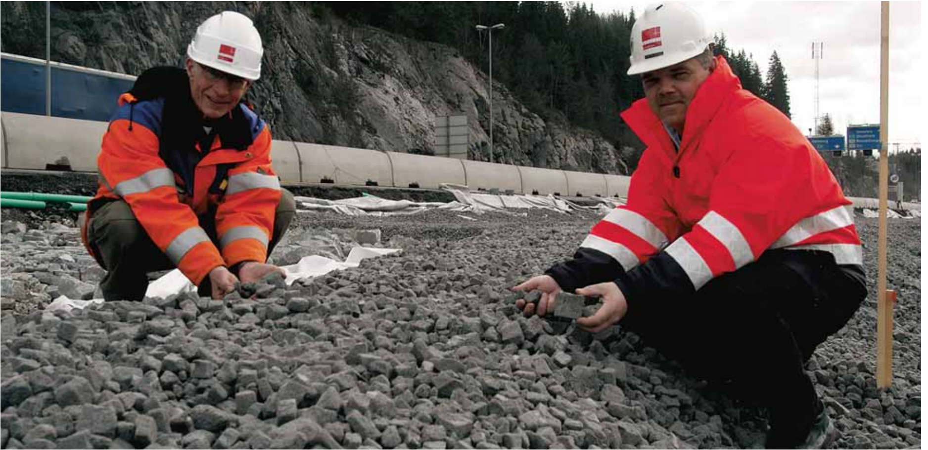
Resirkulert: - Et fint fyllmateriale, sier formann Torgeir Kaasa og anleggsleder Kjetil Rong. Om lag 6500 kubikkmeter omdannet glass brukes ved utvidelse av E6 og E18. (Foto: Håkon Aurlien)
