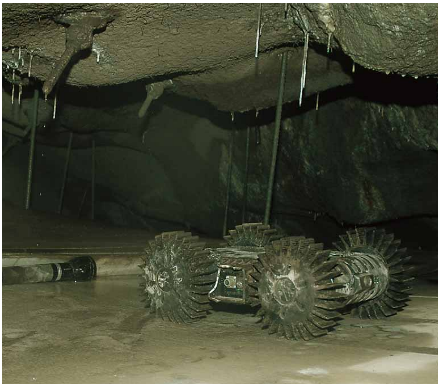
Tronge tilhøve: Det er ikkje mykje plass mellom tunnelkvelven og fjellet, men ein robot kan ta seg fram der menneske ikkje kjem til. (Foto: Macrowiss)
