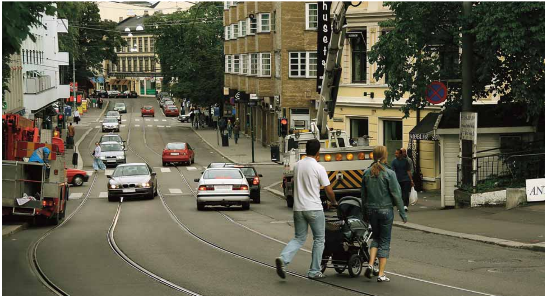
Fornyer Bogstadveien: Statens vegvesen starter neste år arbeidet med å pusse opp Bogstadveien, en av landets mest attraktive handlegater. (Foto: Finn Mellum, Norconsult)
