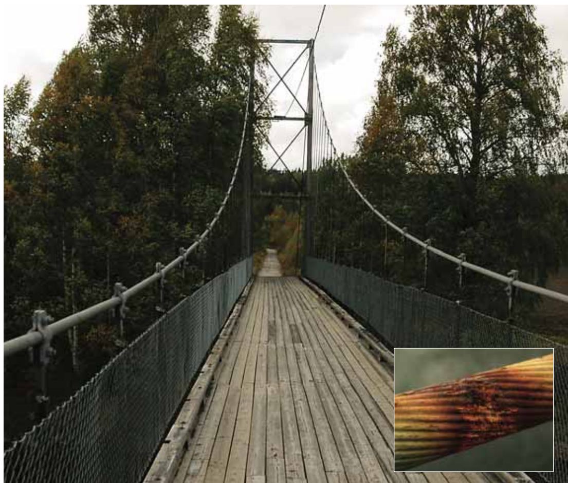
Oppdaget rust: En rustboble på en bærekabel sier mye om tilstanden til Glomstadfoss bru over Glomma syd for Rena. Ikke alle bruene åpne for trafikk er under oppsikt. (Foto: Håkon Aurlien)
