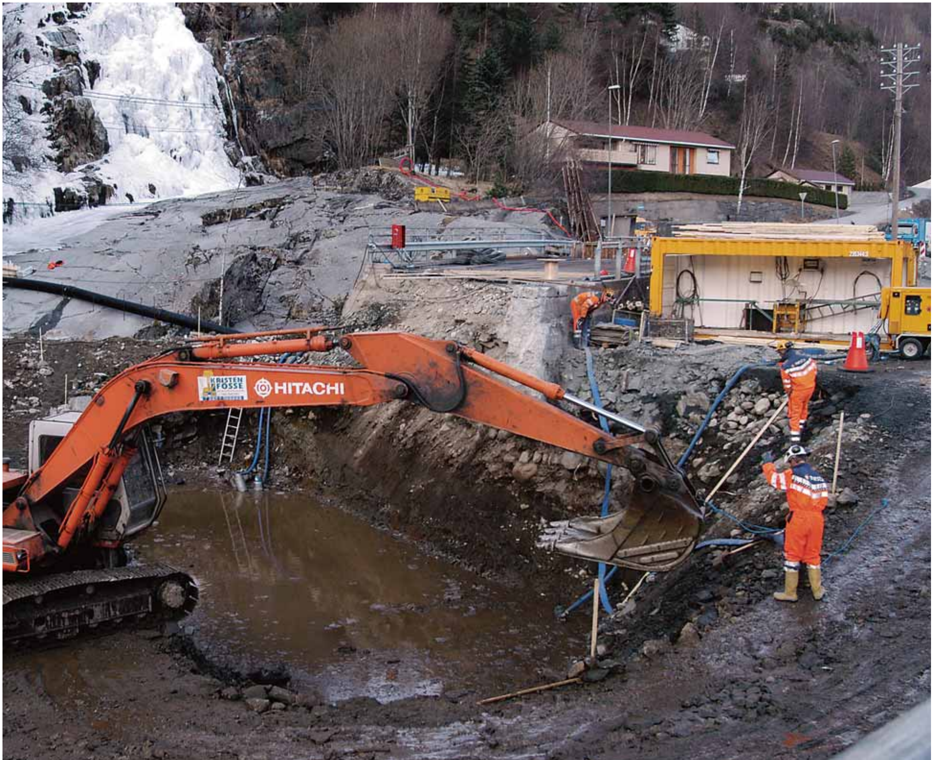
Flaumskadar: Klimaendringane gir auka flaumskadar på vegnettet, som då brua på rv. 55 over Fardalselvi i Sogndal blei øydelagt, og ny bru måtte byggjast i fjor. (Arkivfoto: Geir Brekke)
