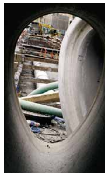
Kabelkaos: Statens vegvesen gjer og mykje arbeid for andre når dei grev: Det er tusenvis av kablar og røyr under bakken som skal frakte alt frå straum til vatn. (Foto: Snøball)
