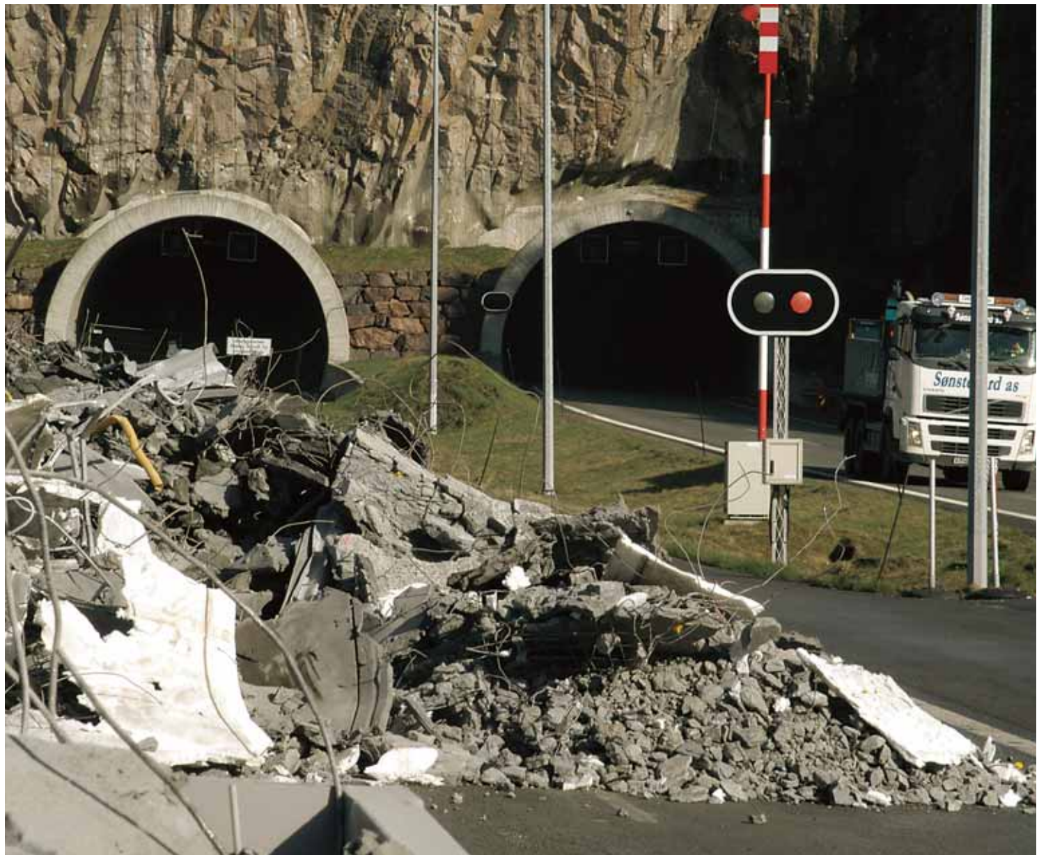
Utbedres: Entreprenøren Veidekke arbeider på høygir for å gjenåpne Hanekleivtunnelen. 1. juledag 2006 raste deler av tunneltaket ned i kjørebanelen, men ingen ble heldigvis skadet. (Foto: Kjell Wold)
