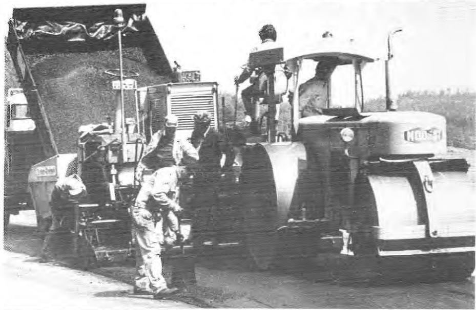
Bildet viser en asfaltgjeng i sving på E 18 ved Kaldvell i Lillesand.
