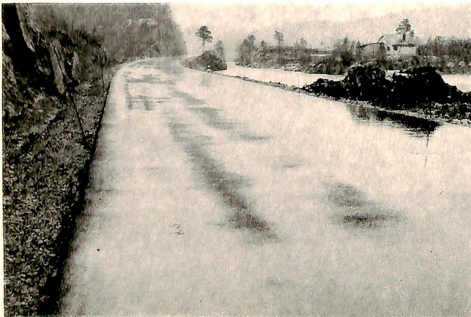
Fig. 1. De åpne, utette partier av et asfaltdekke får størst slitasje, og skader vil ofte oppstå hvis dekket ikke får forebyggende behandling i tide. Slike dårlige partier vil avsløres ved at de tørker opp meget langsommere enn omgivelsene etter regnvær, eller ved at de trekker vann under regnvær slik som de mørke partiene mellom hjulsporene på dette dekket.
