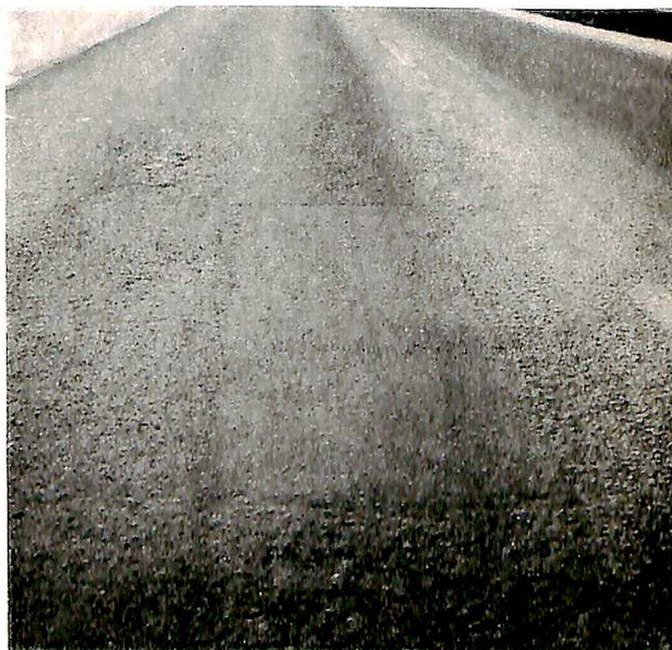
Fig. 3. Lappen midt på bildet har ligget på en meget sterkt trafikkert veg i en årrekke, og er faktisk i bedre forfatning enn det nærmeste parti av selve dekket. Bildet er eksempel på en utmerket permanent reparasjon, men et mangelfullt forebyggende vedlikehold.
