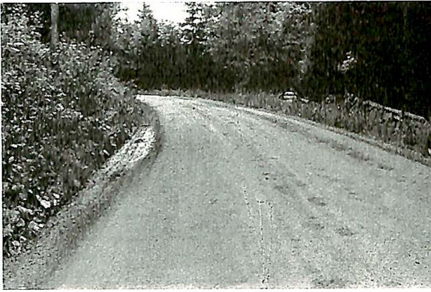
Fig. 2. Mangelfull grøtting på grusveg.
