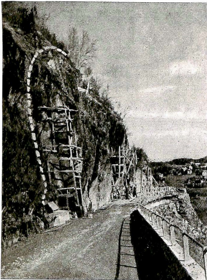
Fig. 3. Skjæringskant prikket med hvitt. Sett fra sør. Bruddsted og provisorisk bru til høyre.
