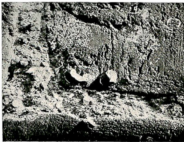
Fig. 3. Murverk av røde, håndstrøkne stein som 18 år etter oppmuringen viser skorpedannelser. På 3 steder er skorpen bulet ut og sprengt, men bruddstykkene er enno ikke falt ut.
