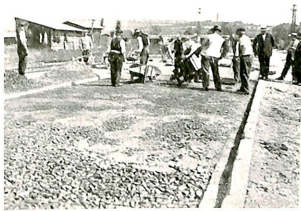
Fig. 2. Det ovste pukklaget er her nedvalsa. Sementmørtelen har sume stader blitt pressa upp til overflata. På andre stader blir overflata tetta med innkasting av sementmørtel. Til vern mot sola blir der so lagt over takkpapp. Når sementmørtelen har bunde, blir der lagt på eit lag sand, som skal haldast vát i herdningstida.
