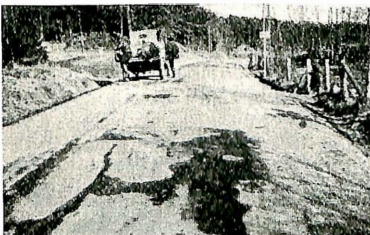
Fig. 3. Tjällskott, april 1933, på vägen Gustavsberg—Hemmesta, år 1932 tjärbehandlad grusväg, Värmdö vägdistrikt.
