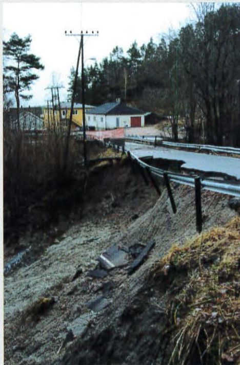
I Berger måtte dammen på innsiden av rasstedet tappes ned for å sikre maskiner og mannskap.
