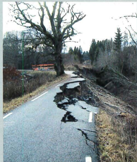
En av de første skadene som oppsto, var raset på fylkesveg 206 i Bamble. Vegen ble stengt for all trafikk før situasjonen var blitt så ille som bildet viser. Her skal vegtraseen legges inn på fast grunn til venstre for eiketreet, et prosjekt til 2 mill. kr, som også inkluderer tiltak for å berge eika. (Foto: Bjørn Kristoffer Dolva)
