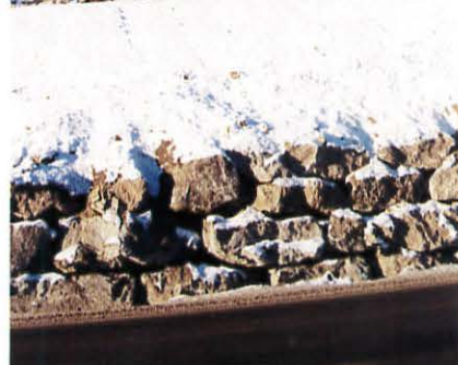
Den 100 meter lange fangvollen langs Rv 7 er ferdig, og vegen er lagt rundt tre meter lenger ut mot elva.
